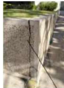
ESTADO ACTUAL DE MURO
