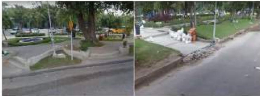
ESTADO ACTUAL DEL BORDILLO
