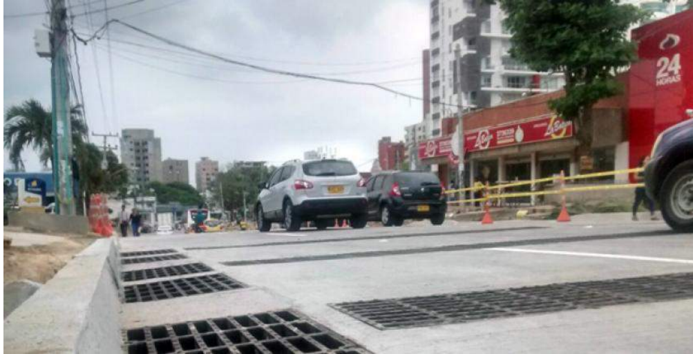
Foto 2. Calle 84 con el arroyo canalizado mediante boxculvert de concreto por debajo de la estructura de pavimento
