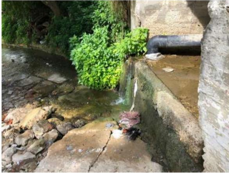
Emanación de agua Carrera 36 con Calle 81B.
