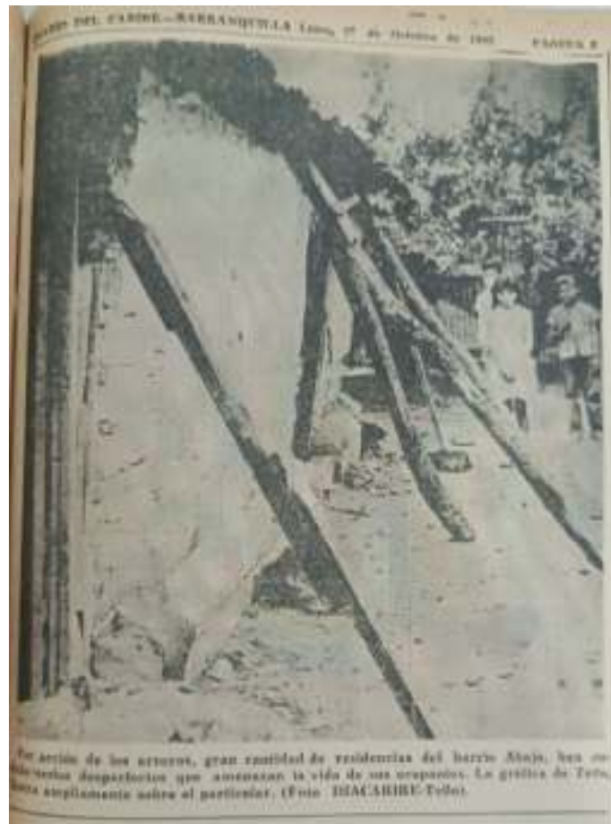
Figura 22. Foto de una casa popular de Barrio Abajo en condiciones de deterioro.
