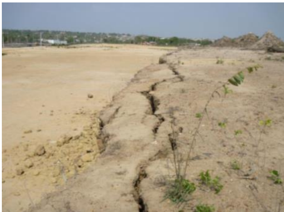
Imagen 08. Grietas generadas en el corte realizado a los niveles de arcillolitas de la formación Perdices.
