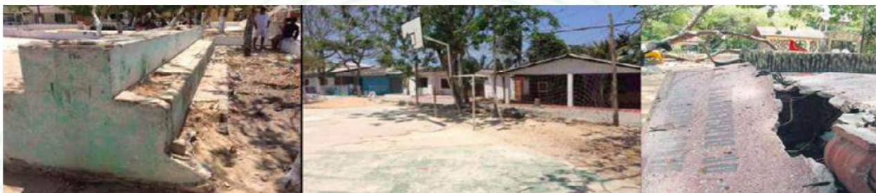
Ilustración 5. Estado de los parques y canchas previo a su intervención.
