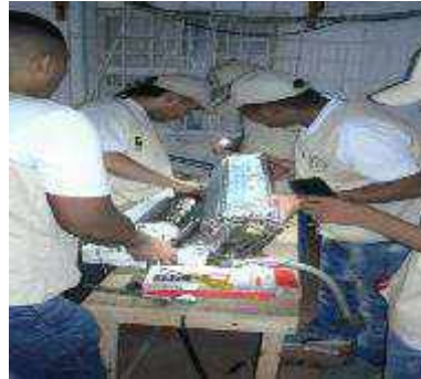
Evidencia de la actividad de trabajo práctico. Programa de Mantenimiento de Aires
