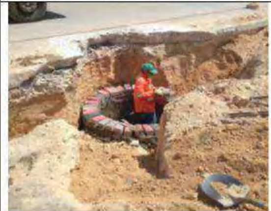
construcción de bordillo, sumideros, registros, excavación para tuberías y banco de ductos, reparación de placas fisuradas y corte y sellado de juntas.
