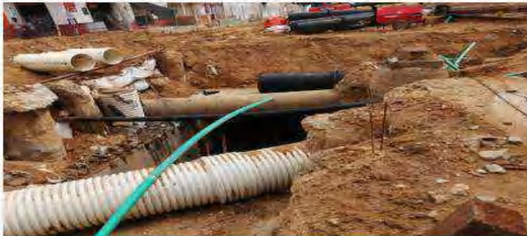
Esta es la única losa superior del box que falta. Se debe hacer el cambio del tubo de agua potable para poder construirlo. Carrera 33 calle 56
