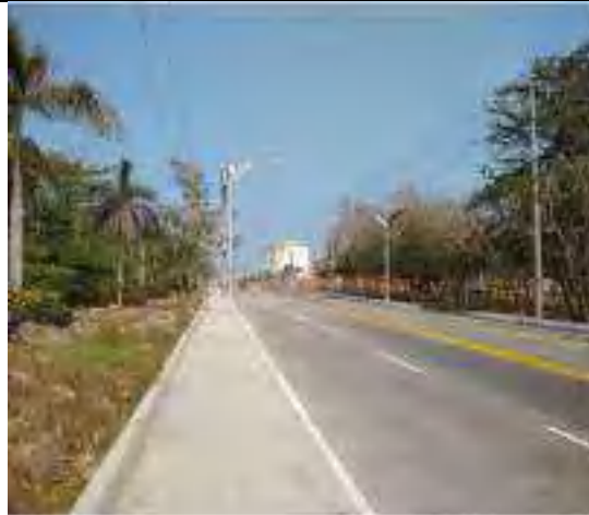
MEJORAMIENTO Y/O PAVIMENTACIÓN DE LA VÍA 40 ENTRE CALLE 85 Y CALLE 110 Y MODERNIZACIÓN DEL ALUMBRADO PÚBLICO EN EL DISTRITO DE BARRANQUILLA.
