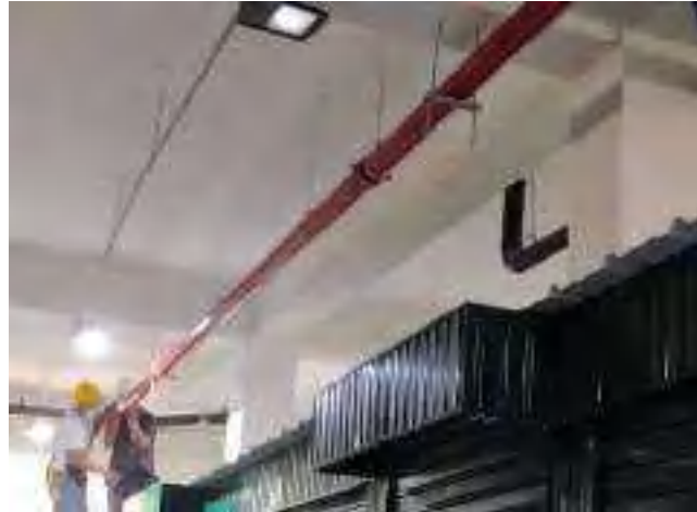
Red contra incendios
