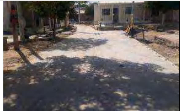
ilustración 2. Preparación con material seleccionado para instalación de concreto de andén en calle 17c entre 7a y 6c.
