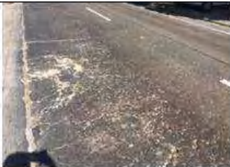
Pavimento deteriorado en calle 79 entre 60 y 59.
