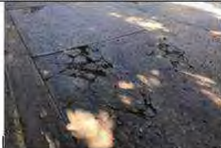
Pavimento deteriorado en calle 79 con carrera 55.
