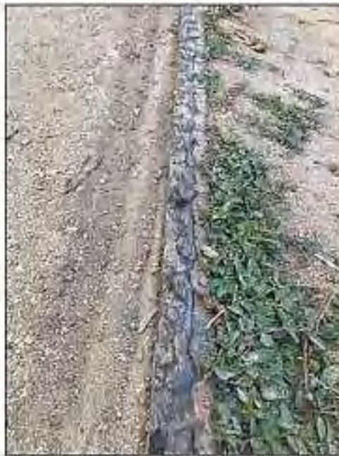
Figura 1 Riel con soldadura mal estado
