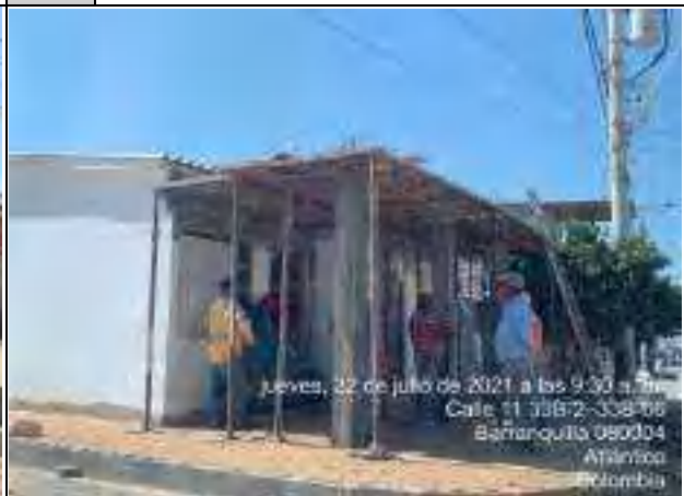
FOTO 4 CONSTRUCCION DE LOSA SUPERIOR O PLAFON EN PREDIO DE LA CALLE 11 #33B
