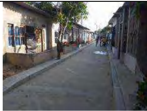
Acabado final de pavimento y urbanismo en barrio Por fin Carrera 21F entre 83b y 84
