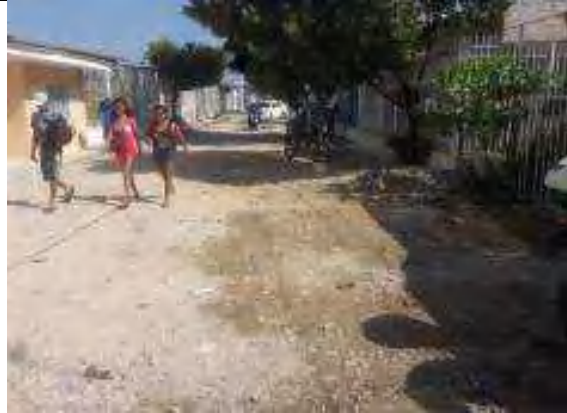
Diagnóstico Tramo Siete de abril Calle 50B entre Carrera 2 Sur – Carrera 4 Sur
