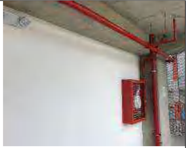
Tubería del SCI
