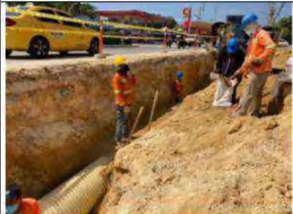
construcción de bordillo, sumideros, registros, excavación para tuberías y banco de ductos, reparación de placas fisuradas y corte y sellado de juntas.
