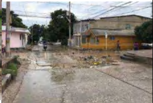
ilustración 10 Estado inicial de carrera 54 con calle 13
