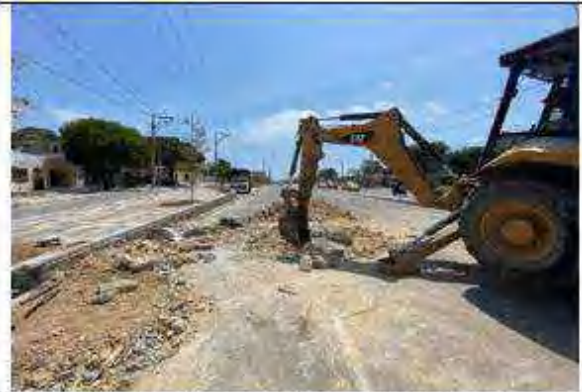
Demolición de pavimento para nuevo sumidero de aguas entre calles 74A y 75B, acera norte
