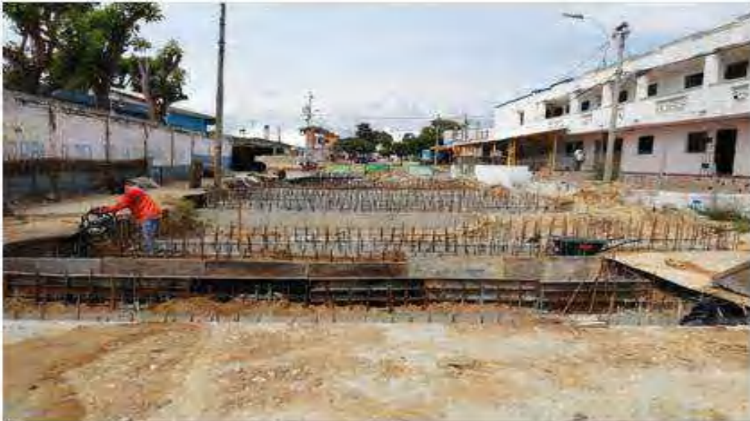
Sumideros para captación del arroyo en calle 56 con carrera 27.
