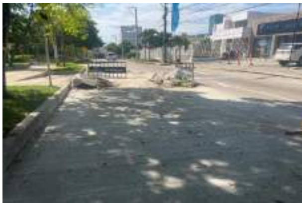
Imagen 25. Pavimento en concreto rígido. Calle 79 con carrera 59.
