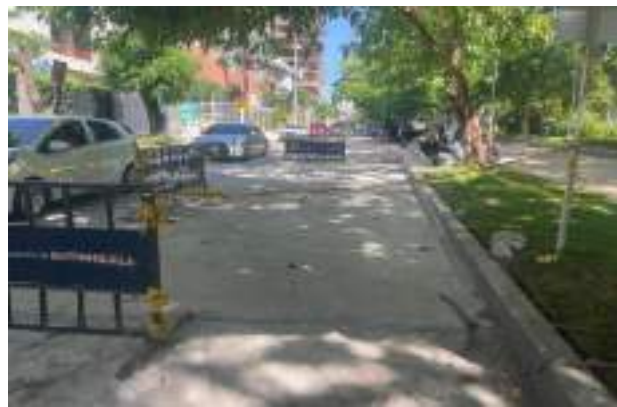
Imagen 26. Pavimento en concreto rígido. Calle 79 con carrera 59.
