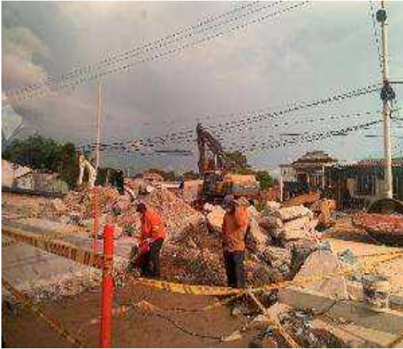
Intervención del tramo II en la calzada sur de la Av. Cordialidad entre Calle 72 y Carrera 5E. Vista al sur
