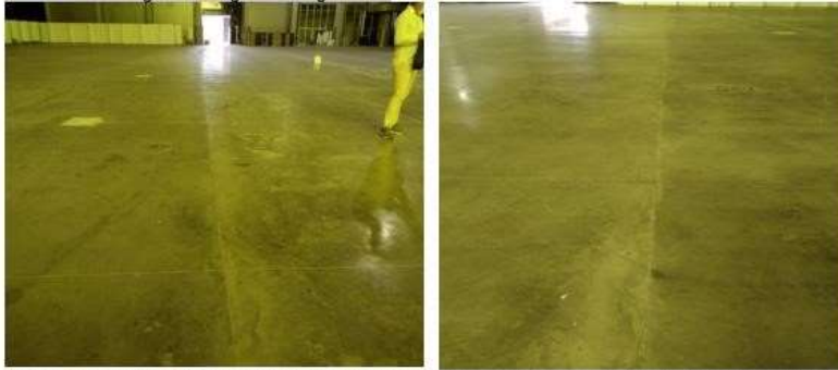
En esta vista general se puede observar losas en concreto esmaltado, no se les hizo el corte ni sellado de juntas de dilatación. Otra foto donde se observa el mismo detalle del anterior en las paletas de concreto esmaltado.
