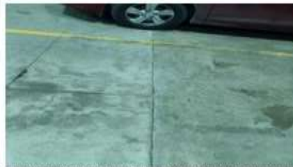
En esta foto se observa el desportillamiento que se viene presentando entre las juntas de las placas de concreto en el área de estacionamiento.
