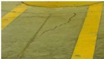
Otra foto donde se presenta agrietamiento de las placas en concreto, cerca de las columnas del área de parqueadero, con separación de 5mm y en proceso continuo de agrietarse.
