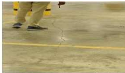
En esta vista se aprecia otra grieta con separación de 3 a 5 mm en las placas de concreto pulido área del estacionamiento.
