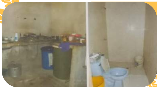
Estado al interior de una vivienda en el barrio Los Rosales sin intervenir
