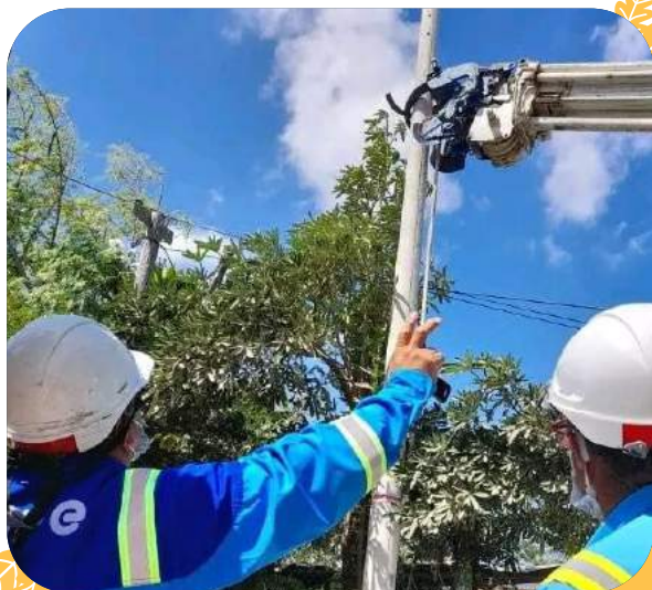
TRABAJO DE NORMALIZACIÓN DE REDES ELÉCTRICAS PARA LOS ANGELES I Y EL GOLFO. FOTO FACILITADA POR MONICA DIAZ
