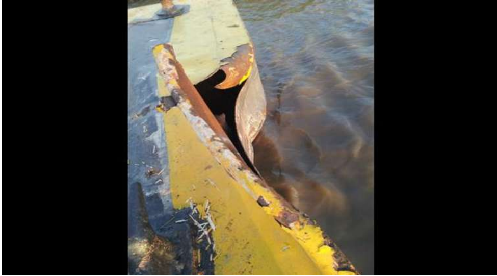
imagen 16 Barcaza colisionada con base del Puente Pumarejo
