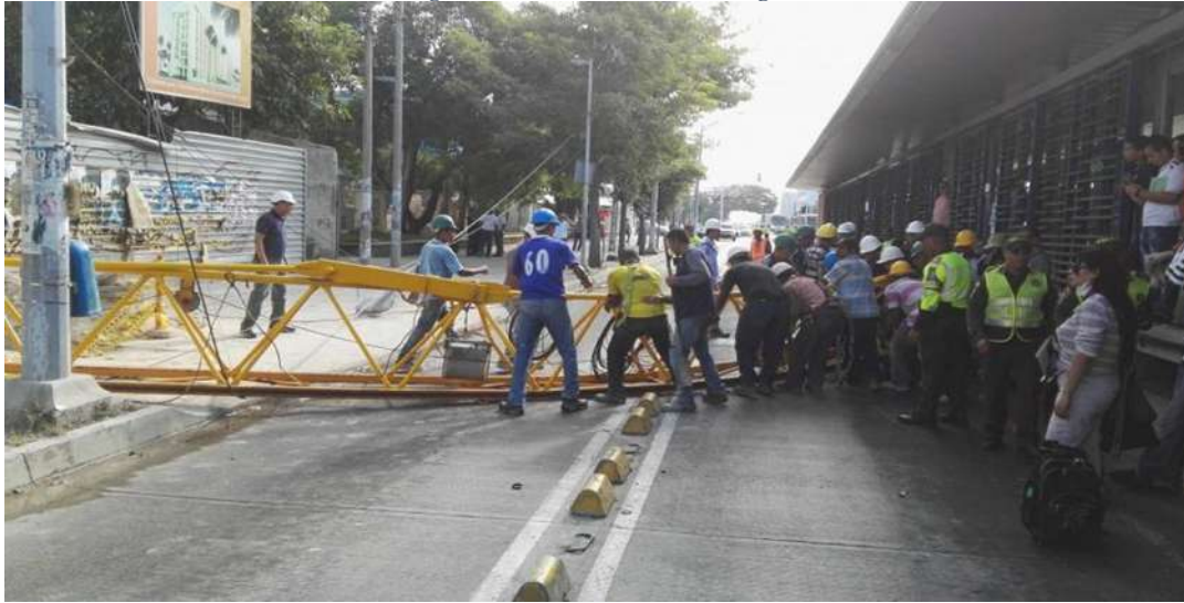
imagen 6 Caída de brazo de torre-grúa
