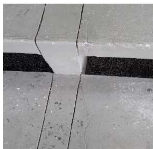
Fotografía N° 545. Gradería agrietada o fisurada
