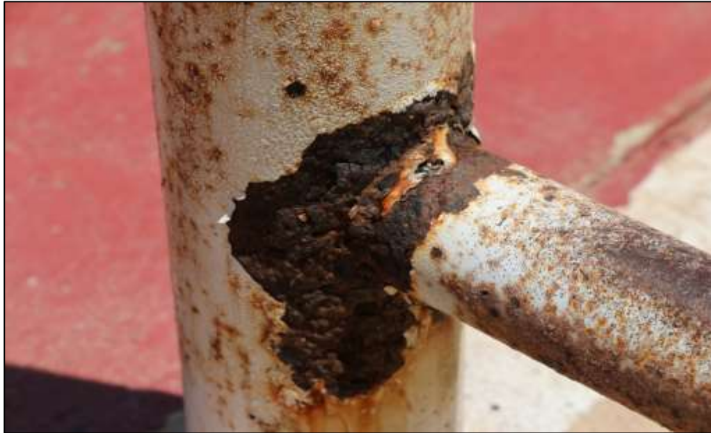
Fotografía 416 Detalle de la unión entre elementos metálicos, de una de las canchas deportivas instaladas en este escenario. Estos elementos evidenciaron oxidación profunda generalizada, pérdida parcial de la pintura de acabado (en algunas zonas por presencia de ampollas) y en algunas secciones, corrosión.
