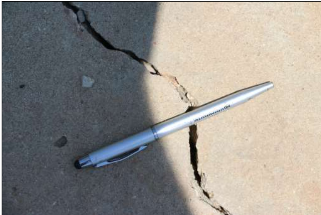
Fotografía 386 Detalle de una grieta, registrada en una sección de andén. Según la escala utilizada en la imagen (esfero de ancho 10 mm), la abertura de la lesión es aproximadamente de 10 mm.
