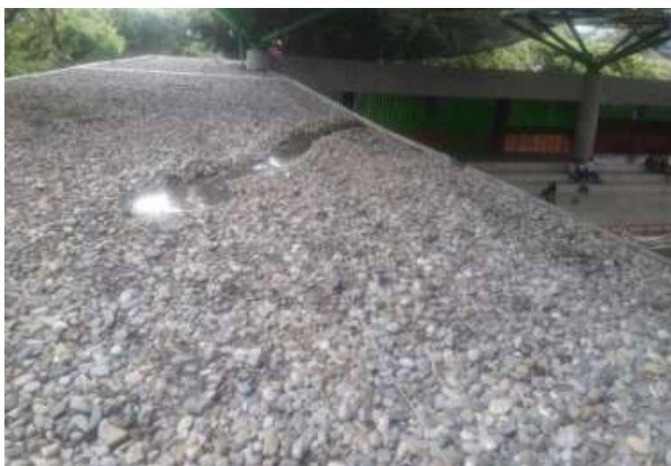
Fotografía N° 558. Empozamiento del agua en la cubierta
