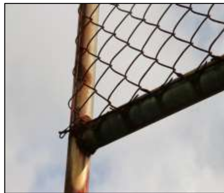
Fotografía 263. Detalle del encuentro de dos elementos metálicos, que componen la malla de contención de este escenario (malla ubicada en el costado sur). En esta obra, se evidenció oxidación excesiva de los elementos metálicos (tubería y malla eslabonada).
