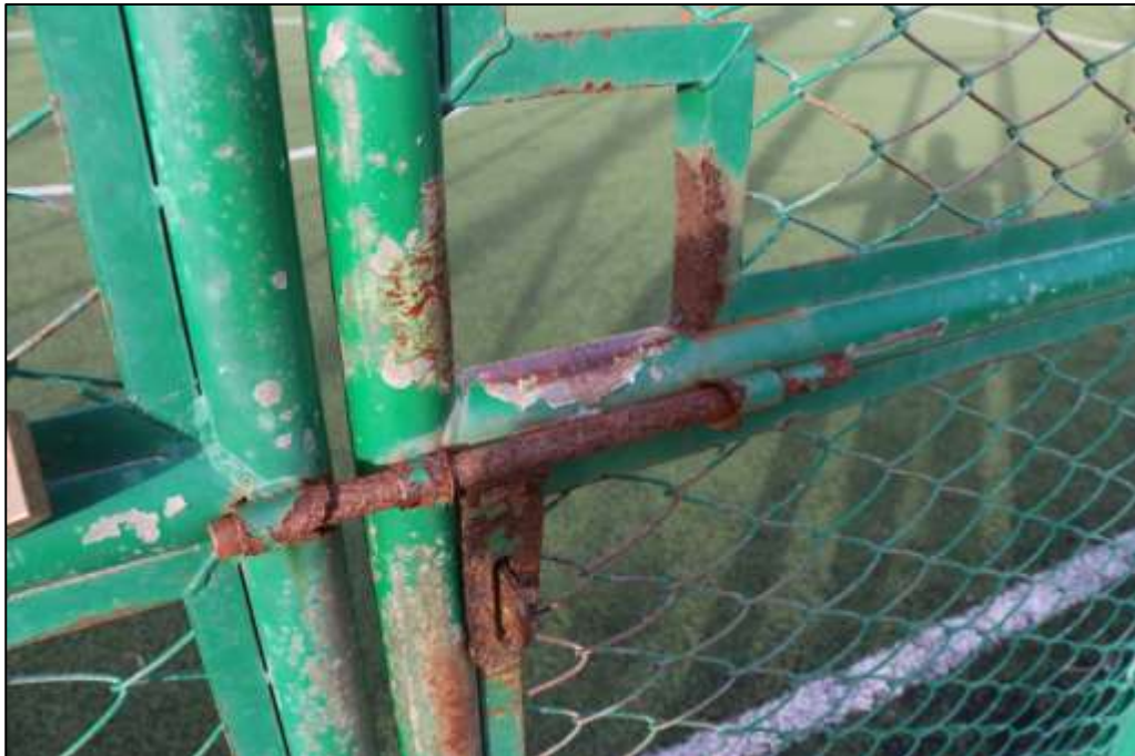
Fotografía 348 Detalle del herraje de la puerta de acceso a la cancha de fútbol sintético. En este sitio y como se evidencia en la imagen, los elementos metálicos evidencian oxidación profunda y en algunas secciones, corrosión parcial.
