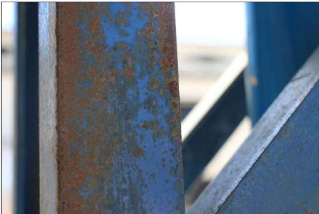
Fotografía 174. Detalle de uno de los elementos metálicos, de una de las columnas tipo celosía, construida como parte de la estructura de la cubierta, en el polideportivo adecuado. En diferentes secciones de estos elementos metálicos, se evidenció oxidación diferencial.
