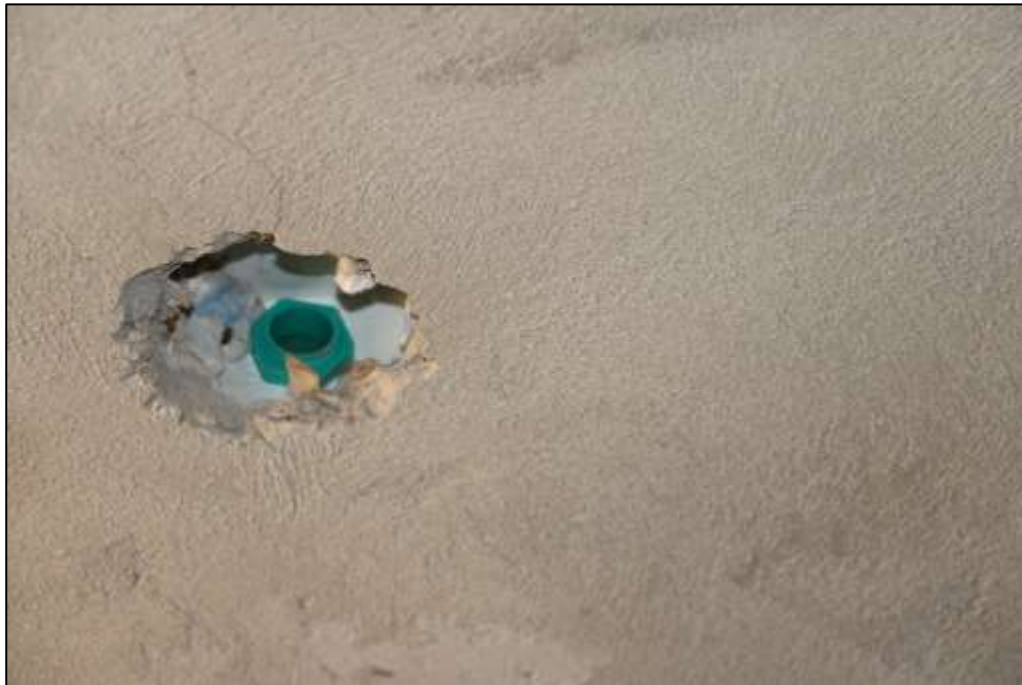
Fotografía 407 Detalle de una salida eléctrica, adecuada en uno de los camerinos ubicados bajo estas graderías. Se evidenció falta del aplique final de esta salida eléctrica.
