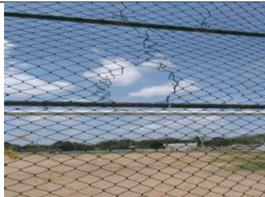
Fotografía 37 Malla rota detrás de porterías
