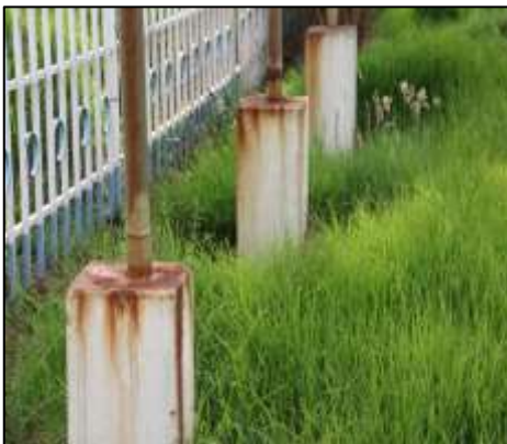
Fotografía 264. Vista general de algunos de los dados de concreto, que hacen parte de la cimentación de la malla de contención, sobre el costado sur. En estos elementos, se evidenció manchado diferencial de óxido, producto del material de óxido que ha escurrido de la estructura metálica de la malla. De esta manera, se evidencia la magnitud del fenómeno.
