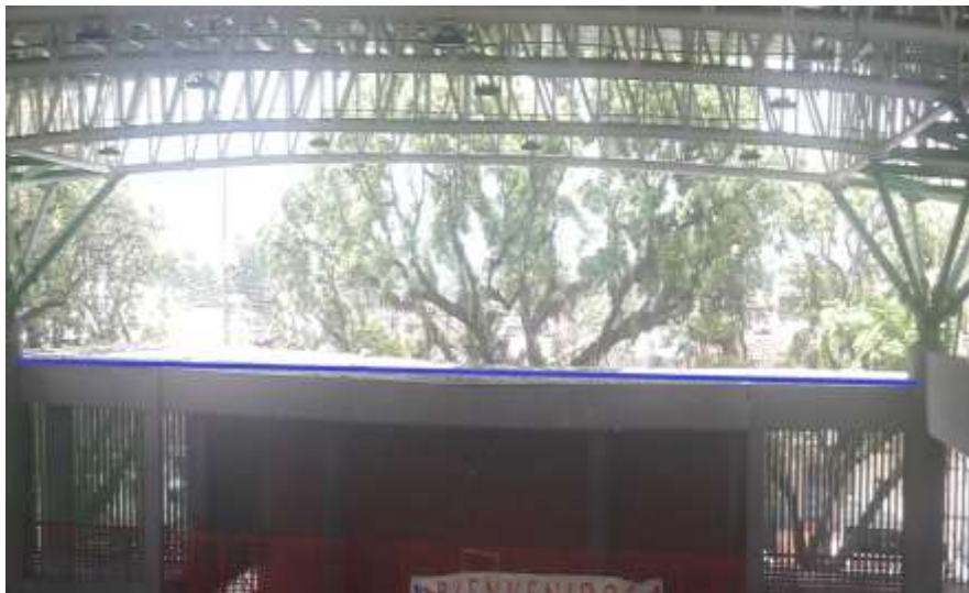
Fotografía N° 560. La deflexión de la viga principal ocasiona que la pendiente de la losa se dirija hacia el interior del Coliseo.
