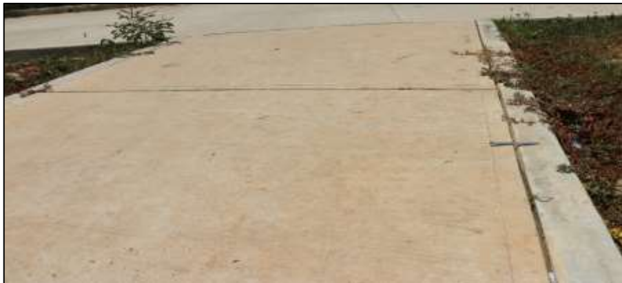
Fotografía 384 Vista general de una sección del andén perimetral, construido en zonas aledañas a este escenario deportivo. En esta obra, se evidenciaron fisuras transversales, grietas diagonales al sentido principal de circulación, así como desconfinamiento de los bordillos instalados.
