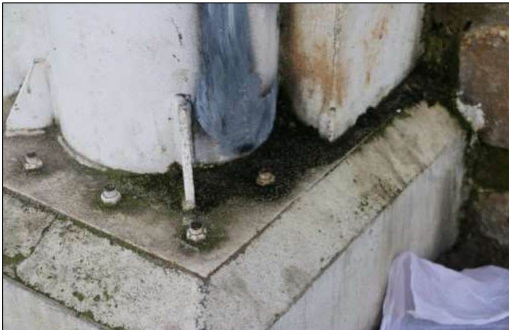
Fotografía 277. Detalle de la conexión metálica de una de las columnas de la estructura de cubierta en su pedestal de concreto. Se evidenció lavado diferencial en la superficie de los elementos metálicos y de concreto. Así mismo, acumulación de materia vegetal de manera progresiva y excesiva.
