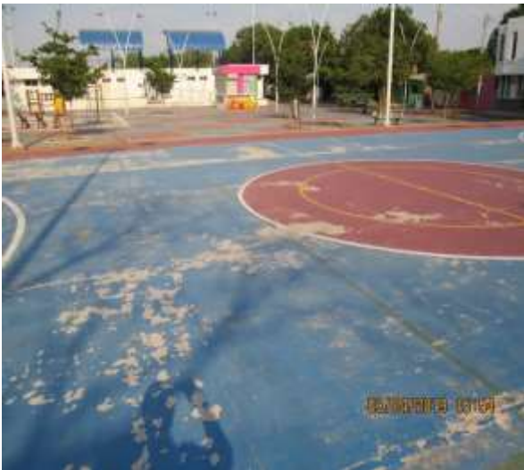
Fotografía 136. Muestra desprendimiento de pintura de la cancha multifuncional.
