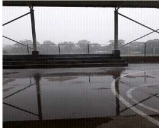
Fotografía N° 501. Rejilla Polideportivo rebosada
