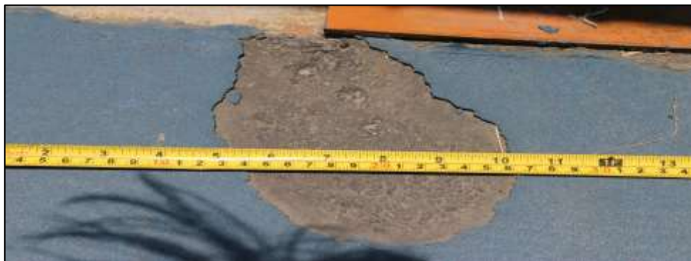
Fotografía 198. Detalle de otra sección de la pista de patinaje (patinódromo). Evidencia de desprendimiento de una sección del recubrimiento sintético, en una longitud aproximada de 12 cm.
