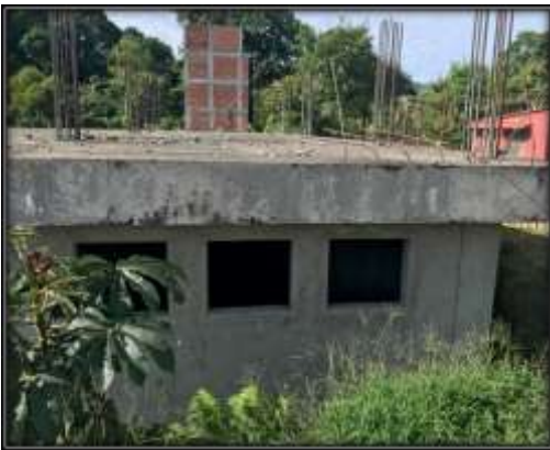
Fotografía N° 530. Obras suspendidas y abandonadas
