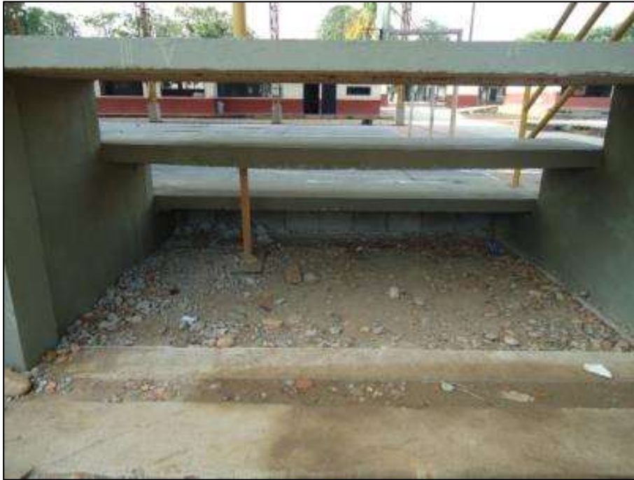
Fotografía 236. Vista general posterior de un tramo de la gradería construida. Se evidencia, de manera visual, la deflexión de la placa de concreto inferior de esta grada
