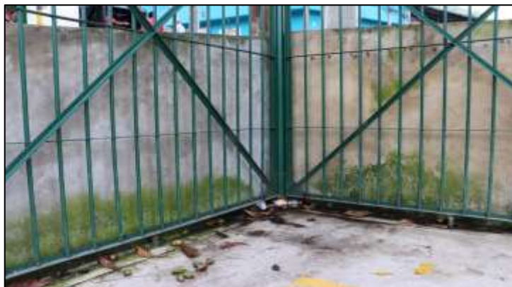
Fotografía 217. Vista general de una sección del muro de contención construido en dos de los costados externos de este polideportivo. Se evidenció presencia de una gran mancha verde (materia vegetal), que se está extendiendo en la superficie externa de esta estructura. La lesión se está presentando por debilidad del proceso constructivo y calidad del material utilizado.
