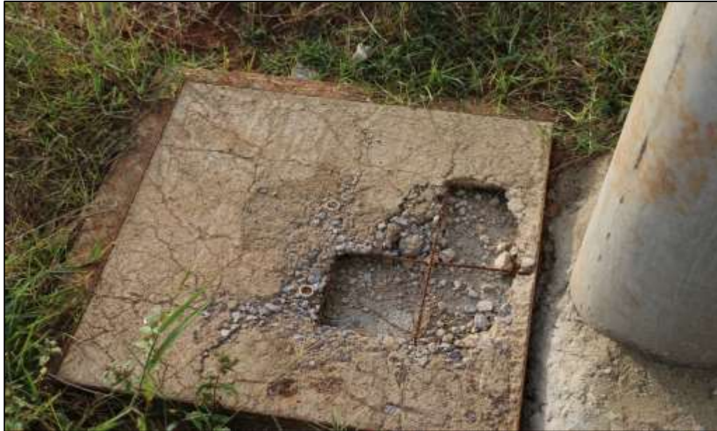
Fotografía 349 Detalle de una de las cajas eléctricas de inspección, construida junto de uno de los postes de la iluminación. Como se aprecia en la imagen, la placa de concreto evidencia fractura y desintegración. El acero de refuerzo, a su vez, está a la vista y totalmente oxidado.
