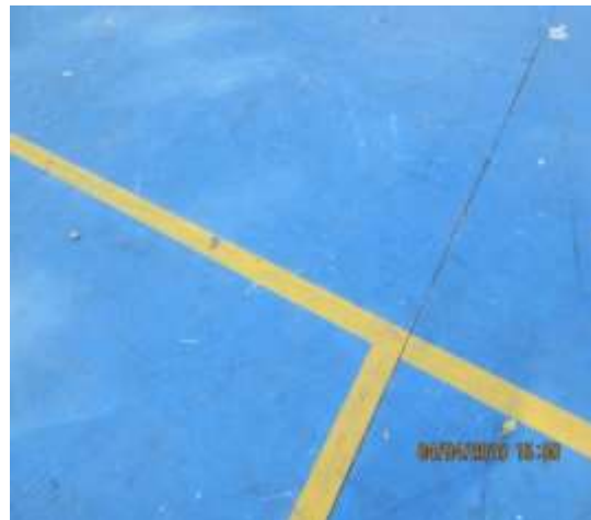
Fotografía 145. Muestra grieta transversal presentada en una losa de la cancha multifuncional.
