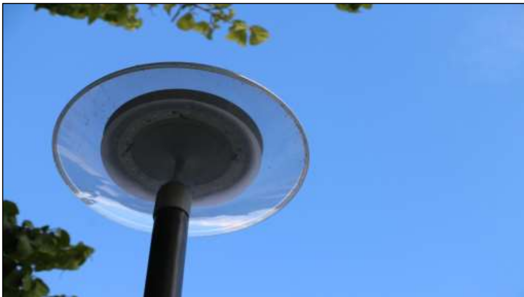
Fotografía 422 Detalle de las luminarias instaladas en uno de los postes sencillos (de 1 luminaria por poste), evidenciados en el parque reconstruido. Los postes se incluyeron en el ítem 27.1 y las luminarias en el ítem 27.3, con el objeto de cuantificar las diferencias evidenciadas por la CGR.
