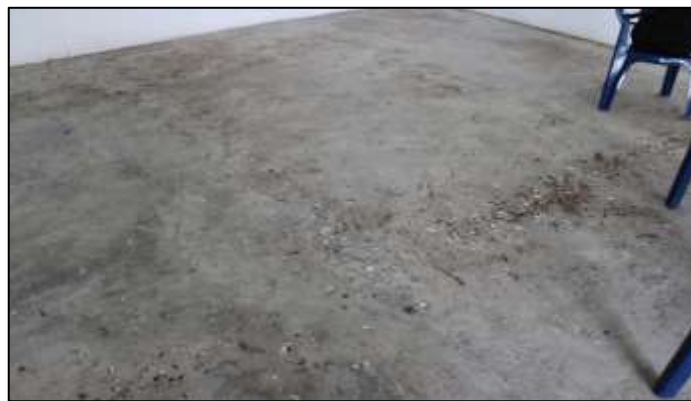
Fotografía 245. Vista general de una sección de la placa de contra piso (hacia la fachada junto al embalse del Muña). En la imagen quedó registrado el estado en que se encontró esta estructura, en cuanto a la presencia de materia orgánica, derivada de excremento de paloma.
