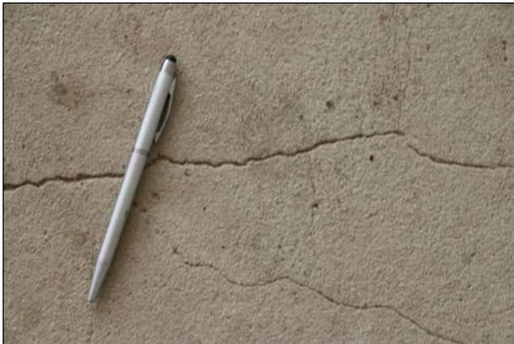
Fotografía 375 Detalle de una fisura, evidenciada en el concreto de las graderías (vista en planta). Algunas fisuras evidenciadas, presentan otras cercanas ubicadas de manera diagonal. No obstante, no se evidenciaron interconectadas.
