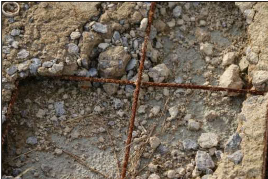
Fotografía 350 Detalle de la sección de concreto fracturada, imagen anterior. El concreto se evidenció desmoronado y desintegrado. Así mismo, el acero de refuerzo está totalmente oxidado.
