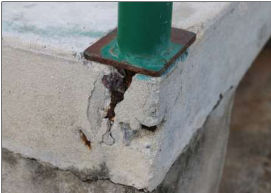
Fotografía 333 Detalle del sitio de conexión de uno de los parales de la baranda, instalada en una de las graderías construidas en este escenario deportivo. Por la baja calidad del proceso constructivo de estos detalles, en estas zonas se evidenció grieta del concreto, pérdida parcial de sección transversal, acero de refuerzo a la vista y oxidación de los elementos metálicos.
