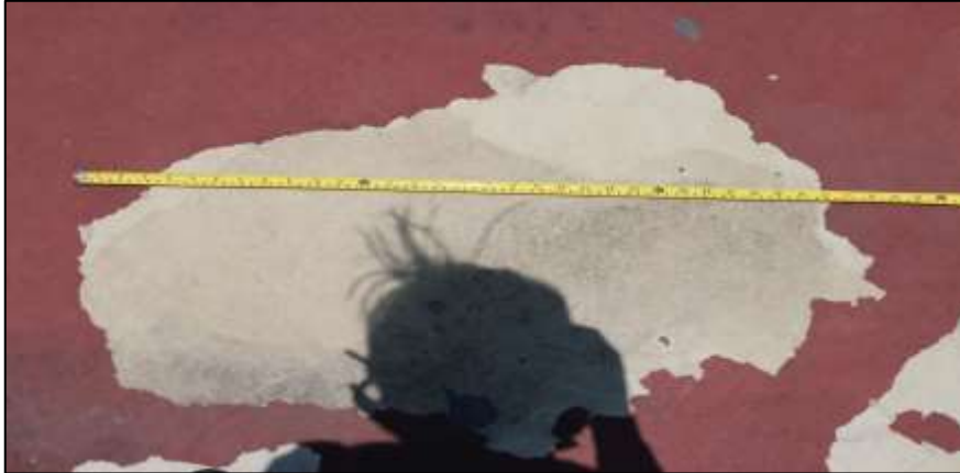
Fotografía 202. Detalle de una sección de la pista de hockey. Evidencia de desprendimiento parcial del acabado superficial de la capa de rodadura, en una longitud de 70 cm.
