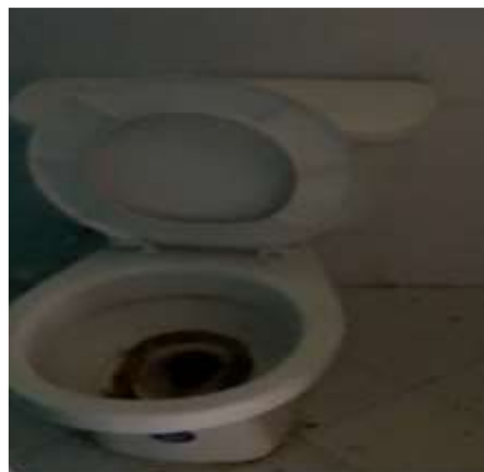
Fotografía N° 499. Baños en deterioro
