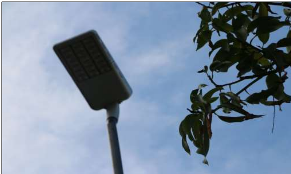
Fotografía 423 Detalle del reflector instalado en uno de los postes y evidenciado en el parque reconstruido. Los postes se incluyeron en el ítem 27.2 y los reflectores en el ítem 27.5, con el objeto de cuantificar las diferencias evidenciadas por la CGR.
