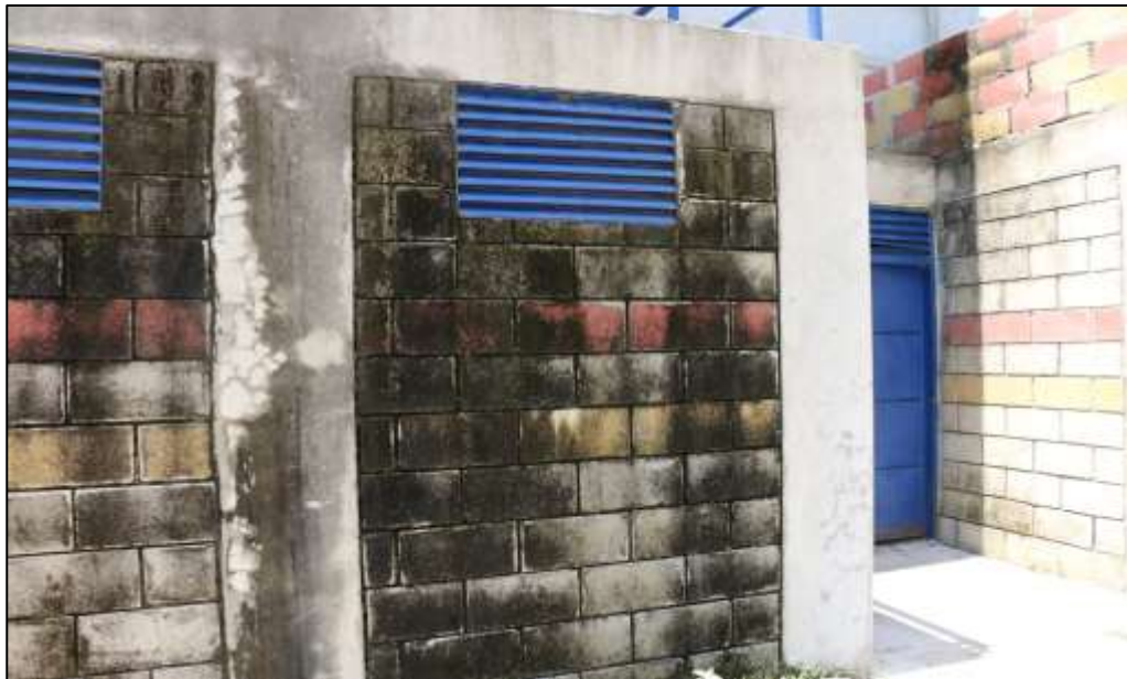
Fotografía 409 Detalle de una sección de muro perimetral de las graderías, ubicado en la parte posterior de esta obra. Estos elementos evidenciaron lavado diferencial y manchado por escurrimiento de agua y concentración de humedad.
