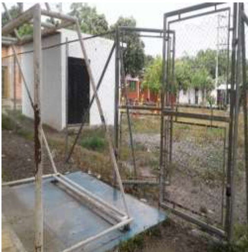
Fotografía N° 522. Estructura de las canchas oxidadas
