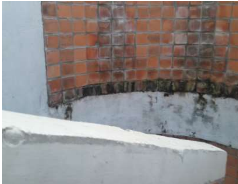
Fotografía N° 563. Humedades en muros y pisos internos por la deficiencia encontrada. Foto tomada por el auditor el 04 de abril de 2019
