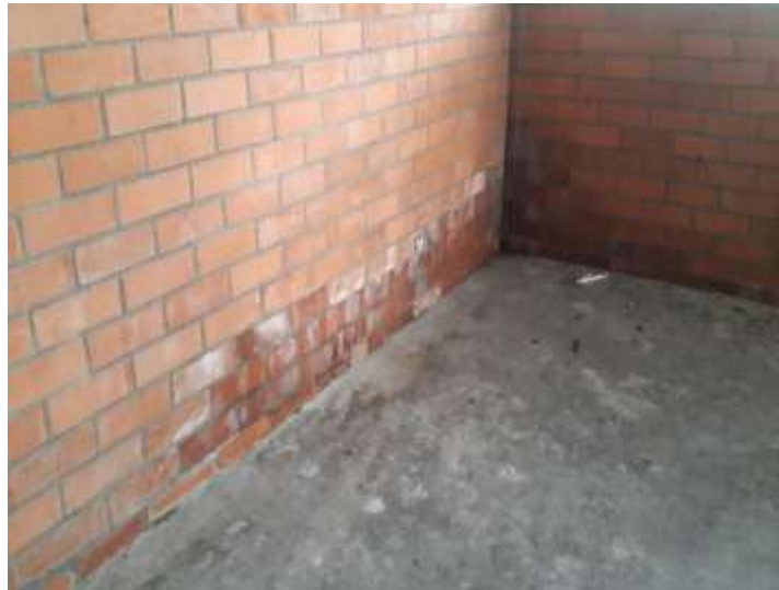
Fotografía N° 557. Marcas dejadas por las inundaciones de agua en los baños de las graderías del sector Occidental, se observa el nivel que alcanza el agua en esta zona del Coliseo. Foto tomada por el Auditora Abril del 2019.
