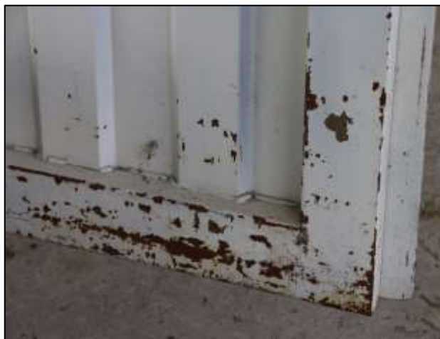
Fotografía 242. Detalle inferior de la puerta metálica en uno de los baños construidos. Se evidencia en los elementos metálicos, la pérdida parcial de la pintura de acabado, por abrasión y erosión.
