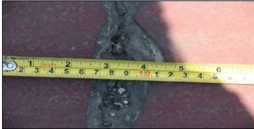
Fotografía 205. Detalle de la lesión identificada en la imagen anterior. La abertura de la grieta en algunos sitios es de 5 cm. En esta fotografía se evidencia que el concreto de la placa bajo el acabado superficial, también está afectado.
