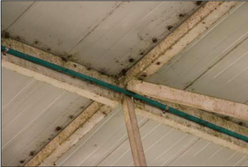
Fotografía 266. Detalle de la conexión entre correas metálicas a nivel de la cumbre de la cubierta. En esta zona se evidenció lavado diferencial, manchado superficial y picadura de óxido, en los elementos metálicos que componen la estructura de la cubierta.
