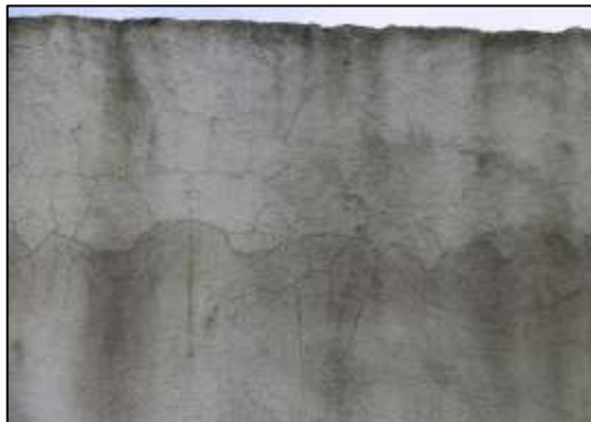
Fotografía 256. Detalle del paño de mampostería, registrado en la imagen anterior. Se evidencia las lesiones descritas en la anterior fotografía.
