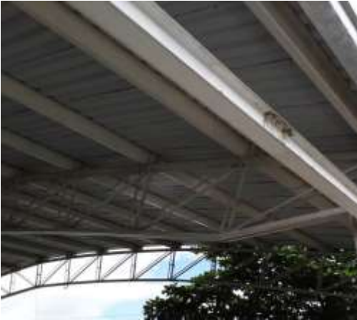
Fotografía N° 484. Proceso Oxidación estructura de la cubierta
