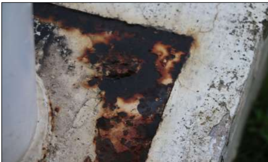
Fotografía 191. Detalle de otra sección de platina, en otra de las conexiones de placa base de las columnas metálicas de la cubierta. En la imagen se evidencia las lesiones ya identificadas y descritas en las fotografías anteriores.
