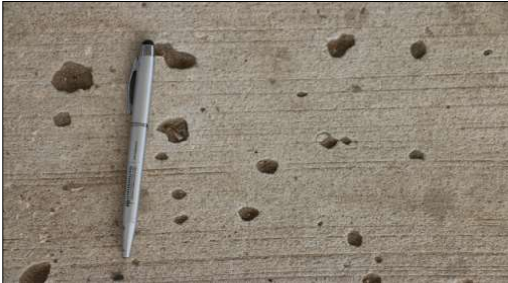
Fotografía 366 Detalle del hormigueo encontrado, en el pavimento de concreto de la cancha multideportiva (vista en planta). Según la escala utilizada en la imagen (esfero de ancho 10 mm), el hormigueo, en algunas secciones, presentan aproximadamente 20 mm de abertura. Esta lesión se evidenció de manera general en la superficie del concreto.
