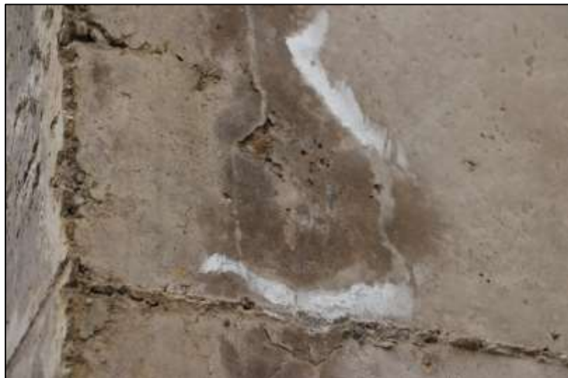
Fotografía 188. Detalle de la superficie de otra de las columnas de concreto construidas en este polideportivo. En la imagen se observa la lesión ya descrita.
