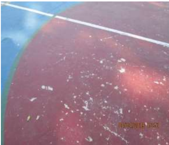
Fotografía 146. Muestra desprendimiento de la pintura en la cancha multifuncional.
