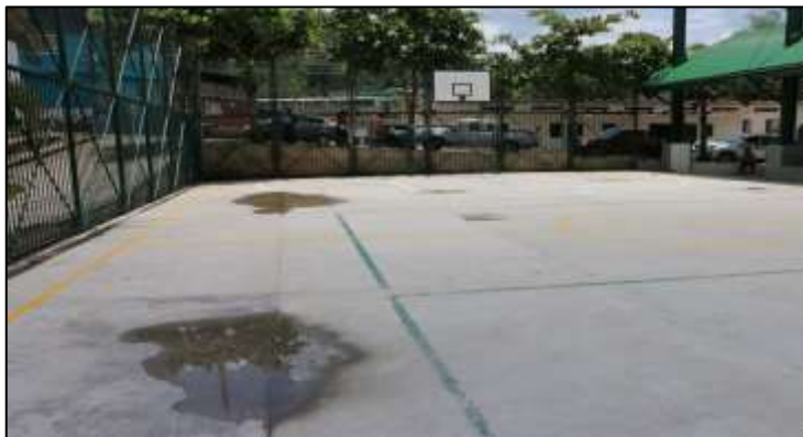
Fotografía 216. Vista general de las placas de concreto construidas en el área de la cancha multideportiva, de este escenario deportivo. Se evidencia el mismo fenómeno ya descrito.
