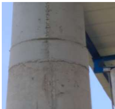
Fotografía 53 Hormigqueo y rebaba del concreto en columna
