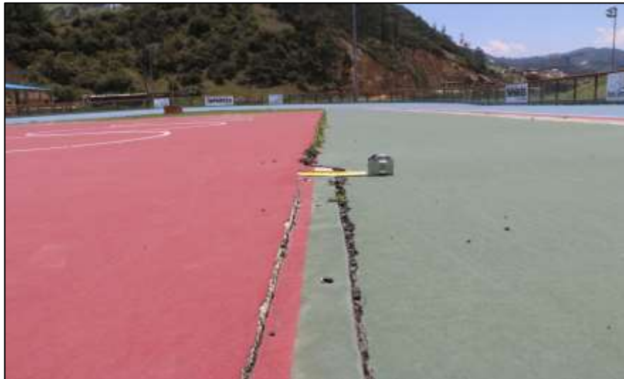
Fotografía 208. Detalle de otra sección de la pista de hockey. Evidencia de grieta paralela al sentido largo de este escenario.
