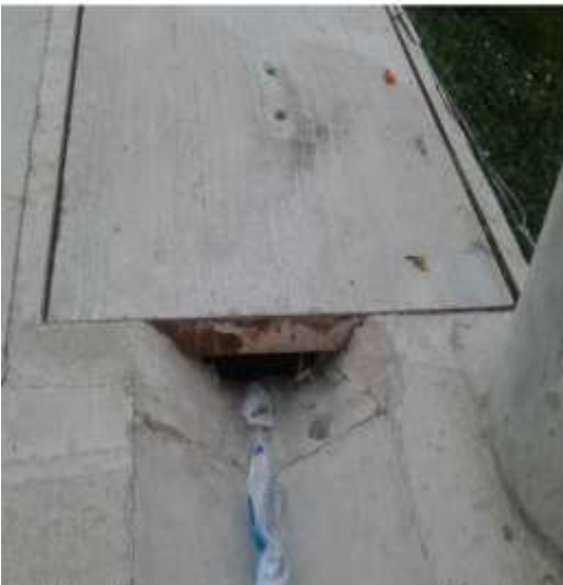
Fotografía N° 478. Oxido en la caja de empalme
