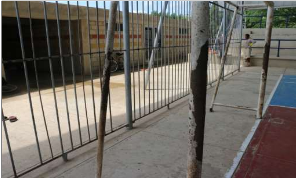
Fotografía 393 Detalle de una de las canchas deportivas, instaladas en el polideportivo. En los elementos metálicos que componen estas canchas, se evidenciaron oxidación profunda y desprendimiento parcial de la pintura de acabado. En algunas secciones además, se evidenció inicio de corrosión.
