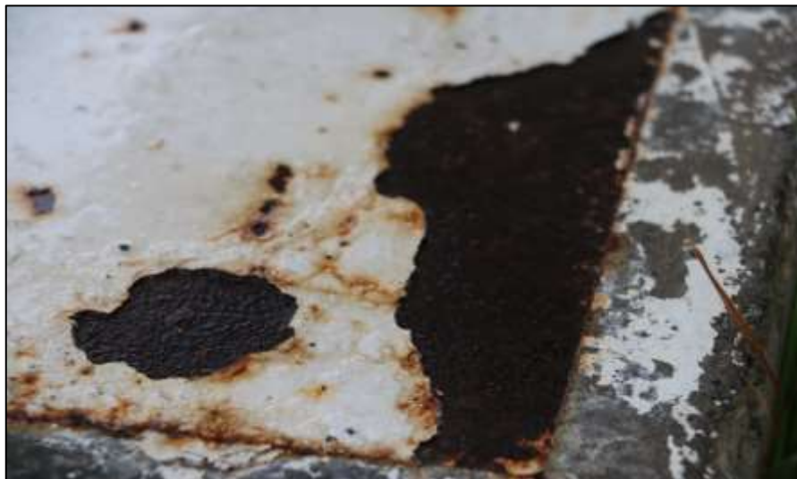
Fotografía 190. Detalle de una sección de platina, en una de las conexiones de placa base de las columnas metálicas de la cubierta. En la imagen quedó registrado el estado en el cual la CGR encontró las obras: pérdida parcial de pintura de acabado y oxidación de elementos metálicos.
