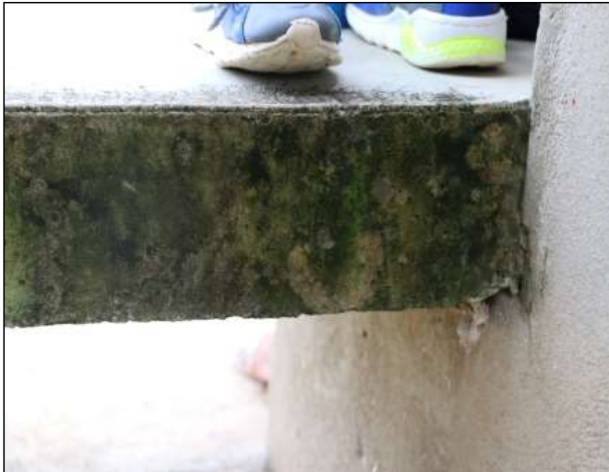
Fotografía 337 Detalle de una sección de placa como grada (graderías construidas en este escenario deportivo). La superficie del concreto evidencia manchado diferencial (verde y negro), por acumulación constante de humedad (interna y externa) en el material. El color verde denota deterioro del concreto, en cuanto el material está reaccionando con la humedad.
