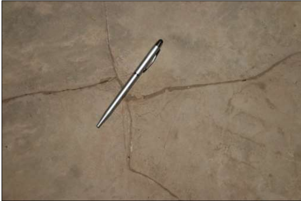
Fotografía 380 Detalle de unas fisuras interconectadas, evidenciadas en la superficie del pavimento registrado en la imagen anterior.
