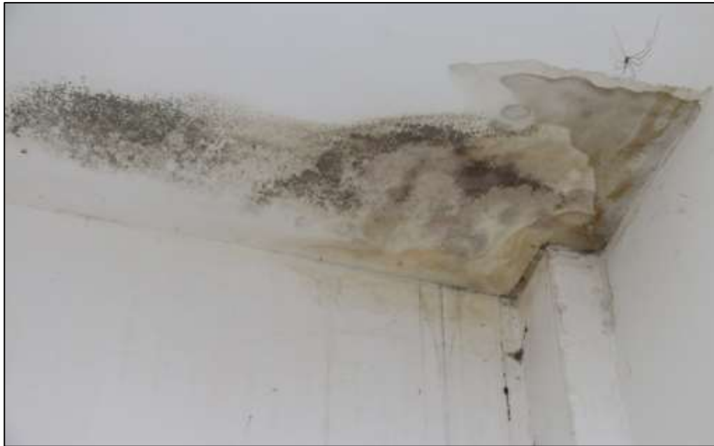
Fotografía 355 Detalle de la esquina superior de uno de los espacios adecuados, dentro del edificio administrativo. En algunas secciones de los cielos rasos, como la registrada en la imagen, se evidenció manchado diferencial del material por acumulación de humedad, proveniente de filtración desde la cubierta.
