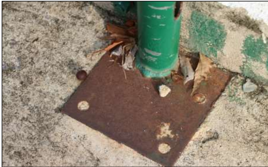
Fotografía 341 Detalle de la platina de conexión, de uno de los parales de la baranda, construida en una de las graderías de la pista de patinaje. En la imagen quedó registrado el estado en el cual se encontraron algunos de los elementos metálicos, los cuales evidencian oxidación avanzada.
