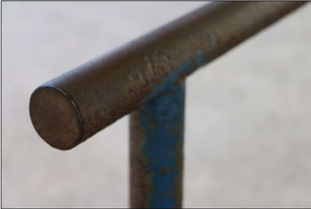
Fotografía 169. Detalle de una sección de tubería, en una de las barandas instaladas en la zona perimetral a la tarima al aire libre.
