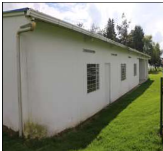
Fotografía 257. Vista general de la fachada principal del escenario deportivo. En la esquina de este muro, en la zona baja, se evidenció deterioro del pañete de este elemento.
