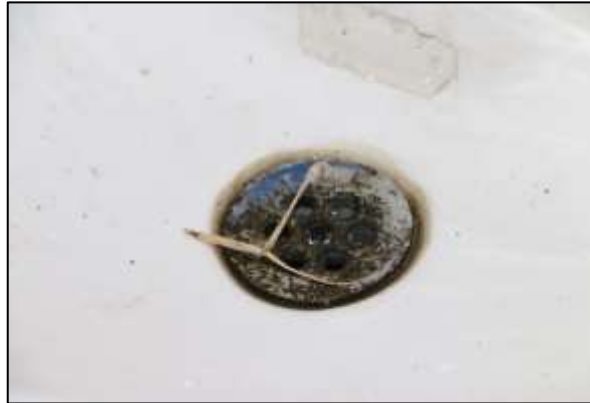
Fotografía 240. Detalle de la rejilla del sifón de uno de los lavamanos. Se evidencia deterioro superficial de este accesorio, por corrosión del material.
