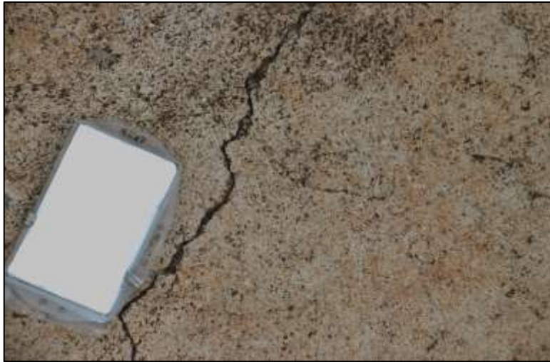
Fotografía 340 Detalle de una de las fisuras encontradas, en la placa de contra piso de las graderías. La baja calidad del concreto utilizado, así como posibles asentamientos del suelo, son la causa de la lesión identificada.
