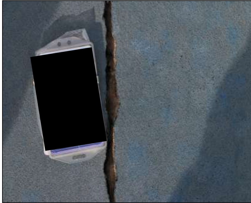
Fotografía 317 Detalle de una sección de la pista de patinaje (patinódromo). En la imagen, quedó registrada la comparación de la abertura de una grieta en el pavimento y un objeto de dimensión conocida (carné de ancho 58 mm). Por tanto, según esta escala, la abertura de la grieta de la imagen es de 10 mm, aproximadamente.
