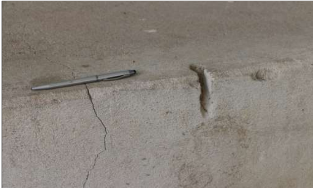
Fotografía 374 Detalle de una fisura, evidenciada en el concreto de las graderías (vista frontal). Se evidenciaron fisuras que transitan no solo a nivel de piso, sino también de manera vertical.
