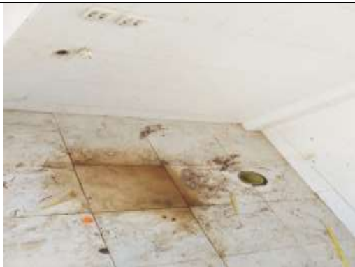
Fotografía 36 Conexiones de inodoro y lavamanos hurtados Nótese el desaseo
