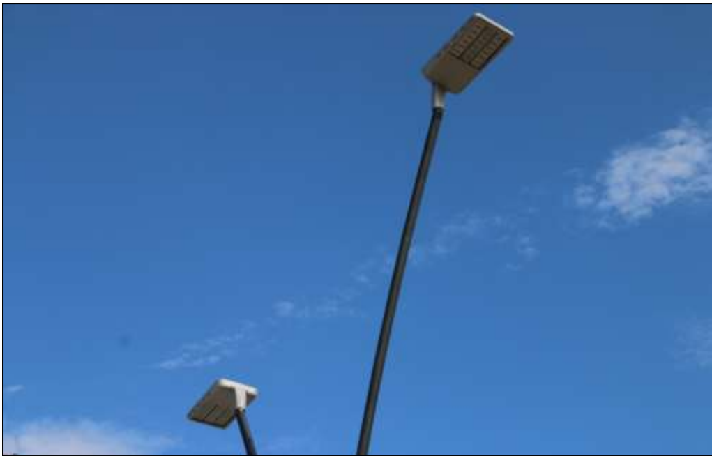
Fotografía 421 Detalle de las luminarias instaladas en uno de los postes dobles (de 2 luminarias por poste), evidenciados en el parque reconstruido. Los postes se incluyeron en el ítem 27.1 y las luminarias en el ítem 27.4, con el objeto de cuantificar las diferencias evidenciadas por la CGR.
