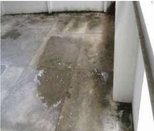
Fotografía N° 492. Encharcamiento deterioro piso Polideportivo
