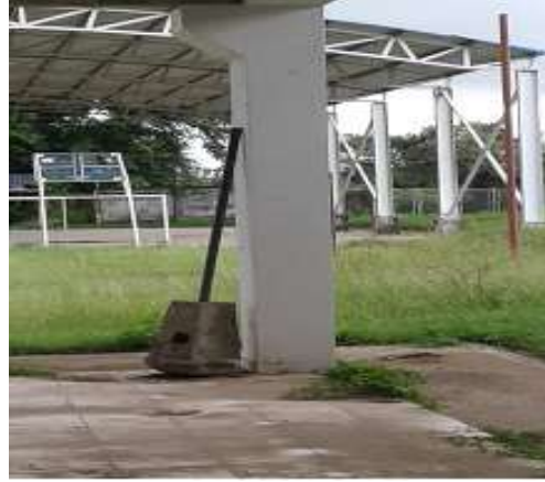
Fotografía N° 505. Poste de luz arrancados y dispersos por la Villa Olímpica
