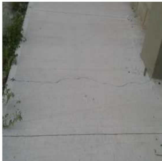
Fotografía N° 481. Agrietamiento anden perimetral
