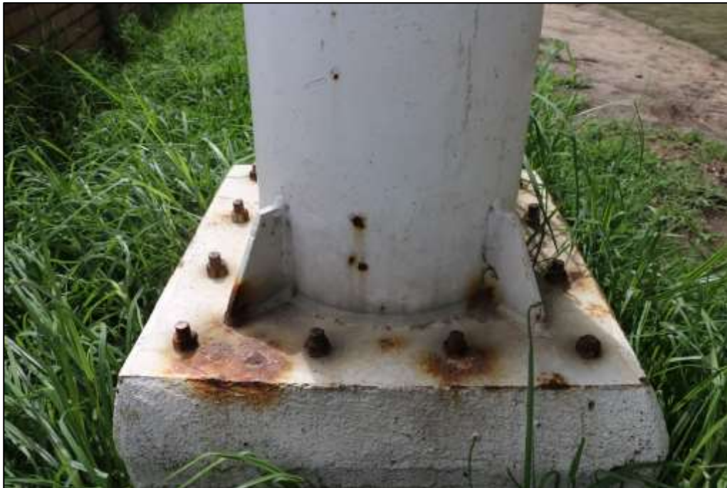
Fotografía 279. Detalle de la conexión metálica de una de las columnas de la estructura de cubierta, en su pedestal de concreto. Se evidenció en estos detalles constructivos, la presencia de óxido diferencial en la superficie de las platinas, tuercas y varillas roscadas.
