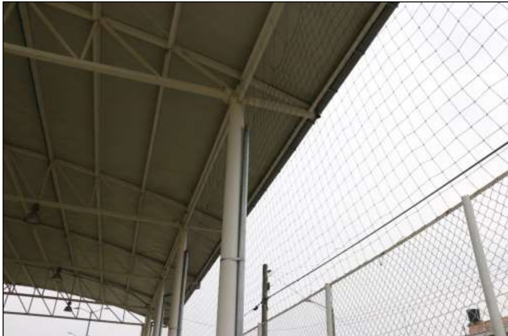
Fotografía 293. Vista general de una sección interna de la cubierta. Se evidenció en varias de las bajantes instaladas, la ausencia del tramo superior, que las conecta con la canal perimetral. De esta manera, el sistema de evacuación del agua lluvia está fuera de servicio.
