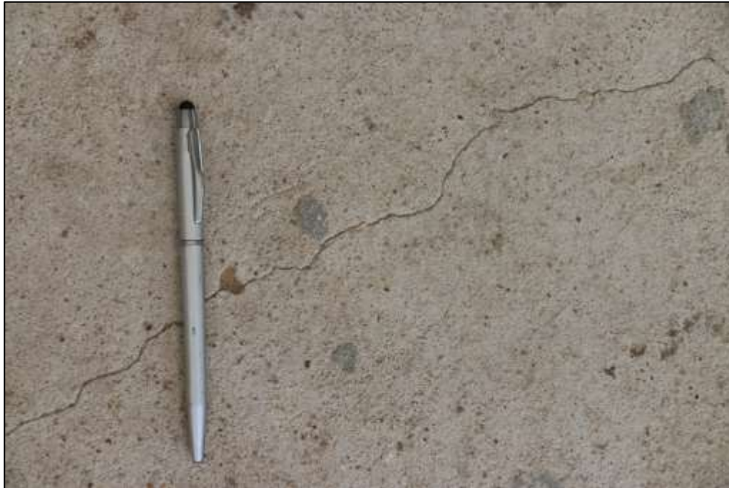
Fotografía 372 Detalle de una fisura, evidenciada en el concreto de las graderías (vista en planta). Según la escala utilizada en la imagen (esfero de ancho 10 mm), las fisuras no superan el milímetro de abertura. En estas zonas, las fisuras en su mayoría se encontraron transversales al sentido de circulación, continuas y desconectadas.
