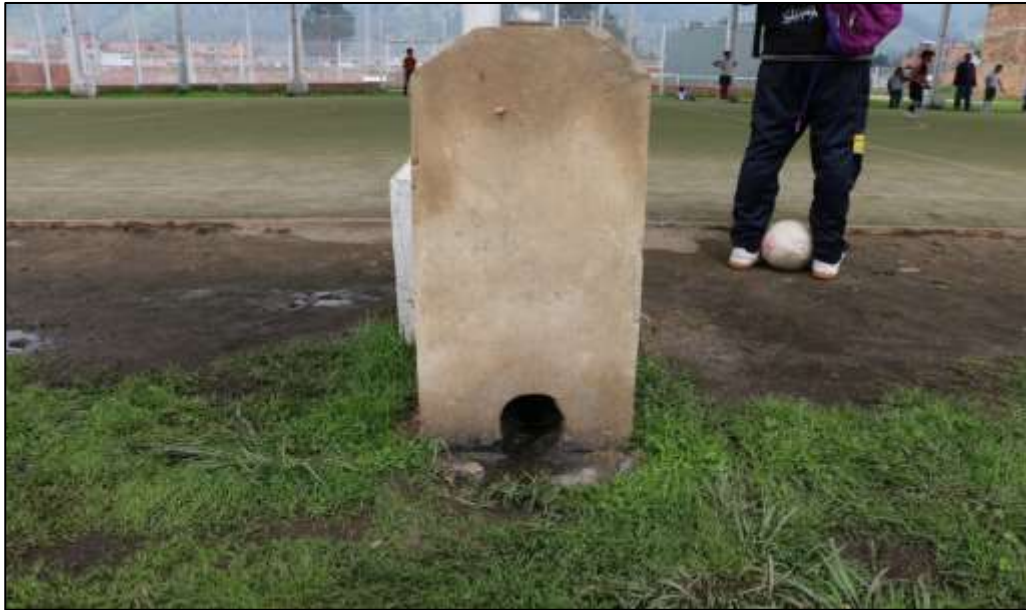
Fotografía 282. Detalle de la descarga de una de las bajantes instaladas. Se evidenció que las bajantes de la cubierta descargan el agua de manera directa a la superficie, sin ningún control. De esta manera, los alrededores de la grama sintética evidencian agua estancada.
