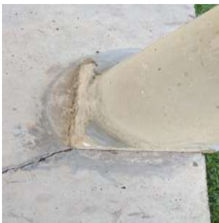
Fotografía 52 Basamento (poyo) de columna en concreto destruido
