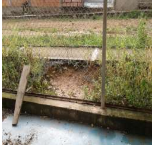
Fotografía N° 521. Malla eslabonada rota
