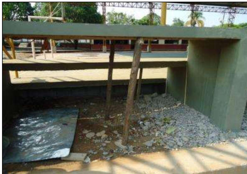
Fotografía 235. Vista general posterior de un tramo de la gradería construida. Se evidencian los puntales de madera. La instalación de estos elementos no evidencia ningún procedimiento técnico de construcción.
