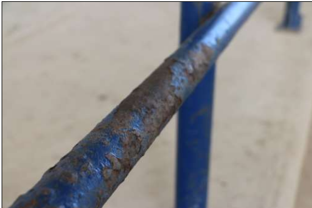
Fotografía 395 Detalle de una sección de baranda, instalada en frente de las graderías construidas en el polideportivo. En la imagen quedó registrado el estado de deterioro evidenciado por la CGR en estos elementos metálicos, consistente en oxidación parcial, desprendimiento parcial y ampollas de la pintura de recubrimiento. En algunas zonas secciones, se evidenció inicio de corrosión.
