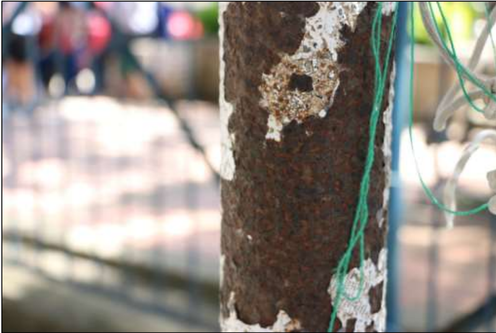
Fotografía 173. Detalle de otra sección de tubería, en uno de los arcos instalados dentro del polideportivo construido. En la imagen se evidencia la lesión ya descrita.
