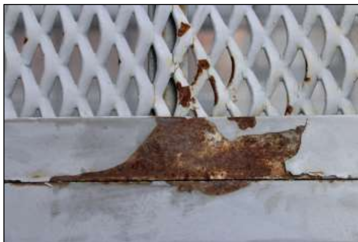
Fotografía 155. Detalle de una sección de piso, ubicado en el nivel más alto de la escalera de emergencia. Se evidenció en varias zonas de esta escalera, oxidación y pérdida parcial de pintura de protección.
