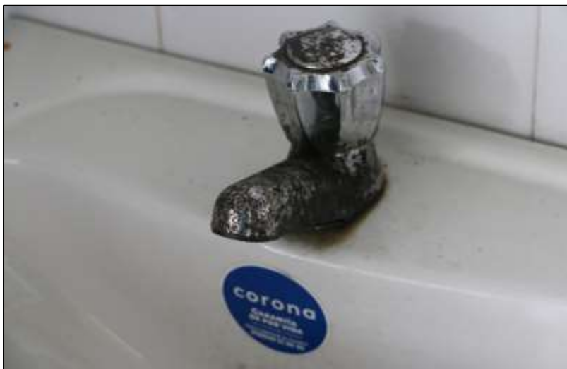
Fotografía 239. Detalle de la grifería instalada en uno de los lavamanos de los baños del edificio de polígono. Se evidencia el mal estado en el cual se encuentra este accesorio, instalado por el contratista de obra: manchado negro de la superficie por oxidación.
