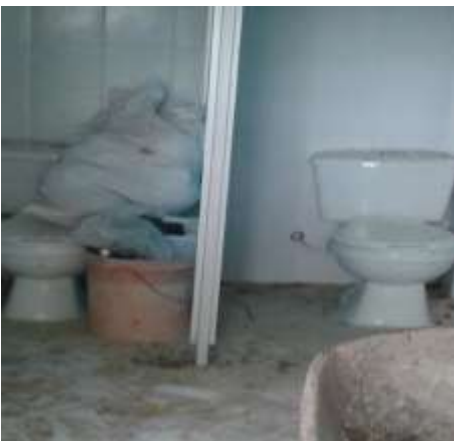
Fotografía N° 498. Baños en deterioro
