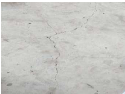
Fotografía 54 Fisura en superficie de piso
