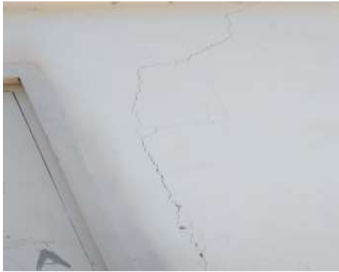
Fotografía 38 Fisura en parte de camerino 1
