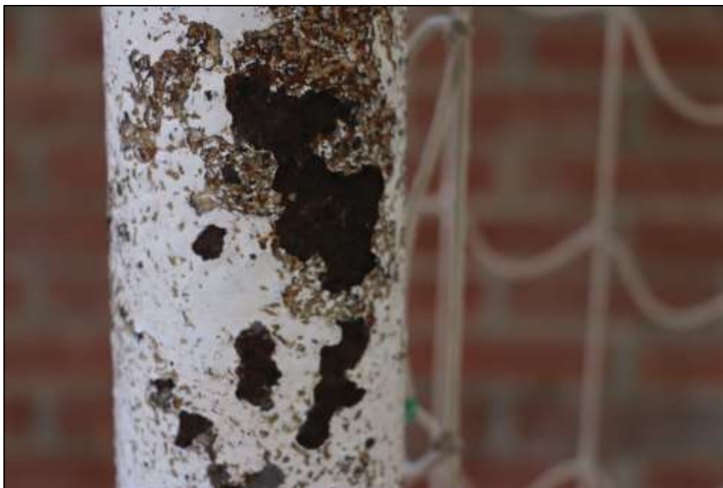
Fotografía 172. Detalle de una sección de tubería, en uno de los arcos instalados dentro del polideportivo construido. Estos elementos evidenciaron pérdida parcial de la pintura de acabado y oxidación diferencial de los elementos metálicos.
