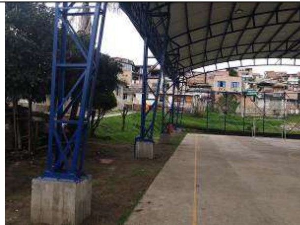
Fotografía 128 Detalle de la estructura de cubierta, basada en dados de concreto reforzado
