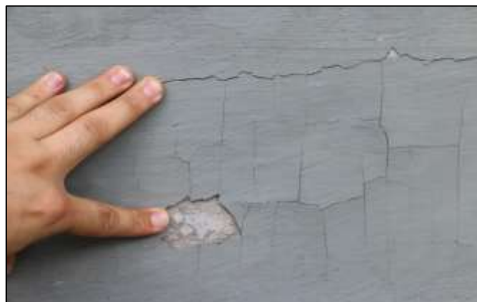
Fotografía 223. Detalle de otra sección de contrahuella en una de las graderías construidas. El pañete en esta zona evidencia fisuras interconectadas en formato “piel de cocodrilo” y pérdida parcial de sección de este material.
