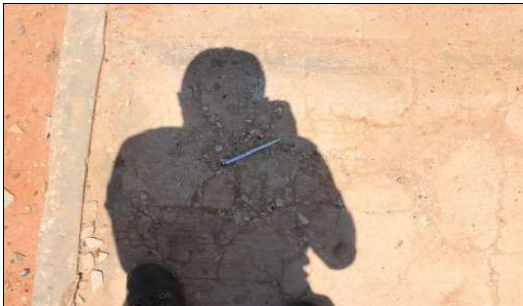
Fotografía 419 Detalle de una sección del pavimento, de uno de los andenes perimetrales construido sobre uno de los costados de este escenario deportivo. Este elemento de concreto, se evidenció con hundimientos, agrietamiento concentrado y desagregación parcial del material. La Secretaria de Planeación del municipio, manifestó que por el paso de vehículos (automóviles y motocicletas), se han deteriorado estos pavimentos.
