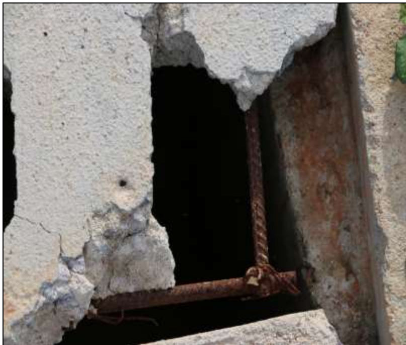
Fotografía 332 Detalle de una sección del elemento presentado en la imagen anterior. En la imagen, el acero de refuerzo longitudinal a la vista. Se evidencia, además, que el acero de refuerzo no cuenta con la longitud de desarrollo requerido por norma, para garantizar su desempeño estructural (NSR-10, título C).
