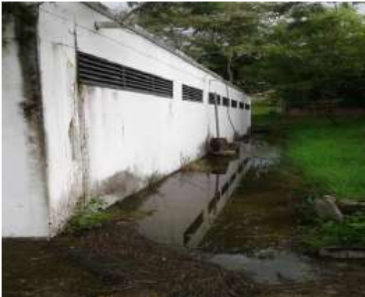
Fotografía N° 510. Conexión fraudulenta de agua
