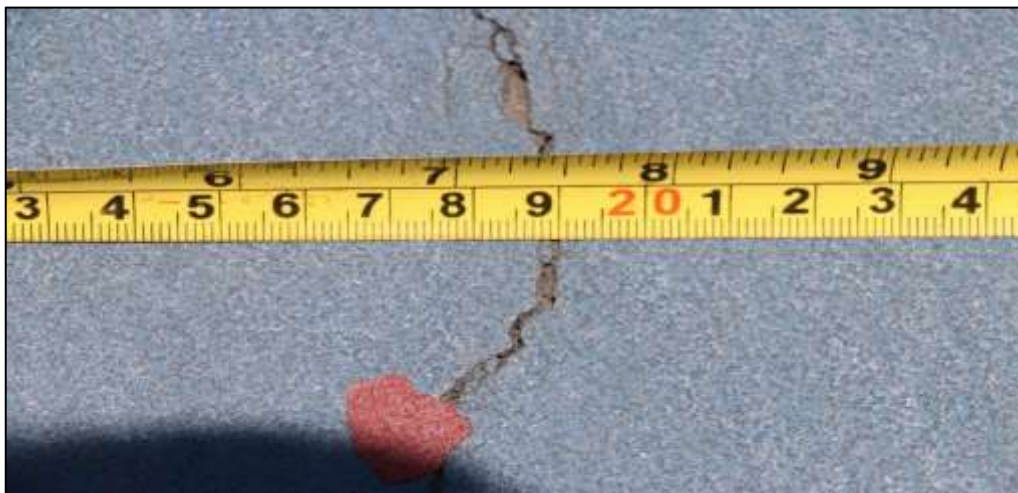
Fotografía 197. Detalle de la lesión identificada en la imagen anterior. Según el flexómetro utilizado, la abertura de la fisura no supera los 2 milímetros.
