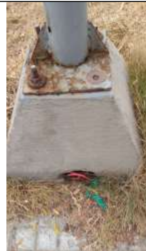
Fotografía 4 Instalaciones eléctricas expuestas y postes con óxido
