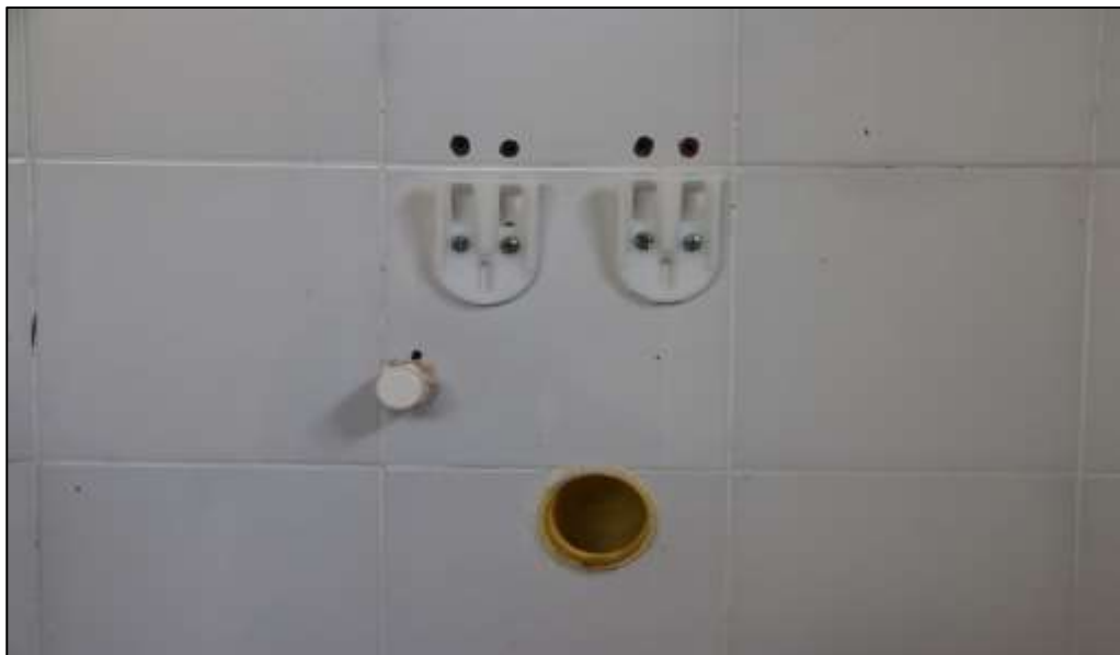
Fotografía 399 Detalle de la salida hidráulica de un lavamanos, en uno de los baños adecuados en el edificio administrativo del polideportivo (detalle de la imagen anterior). En la imagen se observan aun instalados los accesorios para instalar el lavamanos, así como las salidas hidráulicas (suministro a la izquierda y desagüe a la derecha).
