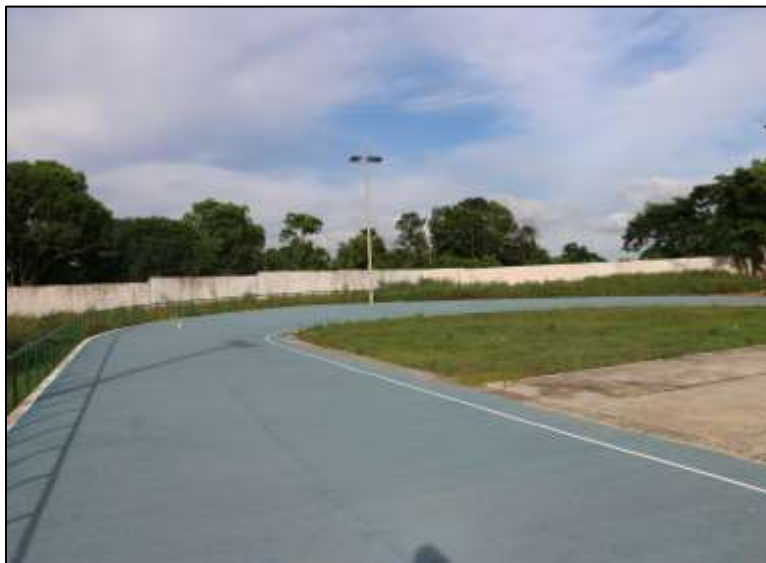
Fotografía 313 Vista general de un tramo de la pista de patinaje construida. El pavimento de este escenario se construyó en concreto reforzado. Sobre éste, se evidenciaron fisuras y grietas, distribuidas a lo largo de toda la circulación.
