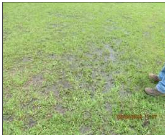
Fotografía 229. Vista general de otra sección de la zona central de la cancha de fútbol. Se evidenció la misma lesión ya descrita, en la obra construida.
