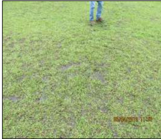
Fotografía 227. Vista general de otra sección de la zona central de la cancha de fútbol. Se evidenció la misma lesión ya descrita, en la obra construida.
