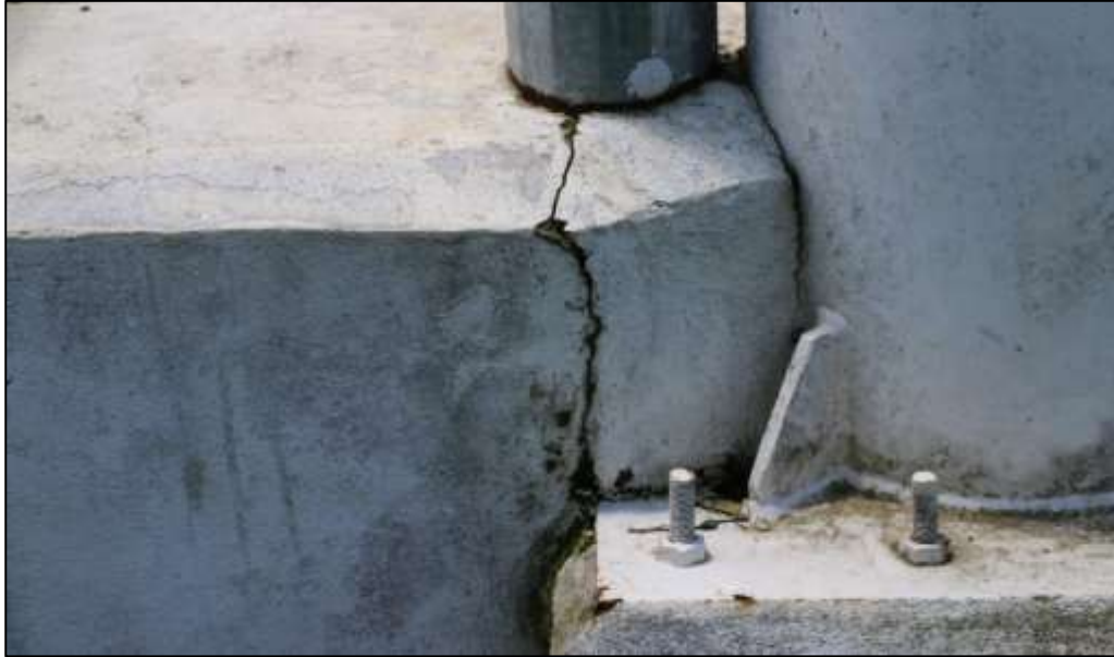
Fotografía 268. Detalle del ingreso de una de las bajantes a una caja de mampostería. Se evidenció grieta en este muro, en varios de estos detalles de la construcción realizada.
