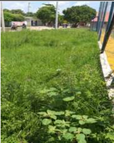
Fotografía 22 Lote contiguo enmontado que impide acceso por puerta principal
