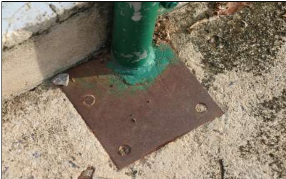
Fotografía 342 Detalle de la platina de conexión, de otro de los parales de la baranda, construida en una de las graderías de la pista de patinaje. Se evidencia la misma lesión, causada por falta de mantenimiento periódico de la infraestructura construida.
