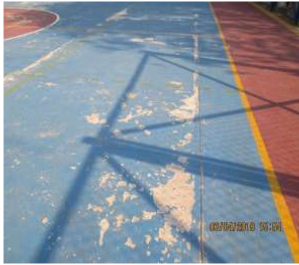
Fotografía 135. Muestra desprendimiento de pintura de la cancha multifuncional.
