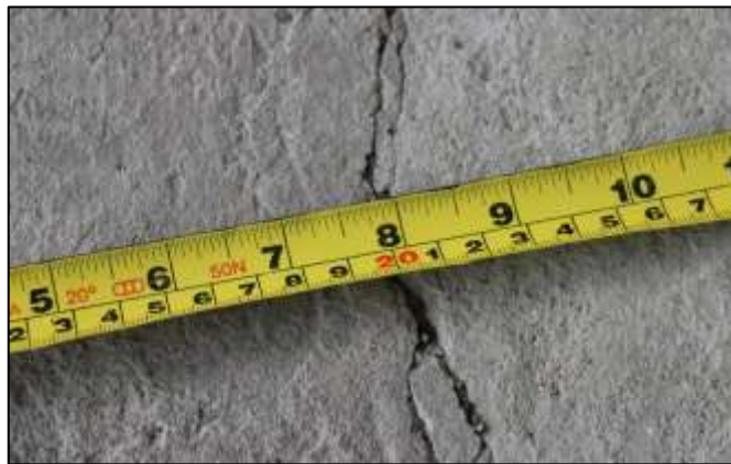
Fotografía 247. Detalle de la fisura registrada en la imagen anterior. Según la escala utilizada en la fotografía, la abertura de esta lesión alcanza los 5 mm. Los bordes de la fisura se encuentran desportillados y con secciones perdidas.
