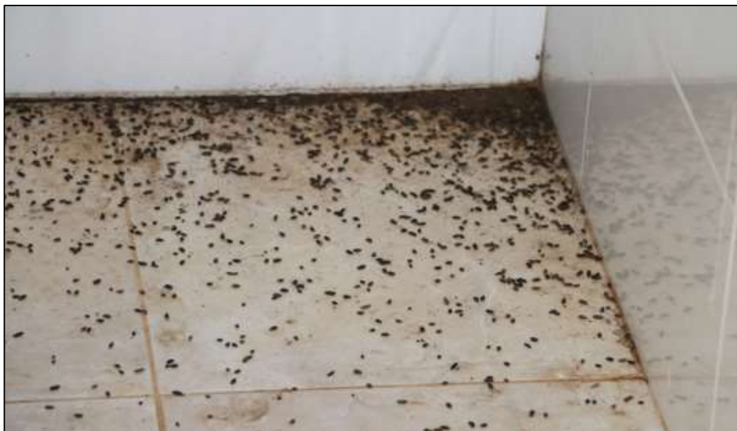
Fotografía 353 Detalle de la esquina inferior de uno de los espacios adecuados, dentro del edificio administrativo. Se evidencia en la imagen la lesión descrita en la fotografía anterior.
