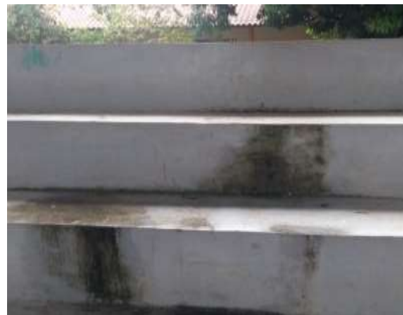
Fotografía N° 514. Detalle de humedades en las graderías
