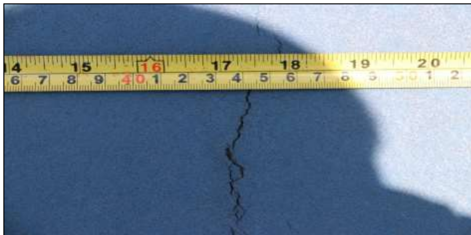
Fotografía 195. Detalle de la lesión identificada en la imagen anterior. Según el flexómetro utilizado, la abertura de la fisura no supera el milímetro.
