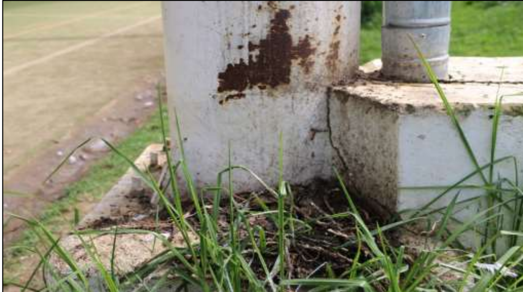
Fotografía 278. Detalle de una sección de una de las columnas metálicas, instaladas en este polideportivo. Se evidenció pérdida parcial y diferencial de pintura de acabado y oxidación de estos elementos.
