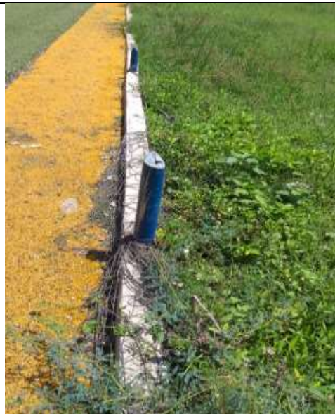
Fotografía 27 Sin tubería de soporte de malla. Nótese viga de piso curvilínea
