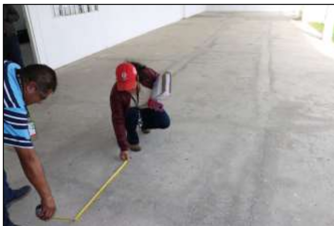
Fotografía 248. Vista general de la placa de contra piso, a lo largo del pasillo principal de este escenario deportivo. En la imagen, los funcionarios de la alcaldía municipal que acompañaron la inspección de la CGR.
