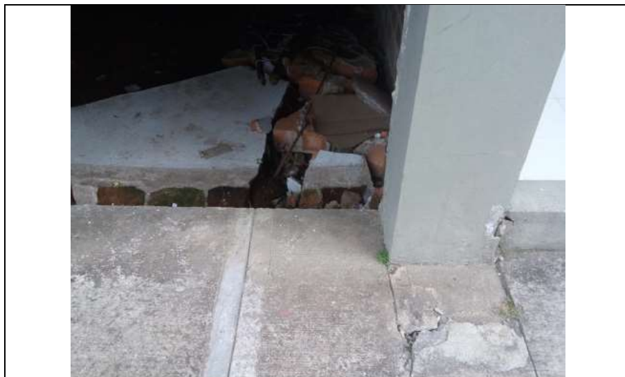
Fotografía 428 Colapso de muro de tabique lateral y deformación de piso del andén. Los desniveles son de 2 centímetros y más.
