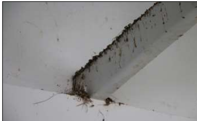
Fotografía 244. Detalle de otra de las correas metálicas, instaladas en la cubierta de este escenario deportivo. Se evidenció presencia de excremento de paloma, sobre los elementos metálicos y a nivel de la placa de contra piso. El escenario deportivo evidencia abandono por parte de la administración municipal.
