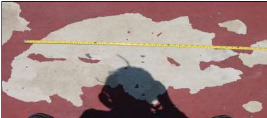
Fotografía 203. Detalle de otra sección de la pista de hockey. Evidencia de desprendimiento parcial del acabado superficial de la capa de rodadura, en una longitud de 100 cm.
