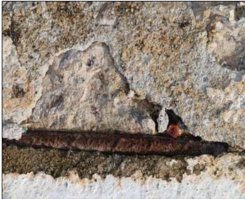
Fotografía 327 Detalle de una sección del elemento presentado en la imagen anterior. Detalle del agregado y del acero a la vista.
