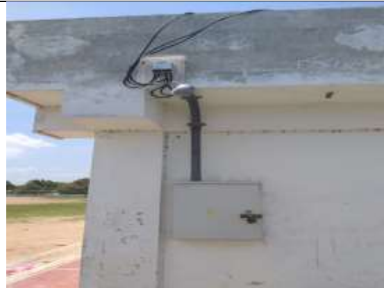
Fotografía 33 Cables eléctricos expuestos
