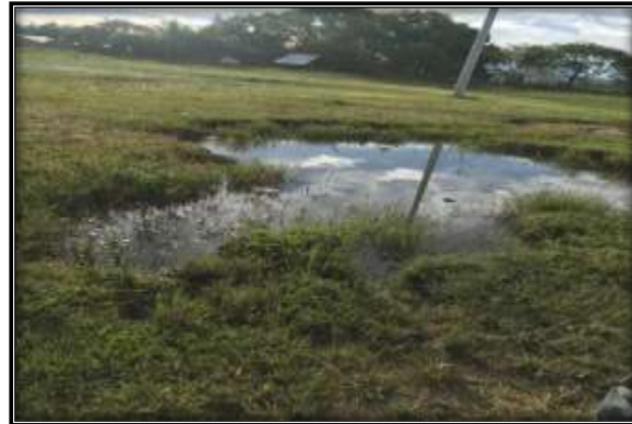
Fotografía N° 552. El pozo séptico no fue instalado correctamente, por este motivo no es funcional
