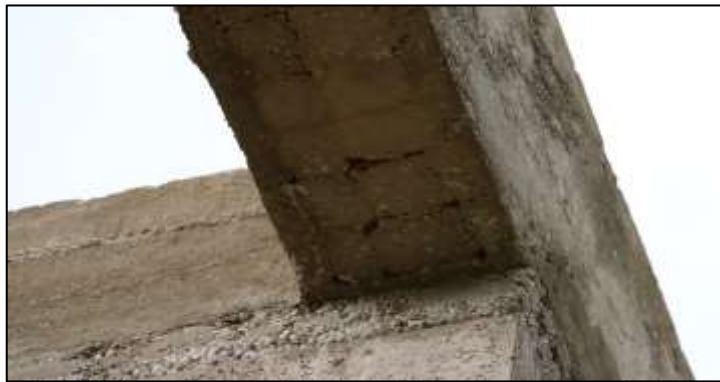
Fotografía 180. Detalle del nudo superior en uno de los pórticos de concreto construidos. Se evidenció, como lo registró la imagen, agregado y refuerzo de acero a la vista, en varias secciones de algunos concretos. Lo anterior, producto de baja calidad de obra.
