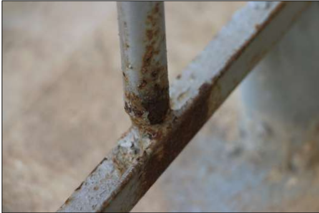
Fotografía 391 Fotografía 296. Detalle de unos elementos metálicos dentro de la malla de contención, instalada a espaldas de uno de las canchas deportivas, dentro del polideportivo. Se evidenció en esta obra la lesión descrita en imágenes anteriores.
