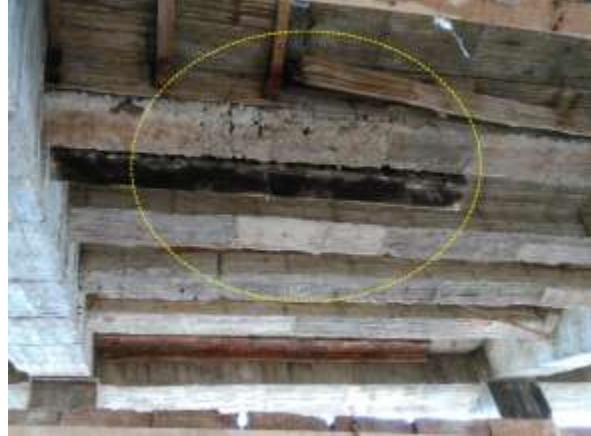
Fotografía 434 Presencia de hormigueros e incumplimiento del recubrimiento mínimo del refuerzo,
