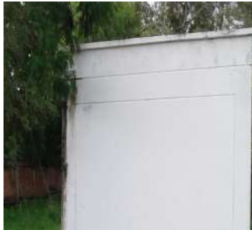
Fotografía N° 495. Grietas pared baños
