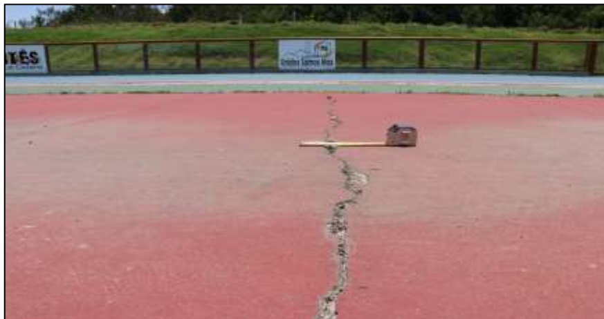
Fotografía 204. Detalle de otra sección de la pista de hockey. Evidencia de grieta transversal al sentido largo de este escenario.
