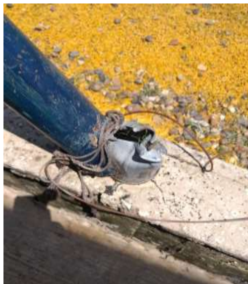
Fotografía 26 Sin tubería de soporte de malla
