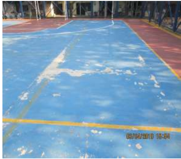
Fotografía 137. Muestra desprendimiento de pintura de la cancha multifuncional
