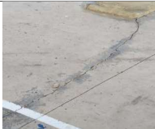
Fotografía 51 Grieta transversal de placa de piso
