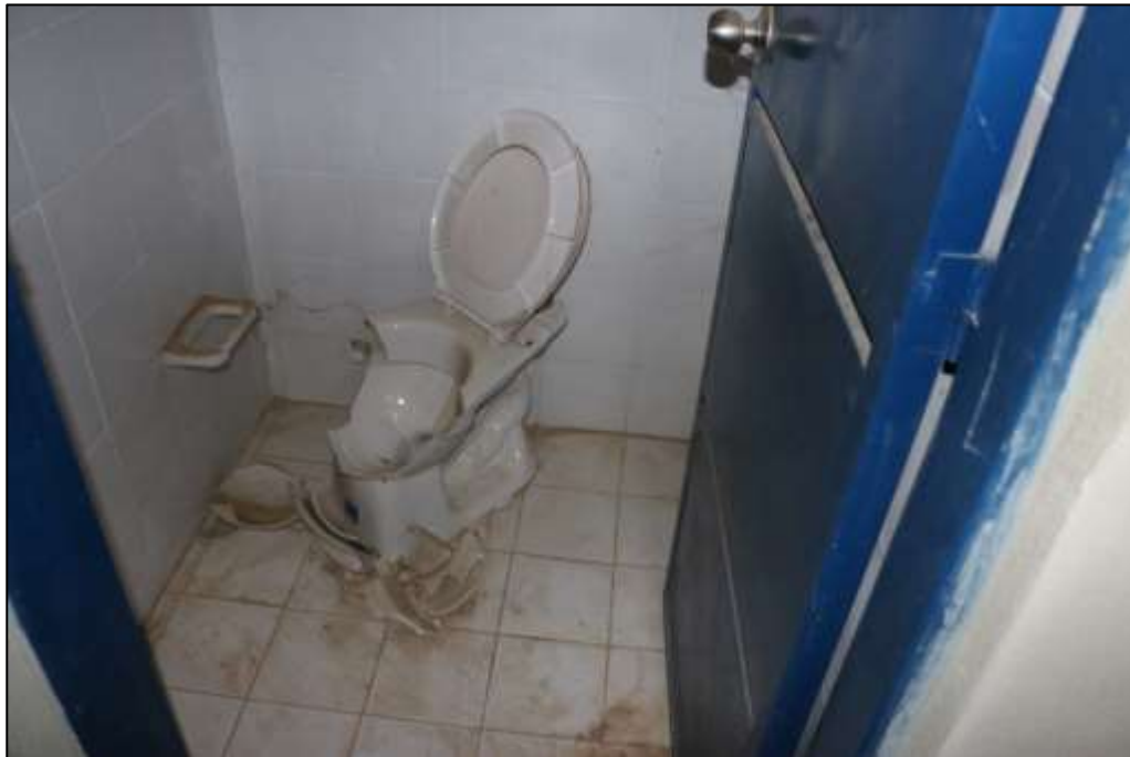
Fotografía 413 Detalle de un sanitario ubicado en uno de los baños, localizado bajo las graderías construidas. Como ya se ha mencionado, la CGR evidenció varios de los aparatos sanitarios, instalados por el contratista, destruidos por el vandalismo y el abandono de la Alcaldía.
