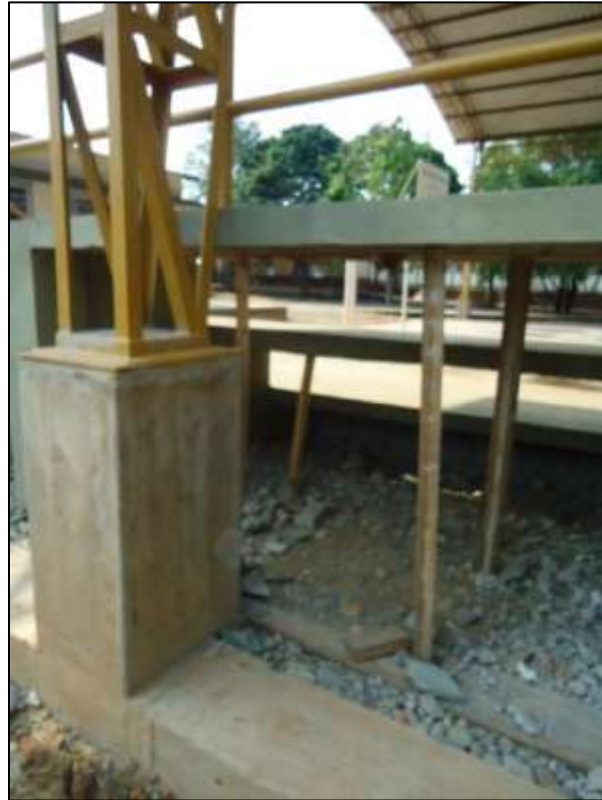
Fotografía 234. Vista general posterior de un tramo de la gradería construida. En esta imagen se evidencian los puntales de madera instalados bajo las placas de las graderías
