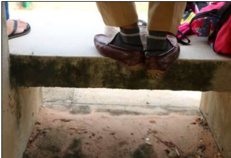
Fotografía 338 Detalle de una sección de placa como grada (graderías construidas en este escenario deportivo). Se evidencia la situación ya descrita
