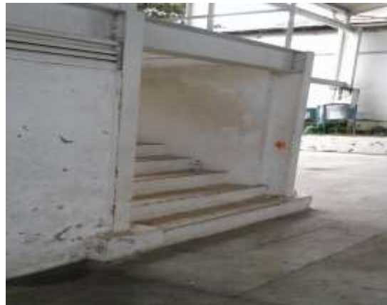
Fotografía N° 487. Falta de pintura y deterioro pared Polideportivo
