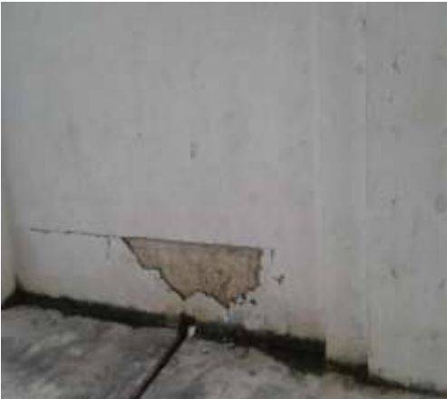
Fotografía N° 486. Deterioro pared polideportivo
