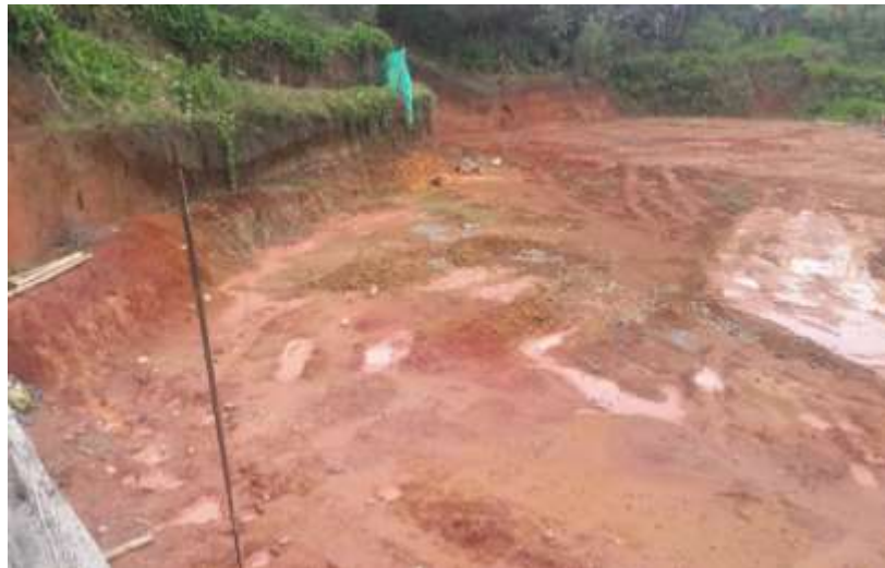
Fotografía N° 554. Pista de patinaje Municipio de Sevilla, suspendida desde el 02 de noviembre de 2018, por falta de interventoría. Foto tomada por el auditor abril de 2019.
