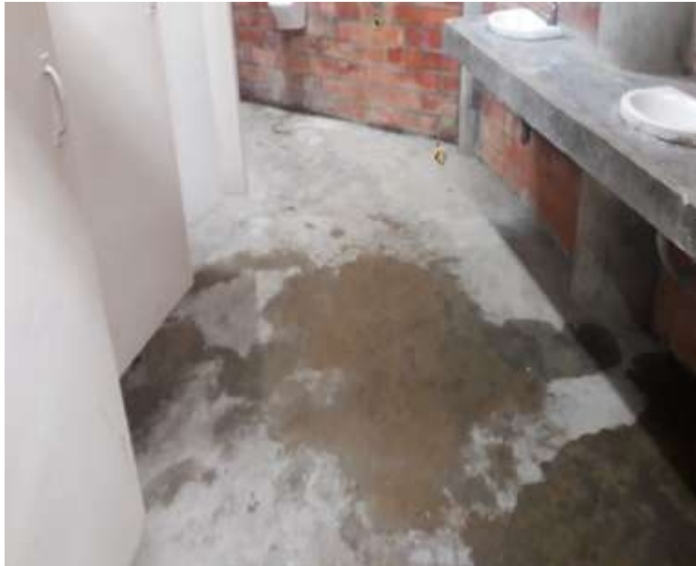
Fotografía N° 564. Humedades en el interior del Domo por falta de la cubierta. Foto tomada por el Auditor el 04 de abril de 2019.
