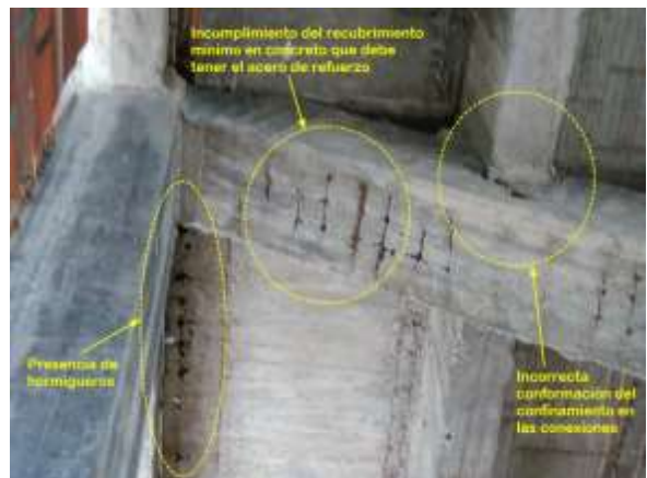
Fotografía 430 Hormigueros, incumplimiento del recubrimiento del refuerzo e incorrecta conformación del confinamiento en conexiones.
