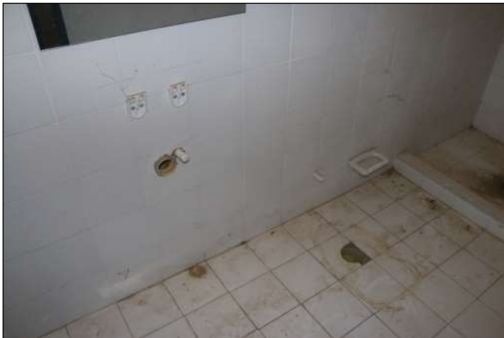
Fotografía 408 Detalle de la ubicación de un lavamanos, en uno de los baños adecuados bajo las graderías. En la imagen se observan aun instalados los accesorios para instalar el lavamanos, así como las salidas hidráulicas (suministro a la derecha y desagüe a la izquierda).
