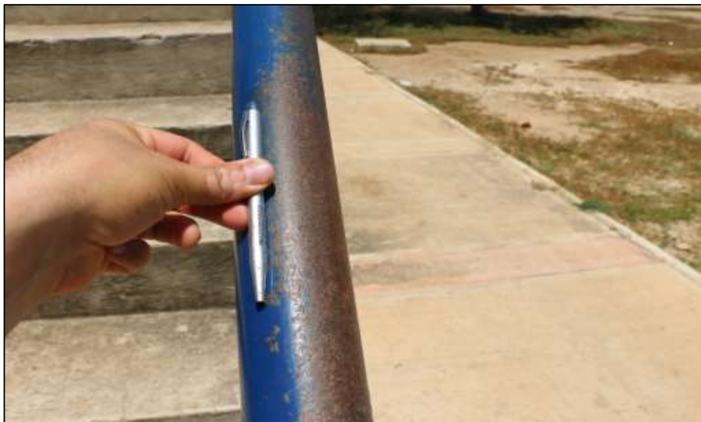
Fotografía 414 Detalle de una sección de la baranda instalada, en las graderías construidas (en la imagen, la baranda de una de la escalera sur). La baranda evidenció oxidación y pérdida parcial de la pintura de acabado.
