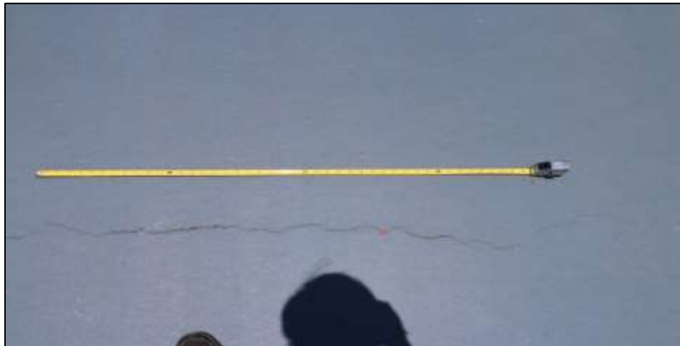
Fotografía 196. Detalle de otra sección de la pista de patinaje (patinódromo). Evidencia de otra fisura longitudinal.
