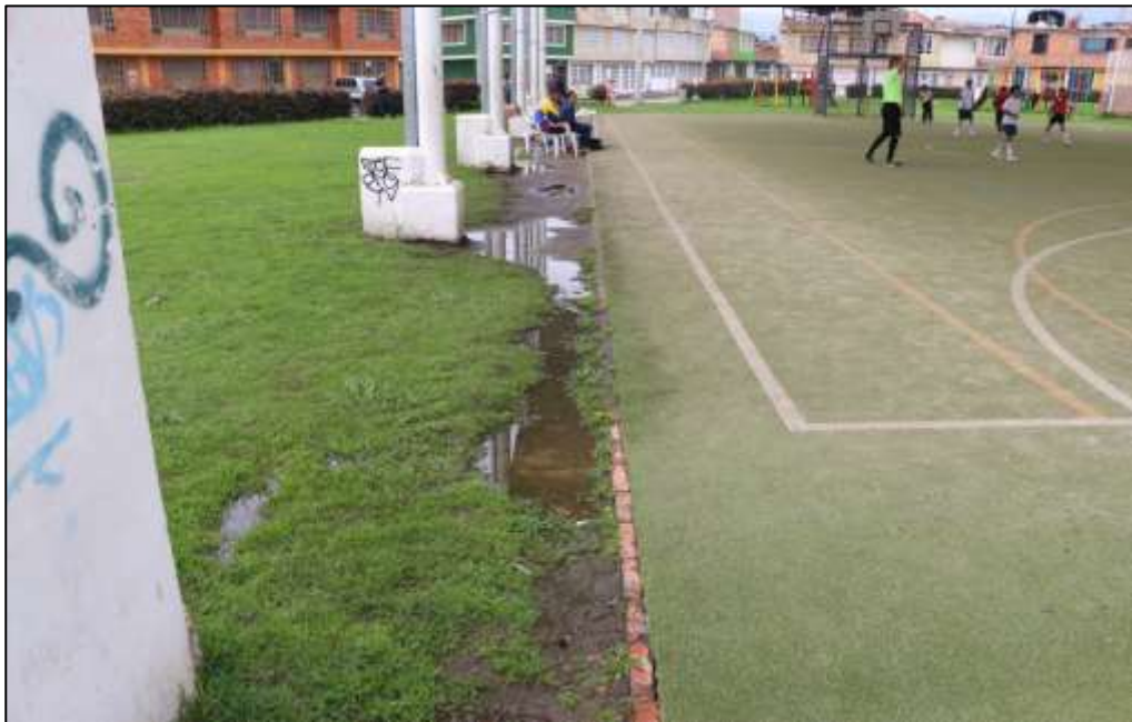
Fotografía 283. Vista general de unos de los costados largos de este polideportivo (detrás de uno de los arcos instalados). Durante el recorrido se evidenció agua estancada, por dificultad del escenario en evacuar el agua de escorrentía.
