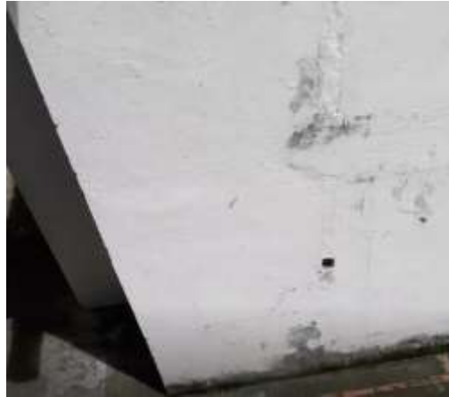
Fotografía N° 485. Pared agrietada del Polideportivo
