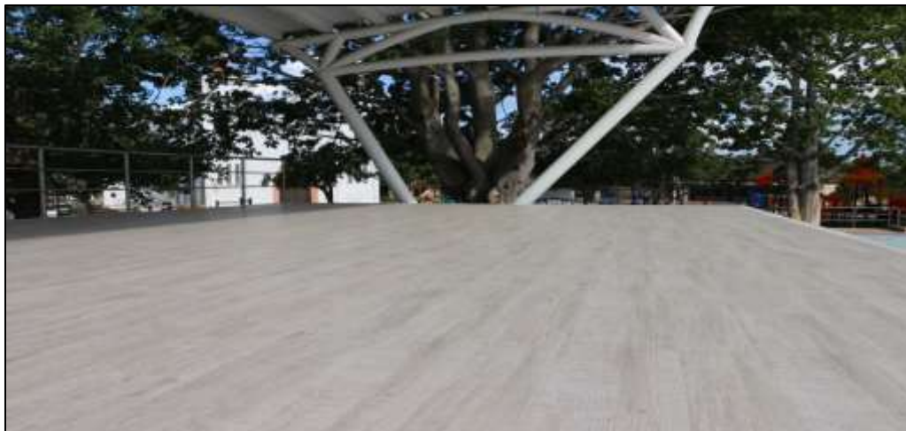
Fotografía 420 Vista general interna de la tarima. El área medida por la CGR, en compañía de la Secretaria de Planeación del municipio, correspondió al área cubierta por el enchape de piso.
