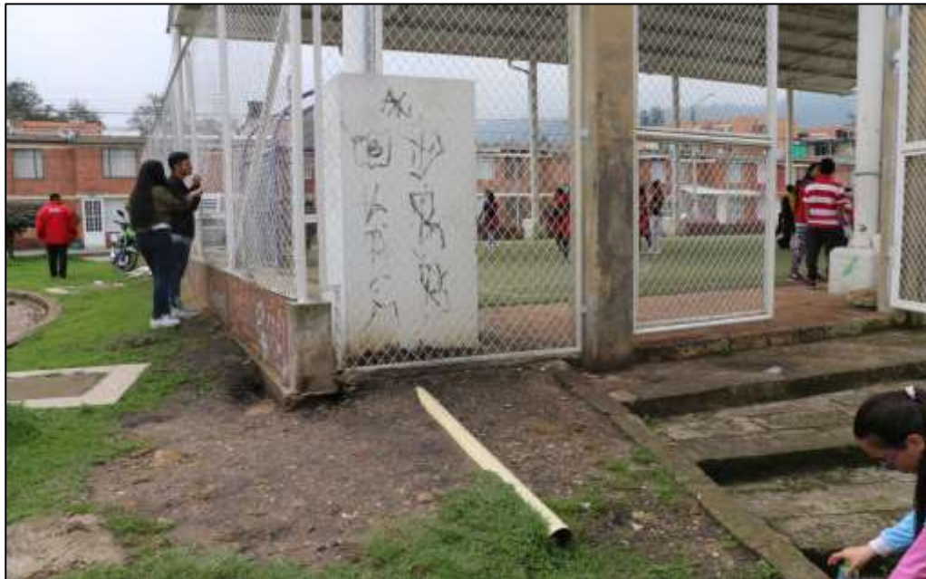
Fotografía 292. Detalle una de las tuberías de descarga del agua lluvia recogida por la cubierta (junto al acceso peatonal). Se evidenció esta tubería a la vista, la cual se encuentra desprotegida y susceptible de ser aplastada. Así mismo, la descarga del agua lluvia se realiza de manera directa a la superficie, sin ningún control.
