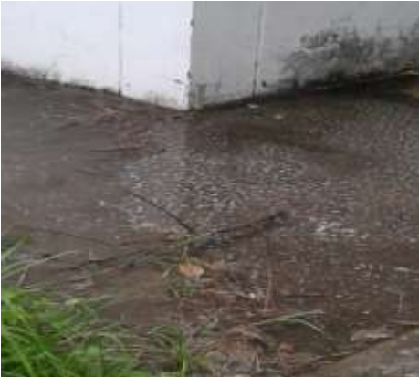
Fotografía N° 496. Corredores perimetrales inundados
