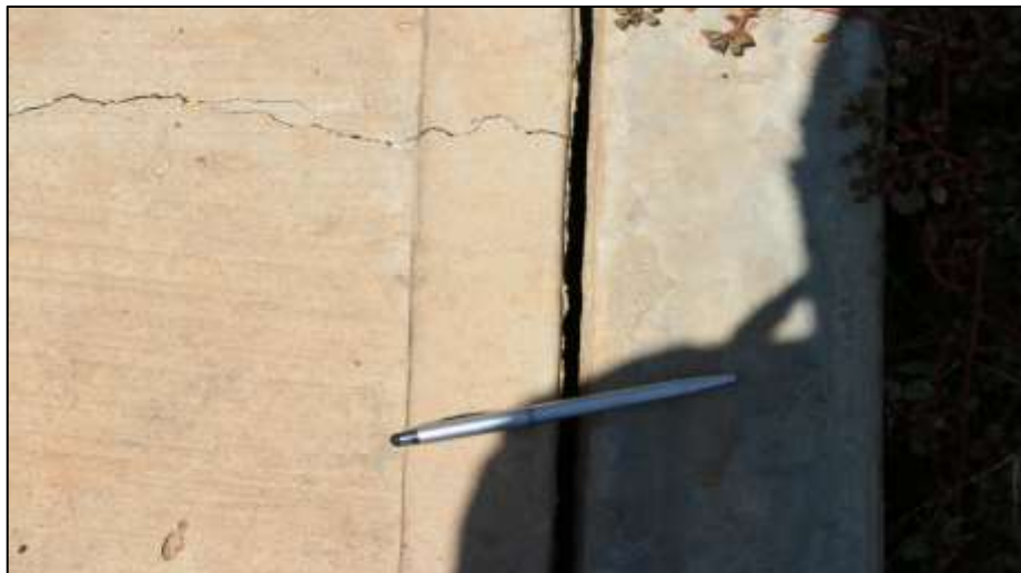
Fotografía 385 Detalle de la sección del andén perimetral, registrado en la imagen anterior. Según la escala utilizada en la imagen (esfero de ancho 10 mm), la dilatación generada entre bordillo y andén, es aproximadamente 15 mm. En la fotografía también quedó capturada una fisura transversal.
