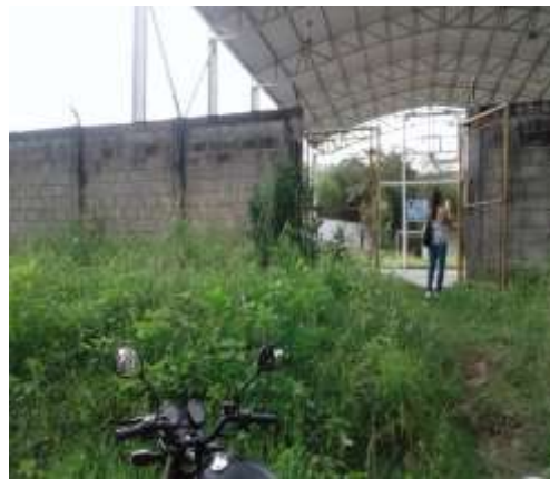
Fotografía N° 509. Puerta de ingreso sin seguridad alguna y en estado de oxidación
