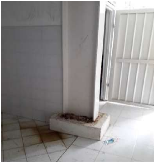
Fotografía N° 482. Oxidación Perfil metálico, Sector Baños
