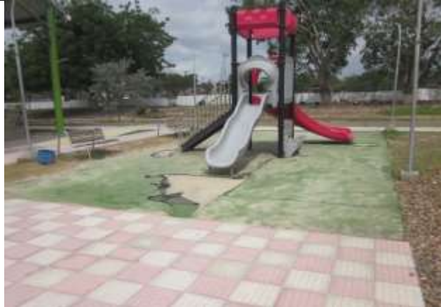
Fotografía 1 Recubrimiento zona infantil en mal estado
