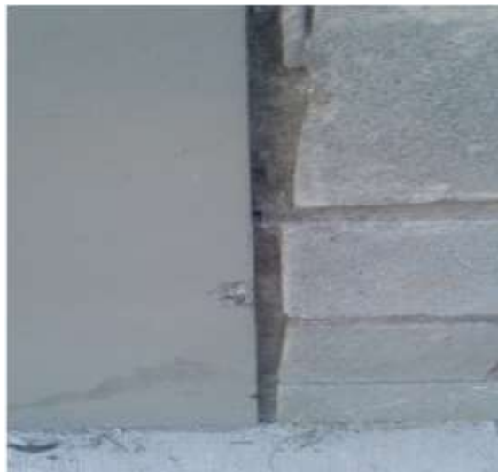
Fotografía N° 479. Acabado irregular costado de las escaleras
