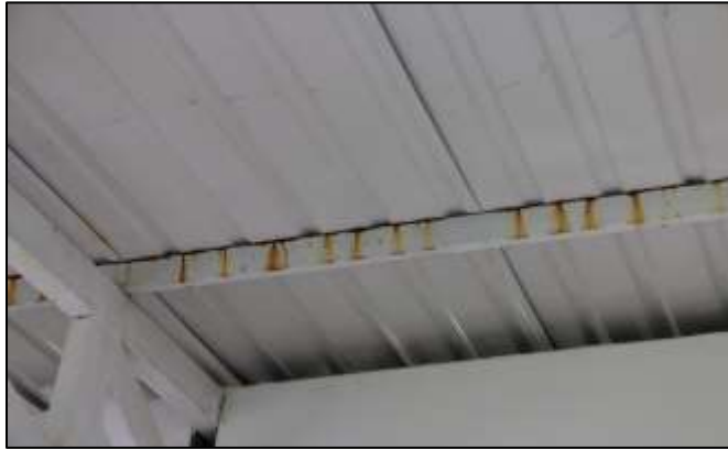
Fotografía 243. Detalle de una de las correas metálicas, instaladas en la cubierta de este escenario deportivo. Se evidencia la huella de óxido dejada sobre una de las caras de este elemento metálico, debido a filtración de agua lluvia desde la cubierta. Esta lesión se evidenció a lo largo de las correas, en especial sobre el costado hacia el embalse del Muña.
