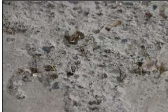
Fotografía 252. Detalle de la sección de concreto registrada en la imagen anterior. Debido a la baja calidad de la mezcla, la superficie del concreto ha sido lavada y parcialmente levantada, dejando expuesto al agregado fino y grueso de la mezcla.
