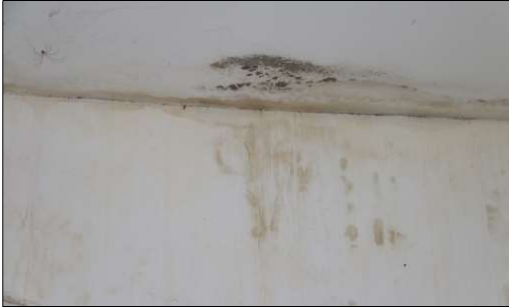
Fotografía 357 Detalle de la esquina superior de otro de los espacios adecuados, dentro del edificio administrativo. La superficie del muro y el cielo raso en este sitio, evidencian manchado diferencial por lavado y humedad.
