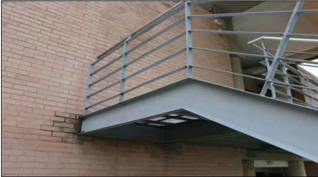
Fotografía 156. Vista general de una sección de escalera anclada a la fachada norte de la edificación. Las fachadas evidencian lavado diferencial.
