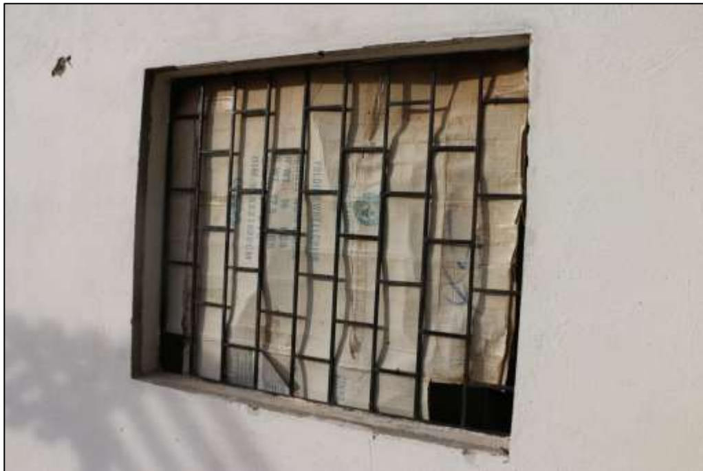
Fotografía 360 Detalle de una de las ventanas adecuadas en el edificio administrativo (vista desde afuera del edificio). En varias de estas ventanas, se evidenció la ausencia del vidrio y la instalación de un cartón, como elemento de protección.
