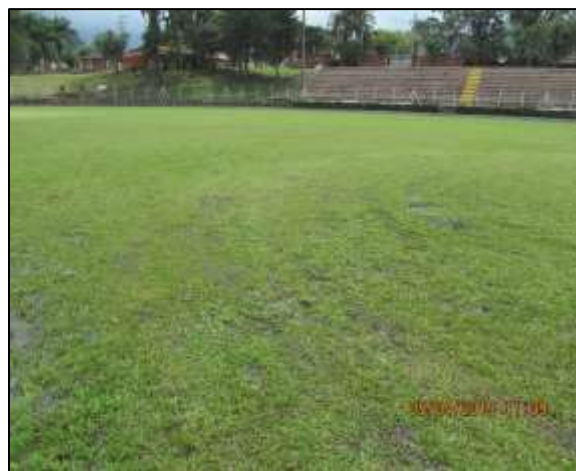
Fotografía 226. Vista general de otra sección de la zona central de la cancha de fútbol. Se evidenció la misma lesión ya descrita, en la obra construida.
