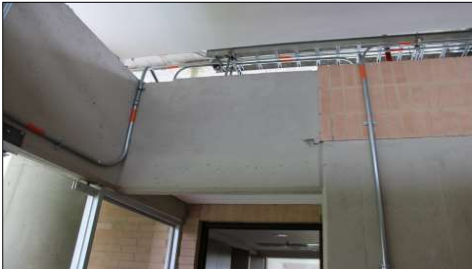
Fotografía 152. Vista general de un dintel ubicado al lado de la salida de emergencia, en el cuarto piso. En este sitio y en vecindades, se evidenciaron fisuras y desportillamientos en el concreto.
