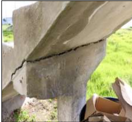
Fotografía 262. Detalle del apoyo intermedio de la escalera de ingreso a una de las casetas. En este sitio se evidenció que la placa de concreto está dilatada en más de 2 cm, situación que genera discontinuidad del apoyo en este sitio. Así mismo, se evidenció huella de humedad y trazo de eflorescencia de sal, bajo la placa de concreto.
