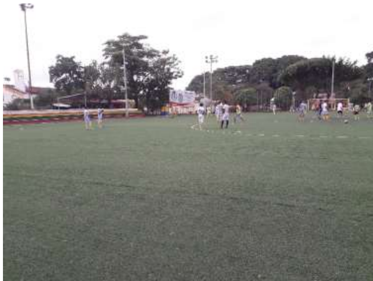
Fotografía N° 528. Levantamiento en pegues o uniones de la grama sintética polideportivo 14 de octubre
