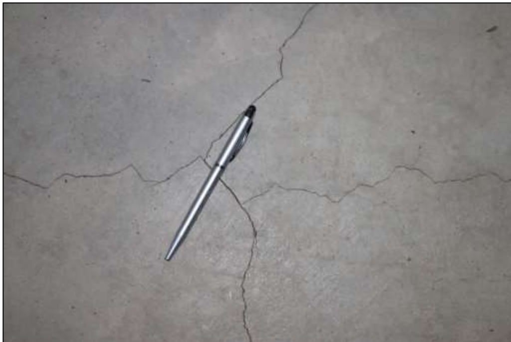
Fotografía 381 Detalle de otra de las fisuras interconectadas, evidenciadas en la superficie del pavimento construido como placa de contra piso, en el pasillo adecuado entre camerinos.
