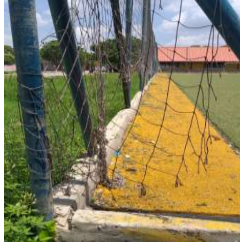
Fotografía 21 Malla totalmente deteriorada, así como superficie sintética de piso
