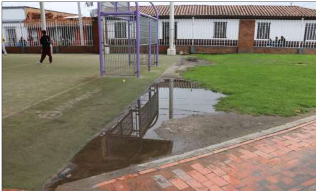
Fotografía 289. Vista general de unos de los costados cortos de este polideportivo (detrás de uno de los arcos instalados). Durante el recorrido se evidenció agua estancada, por dificultad del escenario en evacuar el agua de escorrentía. Se evidenció que las bajantes de la cubierta descargan el agua de manera directa a la superficie, sin ningún control.
