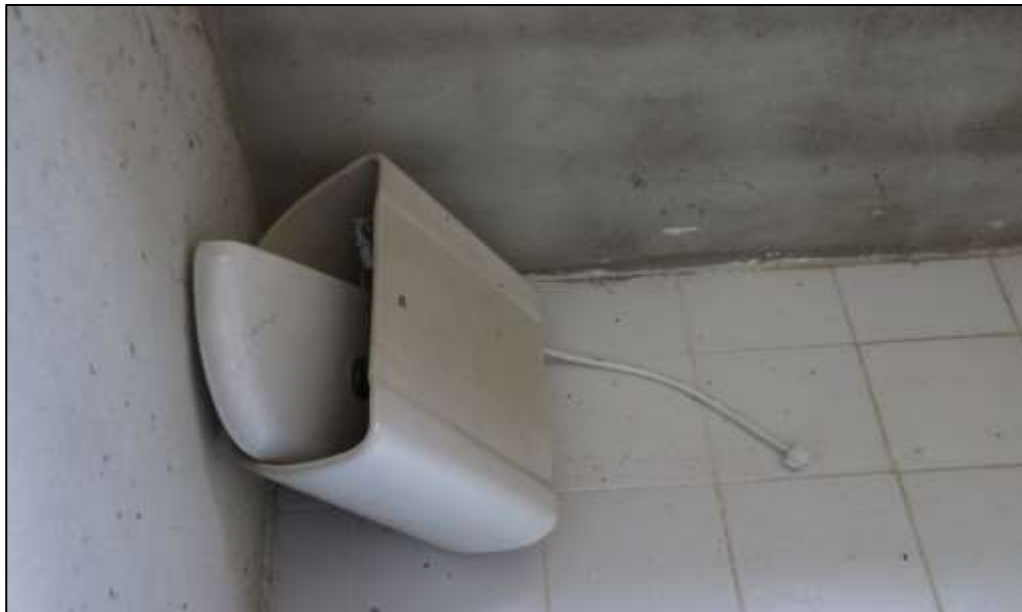
Fotografía 402 Detalle del tanque de un sanitario, desinstalado en uno de los baños adecuados en el edificio administrativo del polideportivo. En la imagen se observa la situación ya descrita.
