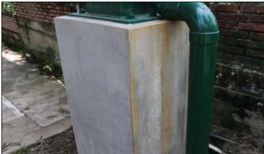
Fotografía 212. Detalle de otro de los dados de concreto. Así mismo, se evidenció manchado de óxido, transportado en el agua de escorrentía.
