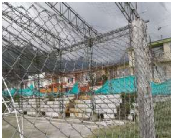
Fotografía N° 467. Sellamiento de obra Jaramillo Líbano – Tolima. Inadecuado con rotura y deterioro.
