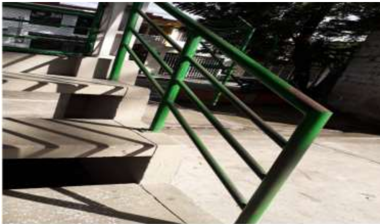
Fotografía N° 548. Baranda gradería oxidada
