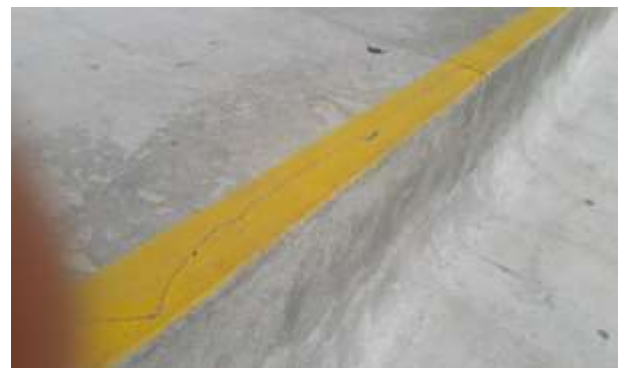
Fotografía N° 569. Degradación de los bordes
