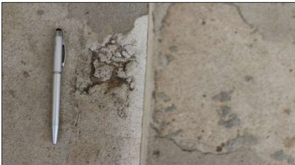
Fotografía 373 Detalle de una sección de material desagregada, evidenciada en el concreto de las graderías (vista en planta). La mezcla de concreto en general, evidenció problemas de continuidad en su adherencia y falta de uniformidad.
