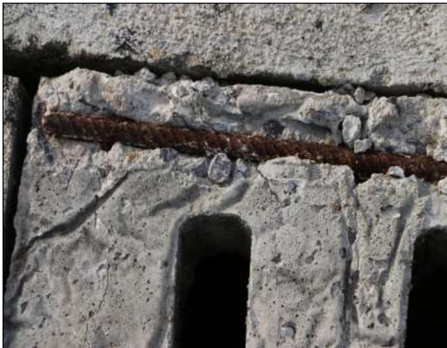
Fotografía 330 Detalle de una sección del elemento presentado en la imagen anterior. En la imagen se observa el acero de refuerzo longitudinal a la vista. Así mismo, en estos elementos se observó el concreto desportillado y parcialmente desagregado.
