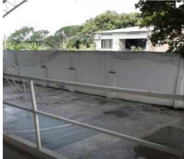
Fotografía N° 491. Encharcamiento cancha del polideportivo
