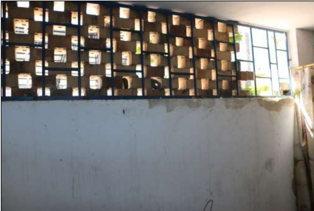
Fotografía 163. Detalle de otro de los muros perimetrales del espacio adecuado bajo la tarima al aire libre (pasillo). En esta zona se evidenció pérdida parcial de los ladrillos de revestimiento de la ventana registrada en la imagen.
