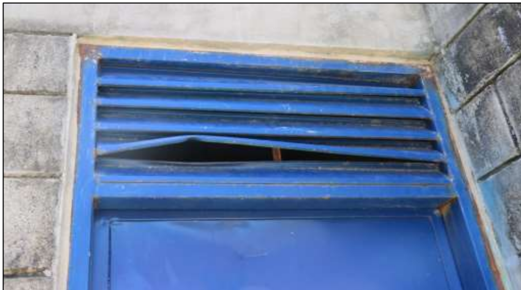
Fotografía 410 Detalle de la rejilla ubicada en la parte superior de una parte, localizada sobre la zona posterior de las graderías construidas. Como se observa en la imagen, uno de los elementos de esta rejilla se encuentra deformado por impacto.
