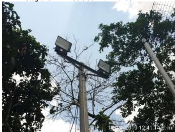
Fotografía 127. Poste con Luminarias.
