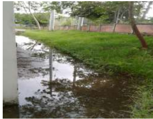
Fotografía N° 497. Corredores y andenes periféricos inundados
