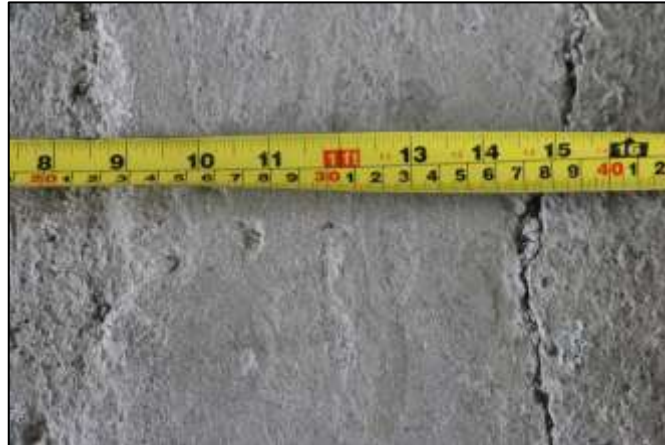
Fotografía 249. Detalle de otra fisura registrada en la placa de concreto. En la imagen se evidencia la lesión ya descrita.
