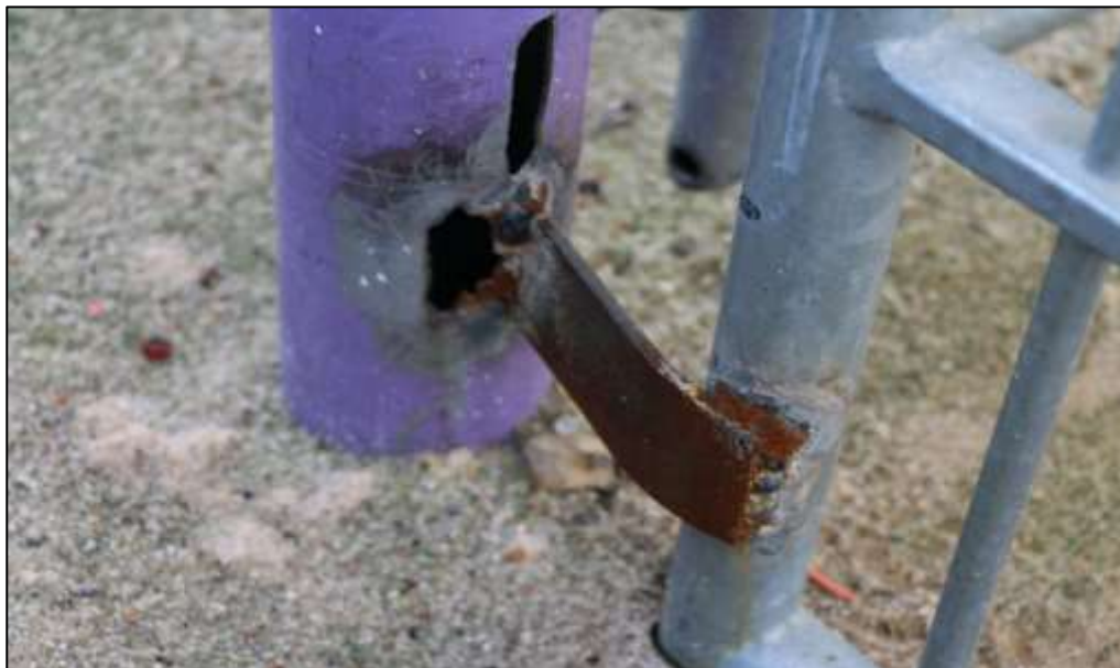
Fotografía 274. Detalle de otra conexión interior entre elementos metálicos, en la estructura de uno de los arcos de fútbol. Se evidencia la misma lesión ya descrita. Adicional a lo anterior, se evidencian reparaciones de baja calidad técnica, debido a la presencia de oxidación sobre el elemento de conexión y pérdida de sección metálica del elemento a conectar.
