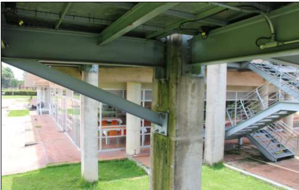
Fotografía 159. Vista general de una de las columnas de apoyo de la rampa de emergencia, en la zona de conexión del entre piso metálico. Se evidencia la presencia de materia orgánica y acumulación de humedad, en la superficie de las columnas de concreto. Esta situación evidencia falta de mantenimiento general de estas obras y debilidad constructiva, en tanto no se consideró un adecuado manejo del agua lluvia de escorrentía.
