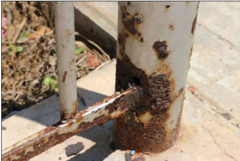
Fotografía 418 Detalle de la unión entre elementos metálicos, de otra de las mallas contra impacto, instaladas en este escenario. En la imagen quedaron registradas las lesiones evidenciadas en estos elementos metálicos, descritos en la fotografía anterior.
