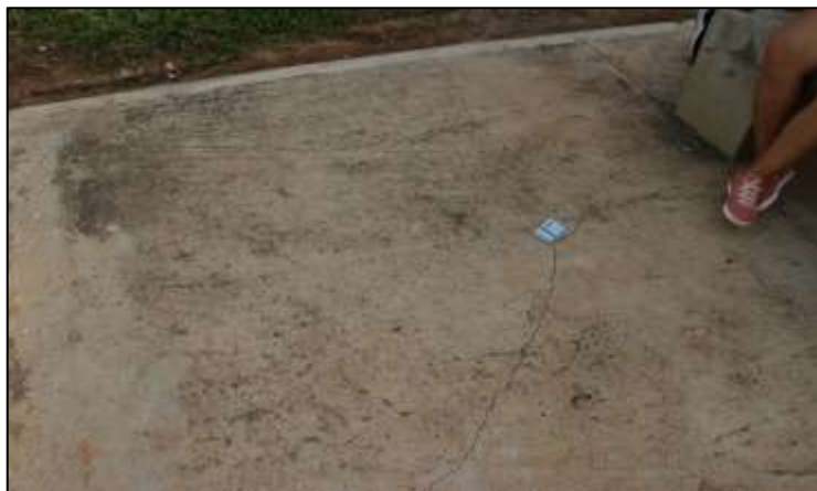
Fotografía 339 Vista general de una sección de la placa de contra piso, en concreto, construido en la zona de las graderías. En este concreto, se evidenciaron fisuras diagonales.
