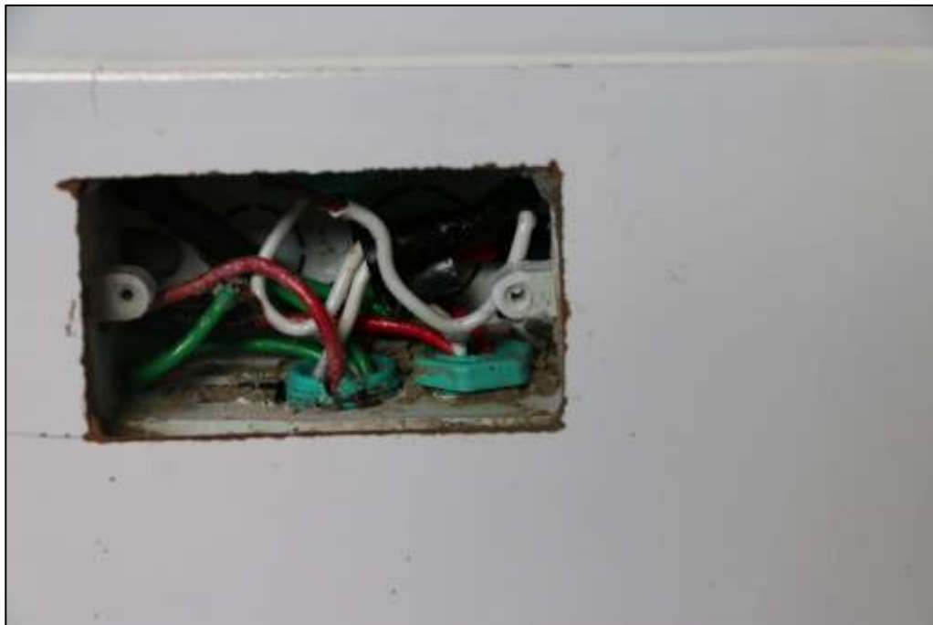
Fotografía 403 Detalle de una salida eléctrica, en uno de los baños adecuados en el edificio administrativo del polideportivo. Otra situación evidenciada por la CGR, es la ausencia de los apliques de algunas salidas eléctricas.
