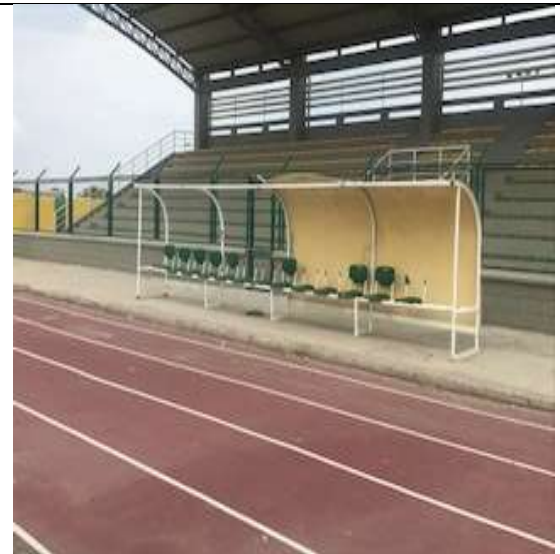
Fotografía 298 Bancas técnicas en mal estado
