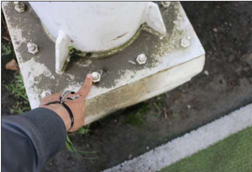
Fotografía 269. Detalle de la conexión metálica de una de las columnas de la estructura de cubierta en su pedestal de concreto. Se evidencia manchado y lavado diferencial, así como presencia de materia vegetal, todo lo anterior sobre los elementos metálicos.
