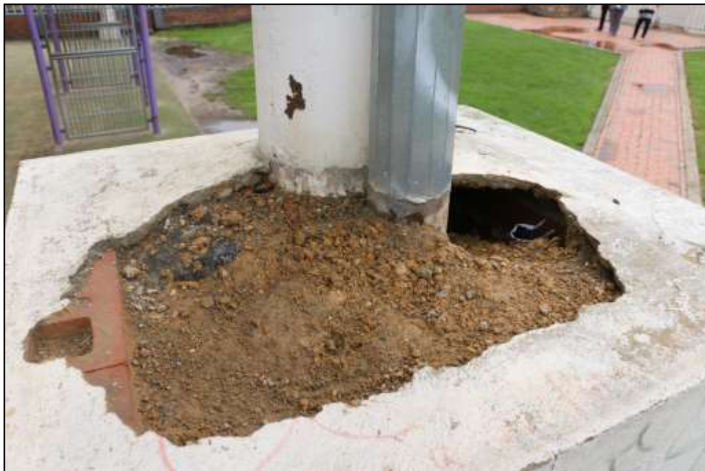
Fotografía 287. Detalle de una de las bajantes instaladas entrando en la caja de mampostería construida. Se evidencia la ejecución de una caja de mampostería, desportillada y con elementos desprendidos.
