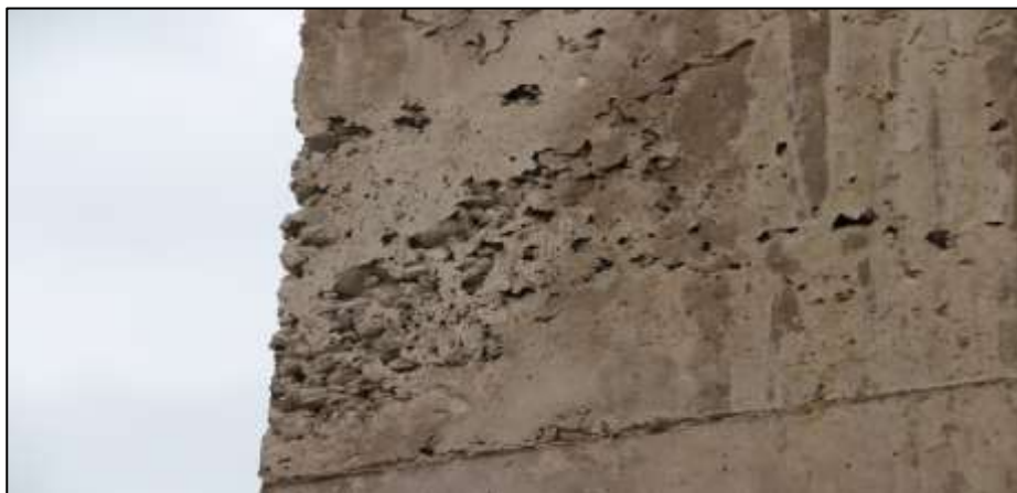
Fotografía 186. Detalle de la superficie de una de las columnas de concreto construidas en este polideportivo. Estos elementos evidencian hormigueo y agregado a la vista. Lo anterior, ocasionado por problemas constructivos (debilidad en el vibrado y homogenización de la mezcla).
