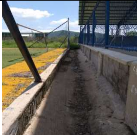
Fotografía 23 Canal de desagüe con sedimentos, sin tubería de soporte de malla
