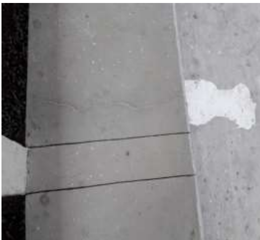
Fotografía N° 544. Gradería agrietada y levantada
