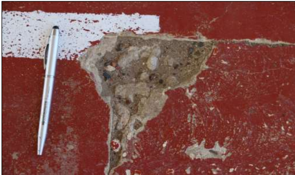
Fotografía 368 Detalle de una sección superior, del pavimento de concreto de la cancha multideportiva (vista en planta). Otra de las lesiones evidenciadas, consiste en el desprendimiento de sección de concreto, desagregación de la mezcla y agregado a la vista.
