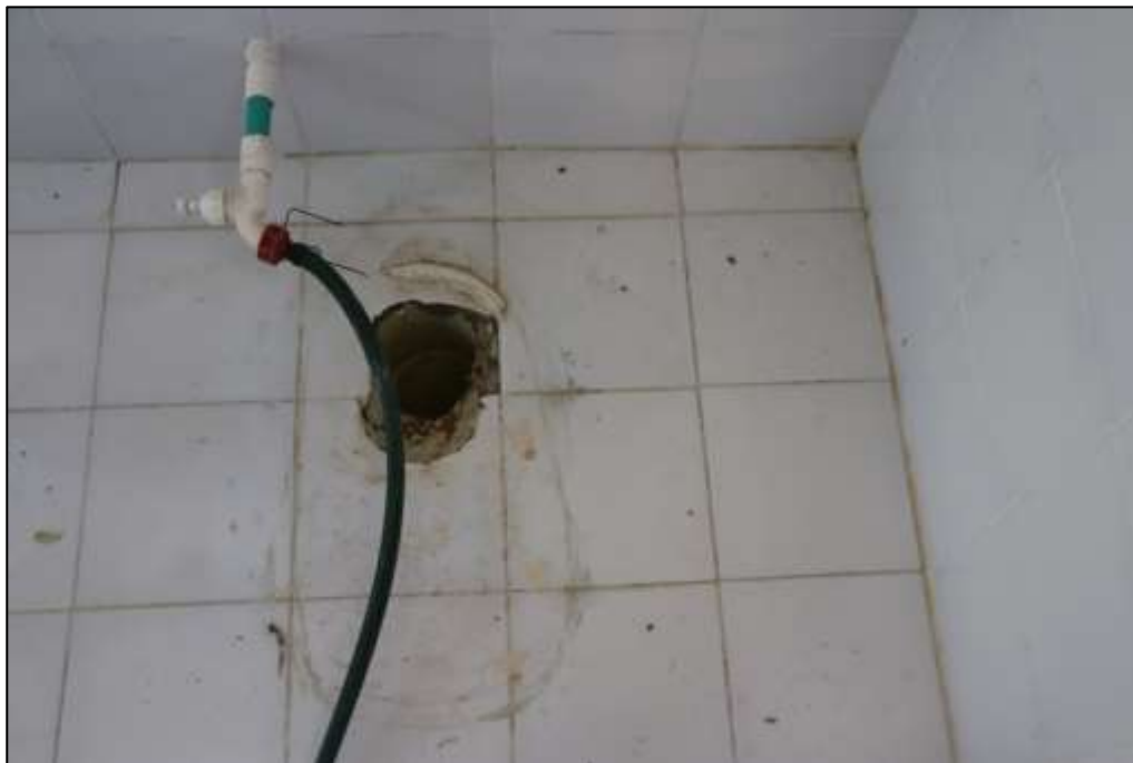
Fotografía 400 Detalle del lugar donde estaba instalado un sanitario, en uno de los baños adecuados en el edificio administrativo del polideportivo. Como ya se mencionó, se evidenció la ausencia (por desinstalación) de varios aparatos sanitarios, como el inodoro faltante de la imagen.
