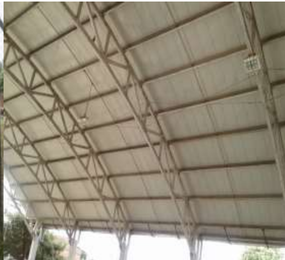
Fotografía N° 523. Estructura de cubierta en estado de oxidación
