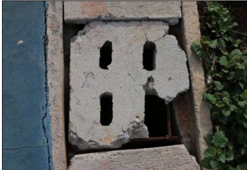
Fotografía 331 Detalle de una sección de cuneta perimetral, ubicada en la zona interna de la pista de patinaje (patinódromo). En este sitio, en donde se había instalado una tapa de concreto, la misma evidencia fractura y pérdida parcial del concreto. Así mismo, el acero de refuerzo está a la vista y totalmente oxidado.
