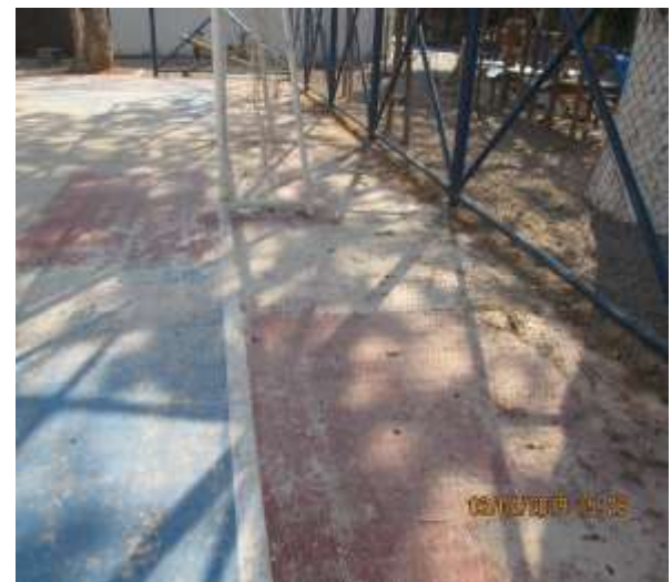
Fotografía 142. Muestra desgaste de pintura de la cancha multifuncional.
