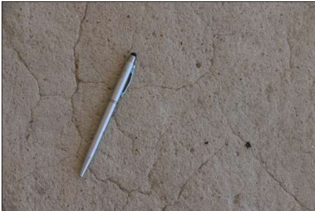
Fotografía 382 Detalle de unas fisuras interconectadas, evidenciadas en la superficie de las gradas.
