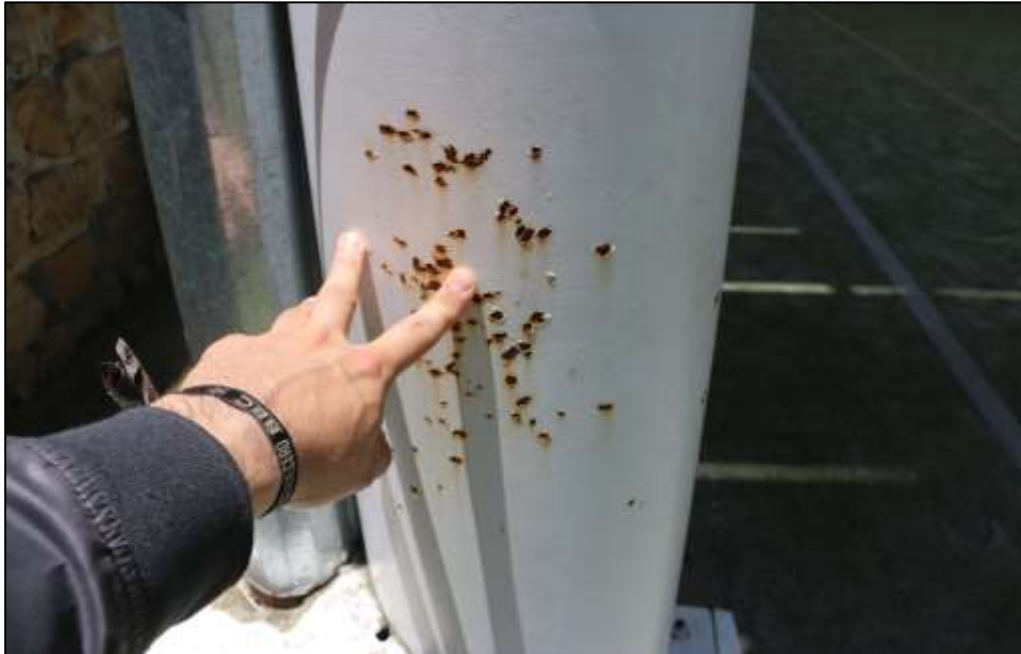
Fotografía 276. Detalle de una sección de una de las columnas metálicas, instaladas en este polideportivo. Como se aprecia en la imagen, la superficie de este elemento evidencia picadura de óxido, concentrada en el sitio registrado en la imagen.
