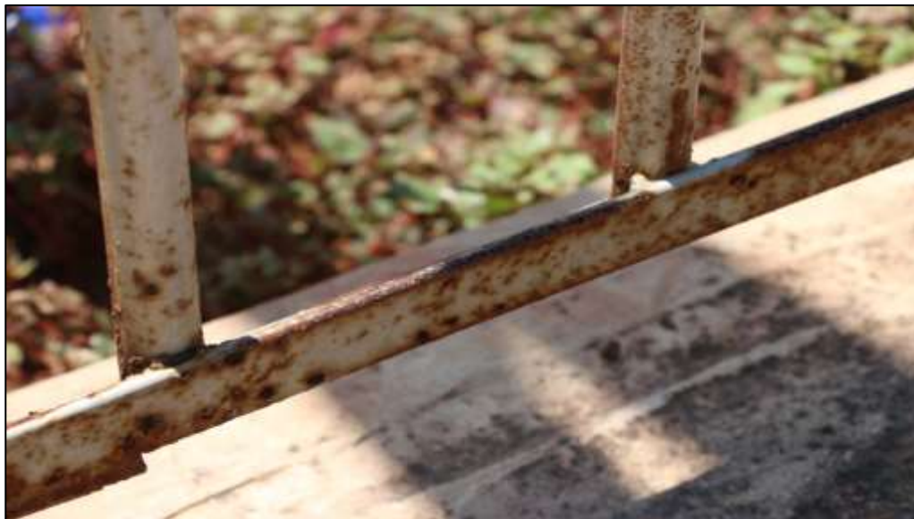
Fotografía 417 Detalle de la unión entre elementos metálicos, de una de las mallas contra impacto, instaladas en este escenario. Estos elementos evidenciaron oxidación profunda generalizada, pérdida parcial de la pintura de acabado (en algunas zonas por presencia de ampollas) y en algunas secciones, corrosión.
