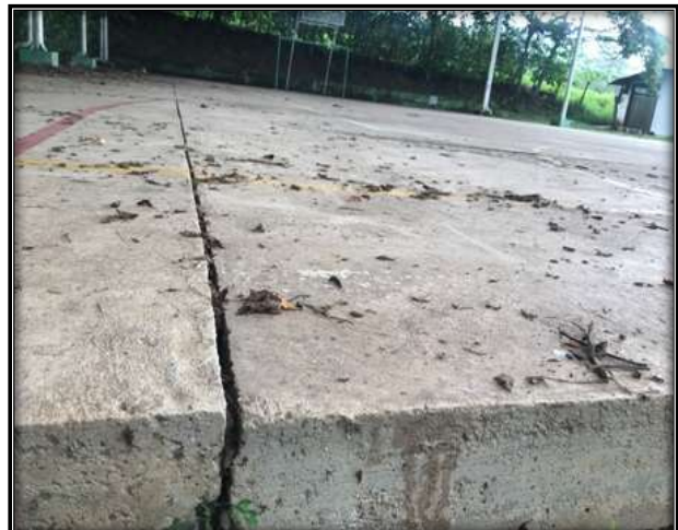
Fotografía N° 537. Evidencia severo aumento tamaño dilataciones
