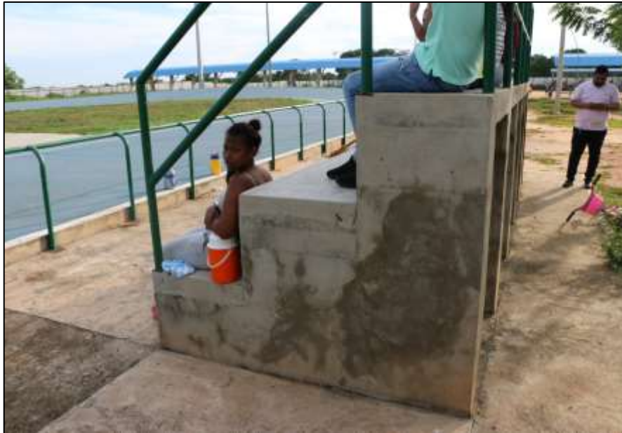
Fotografía 336 Vista general lateral de uno de los muros de soporte, de una de las graderías construidas en este escenario deportivo. El pañete de estos muros, evidencia humedad acumulada y huella de reparaciones antiguas.
