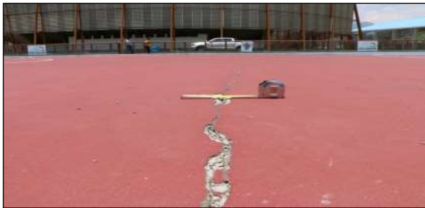
Fotografía 206. Detalle de otra sección de la pista de hockey. Evidencia de grieta transversal al sentido largo de este escenario.
