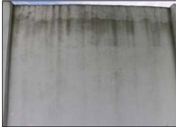
Fotografía 255. Vista general de uno de los paños de mampostería, construido en los muros laterales de esta edificación (vista de la cara externo de este elemento). Los pañetes de estas estructuras evidenciaron fisuras interconectadas en formato de “piel de cocodrilo”, así como lavado diferencial de la superficie. Se evidenció además la ausencia de la viga superior de confinamiento de los muros.
