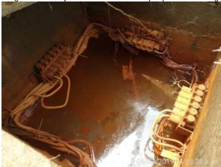
Fotografía 120. Caja eléctrica en deterioro por presencia de agua
