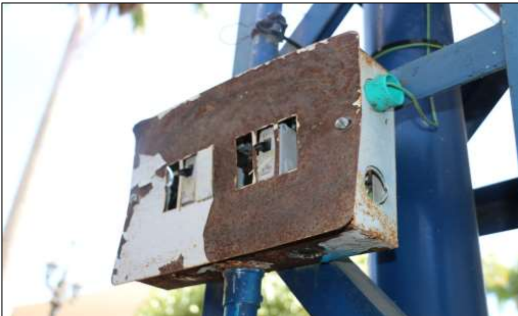
Fotografía 170. Detalle del tablero eléctrico instalado en el polideportivo construido, para controlar la iluminación de dicho escenario.
