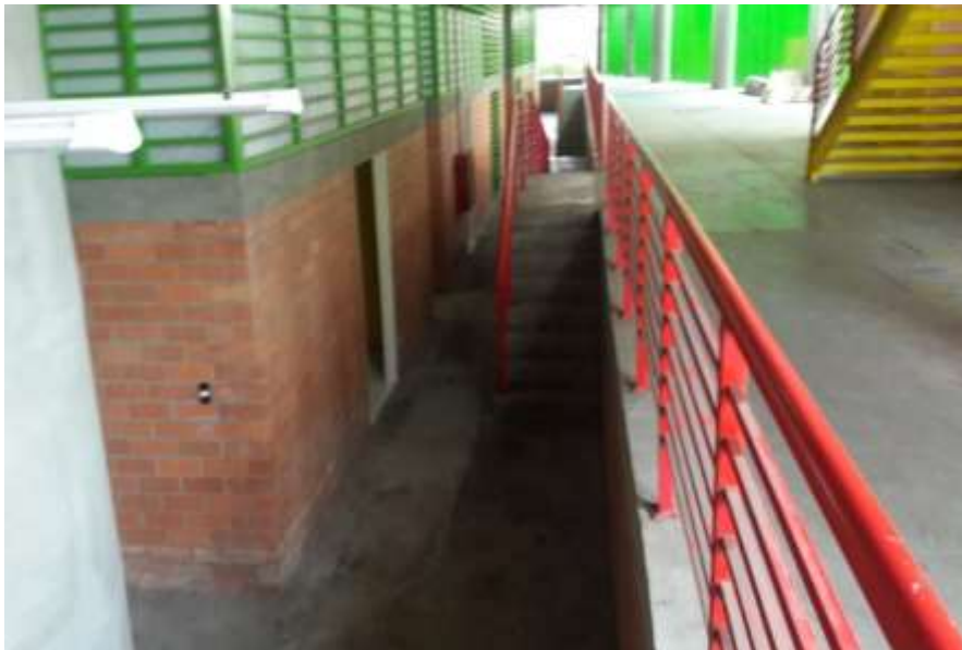
Fotografía N° 556. Baños bajo la gradería occidental que se inundan por capacidad insuficiente del canal exterior de recolección de aguas lluvias. Foto tomada por el auditor Abril de 2019.
