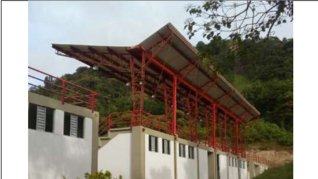
Fotografía 425 Las graderías del centro cuentan con cubierta y solo hay tres bajantes de aguas lluvias.
