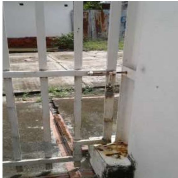
Fotografía N° 483. Proceso oxidación puerta Polideportivo
