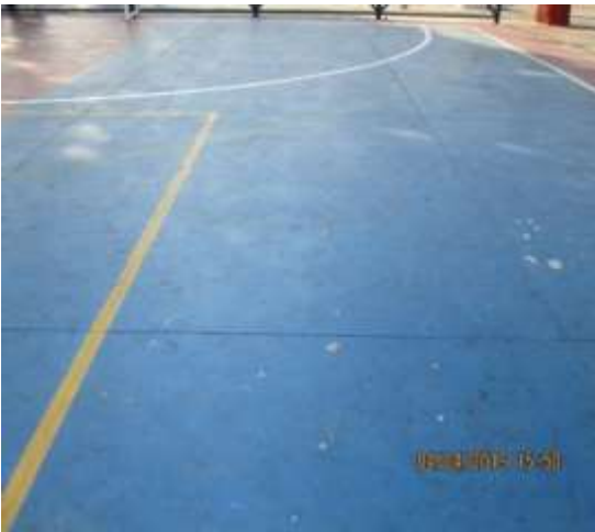
Fotografía 144. Muestra grieta longitudinal presentada en 3 losas de la cancha multifuncional
