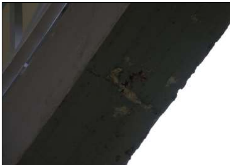
Fotografía 185. Detalle de la cara baja de otra viga aérea de concreto. En esta imagen quedó registrada la misma lesión ya descrita, con el adicional de estar parte del refuerzo transversal (estribo) a la vista.
