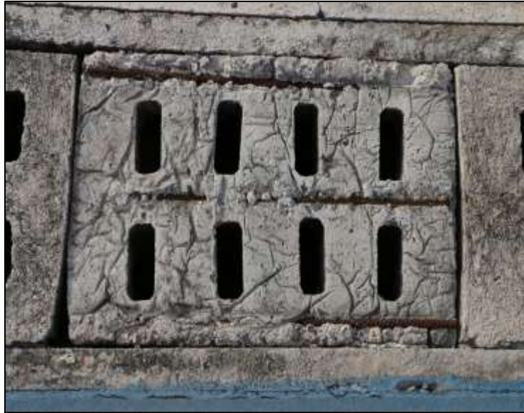
Fotografía 329 Detalle de una sección de cuneta perimetral, ubicada en la zona interna de la pista de patinaje (patinódromo). En varias secciones de esta obra, se evidenció pérdida parcial del concreto de recubrimiento, así como agregado y acero de refuerzo longitudinal a la vista. Este último ya evidencia oxidación profunda.
