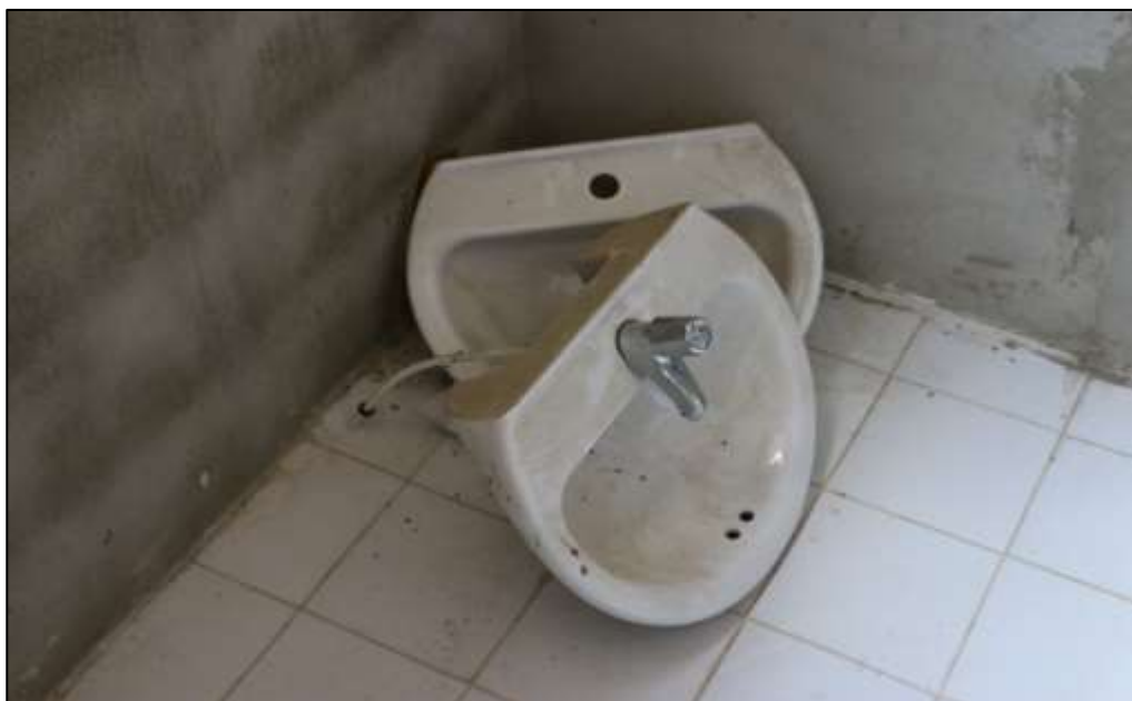
Fotografía 401 Detalle de un lavamanos desinstalado, en uno de los baños adecuados en el edificio administrativo del polideportivo. Al igual de lo ya descrito, se evidenciaron otros aparatos desinstalados y ubicados de cualquier manera, en los espacios internos de estos baños.
