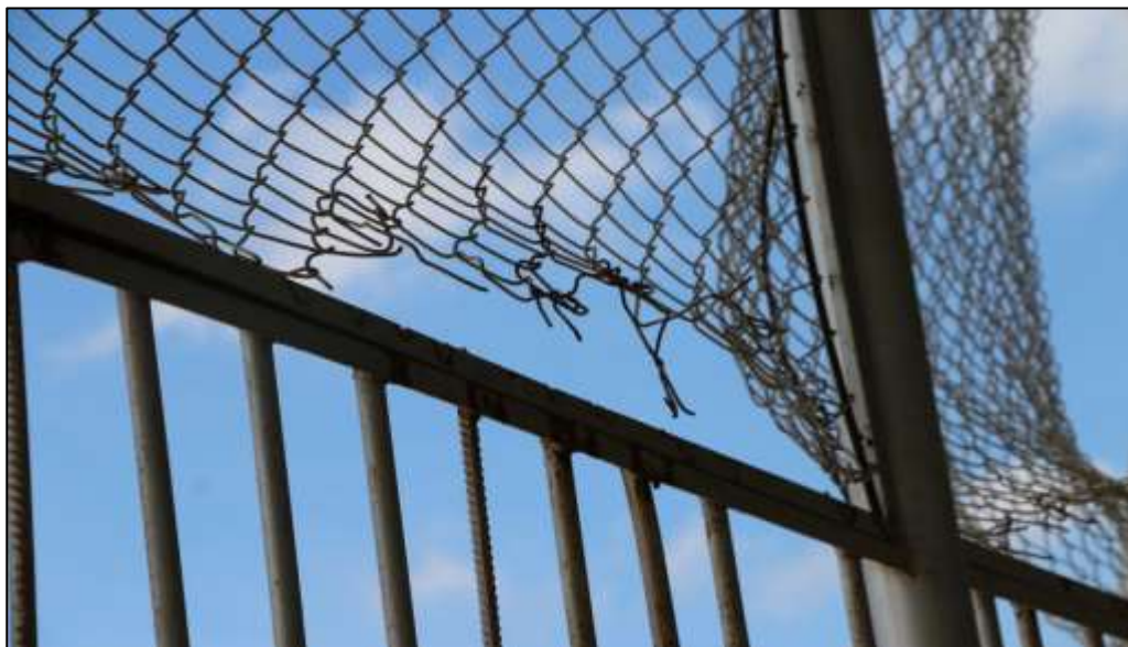
Fotografía 392 Detalle de una sección de la malla eslabonada, instalada como contención de balones (polideportivo). Este elemento se evidenció deteriorado, desprendido en algunas zonas de unión con los marcos metálicos y en algunos otros sitios, roto.
