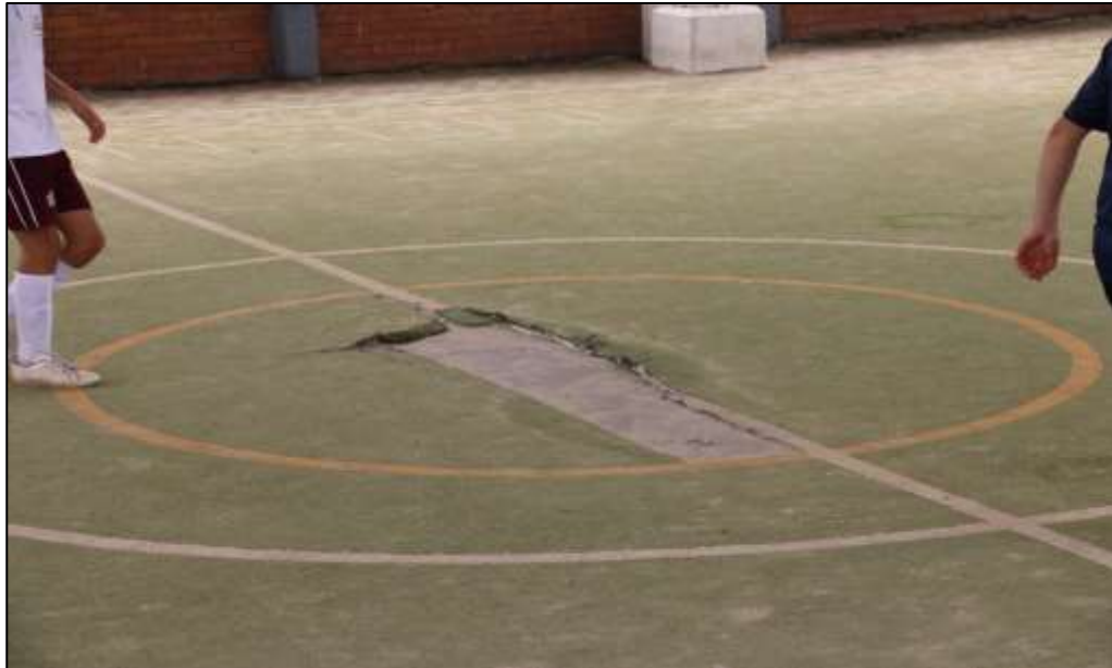
Fotografía 288. Detalle de la sección de grama sintética instalada en zona central de este escenario deportivo. En la imagen quedó registrado el estado en el cual se encontró esta obra. Según lo manifestaron los funcionarios de la alcaldía que acompañaron el recorrido, la grama rota se debe a actos de vandalismo.
