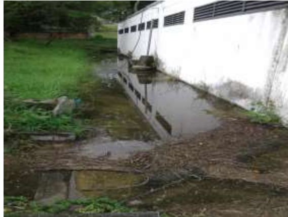
Fotografía N° 511. Anegación del área perimetral
