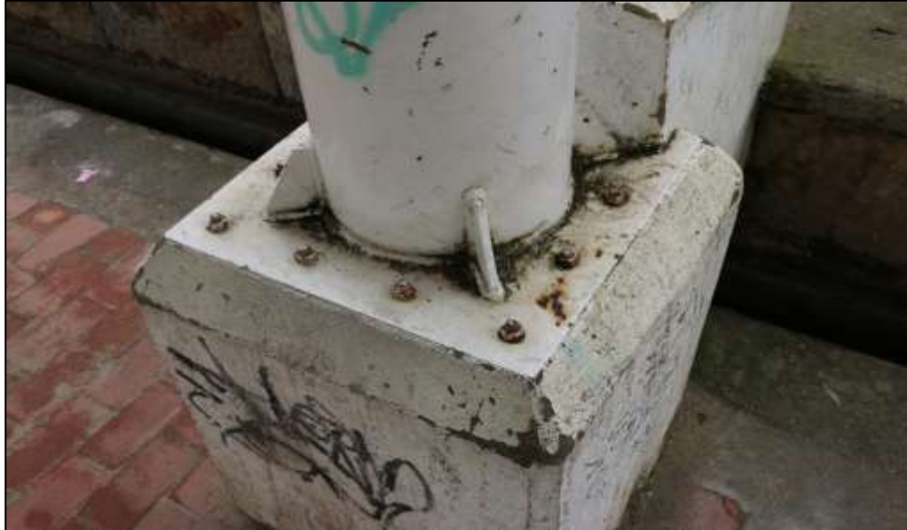
Fotografía 290. Detalle de la conexión metálica de una de las columnas de la estructura de cubierta, en su pedestal de concreto. Se evidenció en estos detalles constructivos, la presencia de óxido diferencial en la superficie de las platinas, tuercas y varillas roscadas.
