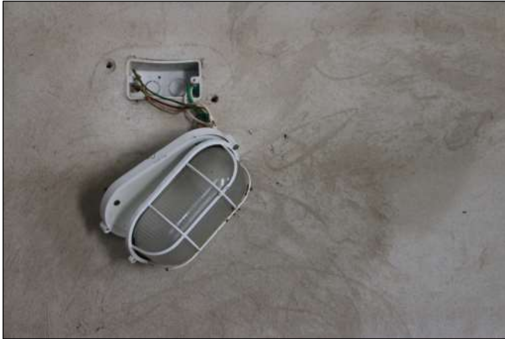
Fotografía 404 Detalle de una iluminación, en uno de los espacios adecuados en el edificio administrativo del polideportivo. Varias luminarias se evidenciaron descolgadas y en mal estado de uso y servicio.
