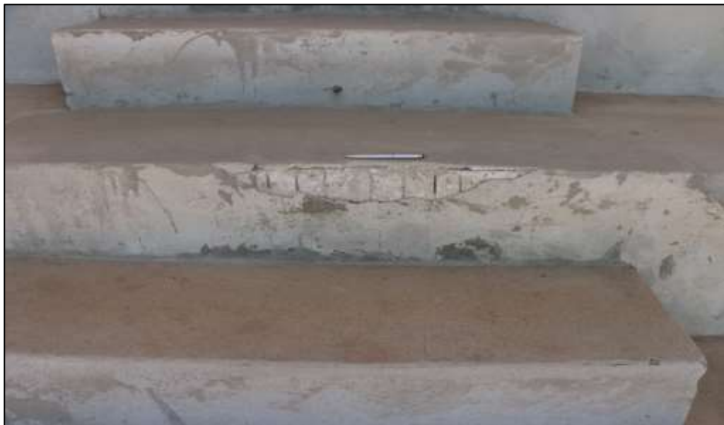
Fotografía 383 Detalle de una sección de concreto desprendida, en el borde de una de las gradas construidas. Según la escala utilizada (esfero de largo 13 cm), el desprendimiento presenta una longitud aproximada de 40 cm.
