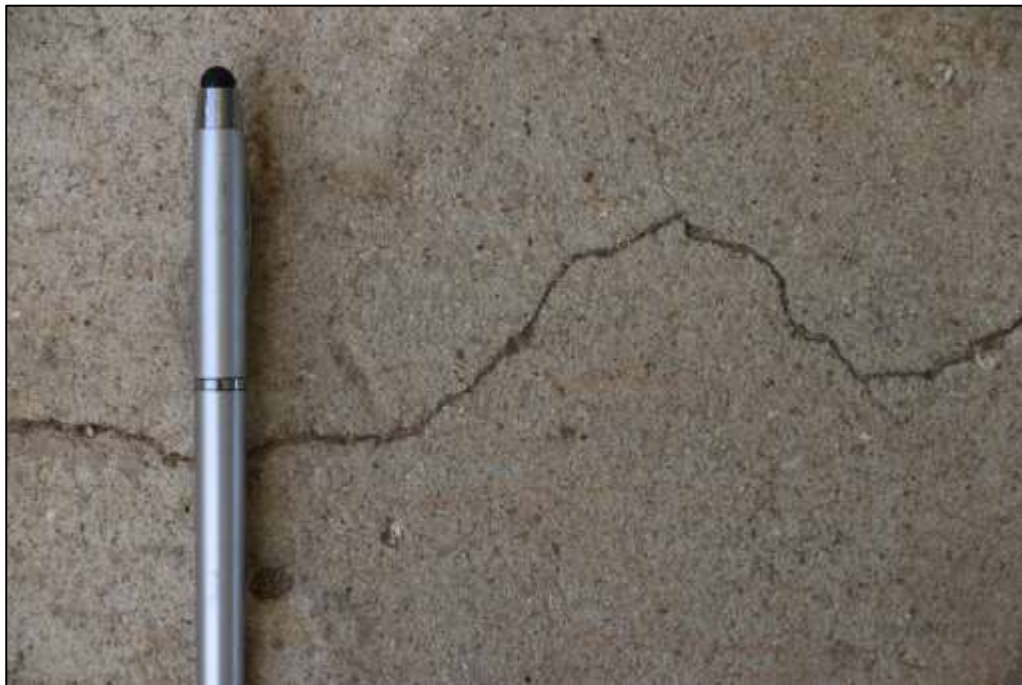
Fotografía 365 Detalle de una de las fisuras encontradas, en la zona descrita en la imagen anterior (vista en planta). Según la escala utilizada en la imagen (esfero de ancho 10 mm), las fisuras no superan el milímetro de abertura. En estas zonas, las fisuras en su mayoría se encontraron transversales al sentido de circulación, continuas y desconectadas.
