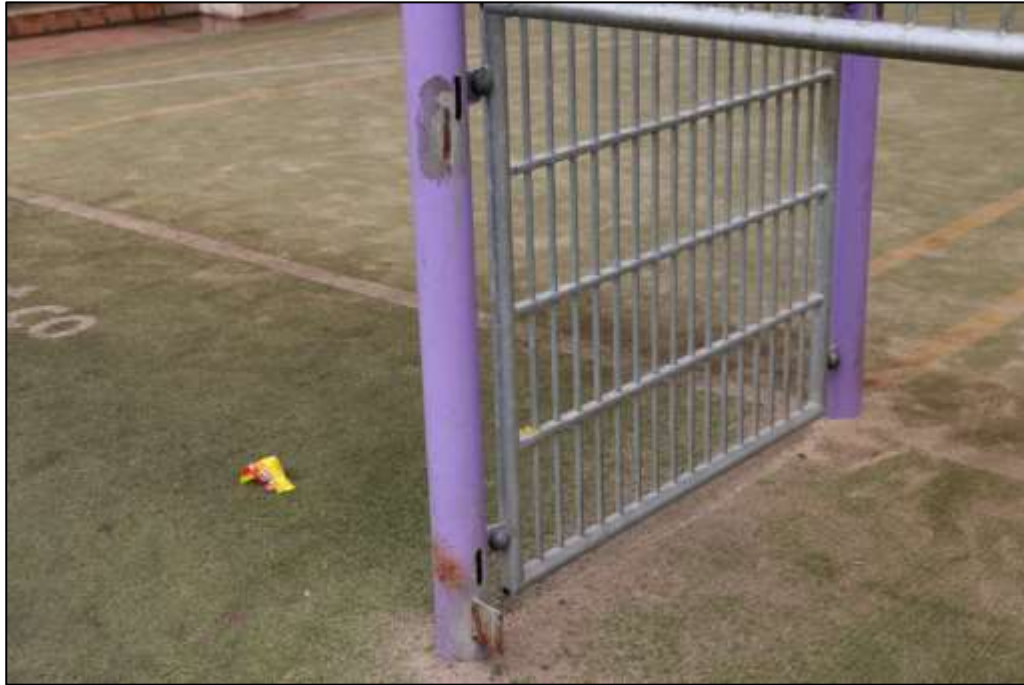
Fotografía 286. Detalle de una conexión interior entre elementos metálicos, en la estructura de uno de los arcos de fútbol. Se evidencia la misma lesión ya descrita en el polideportivo del barrio San Rafael.
