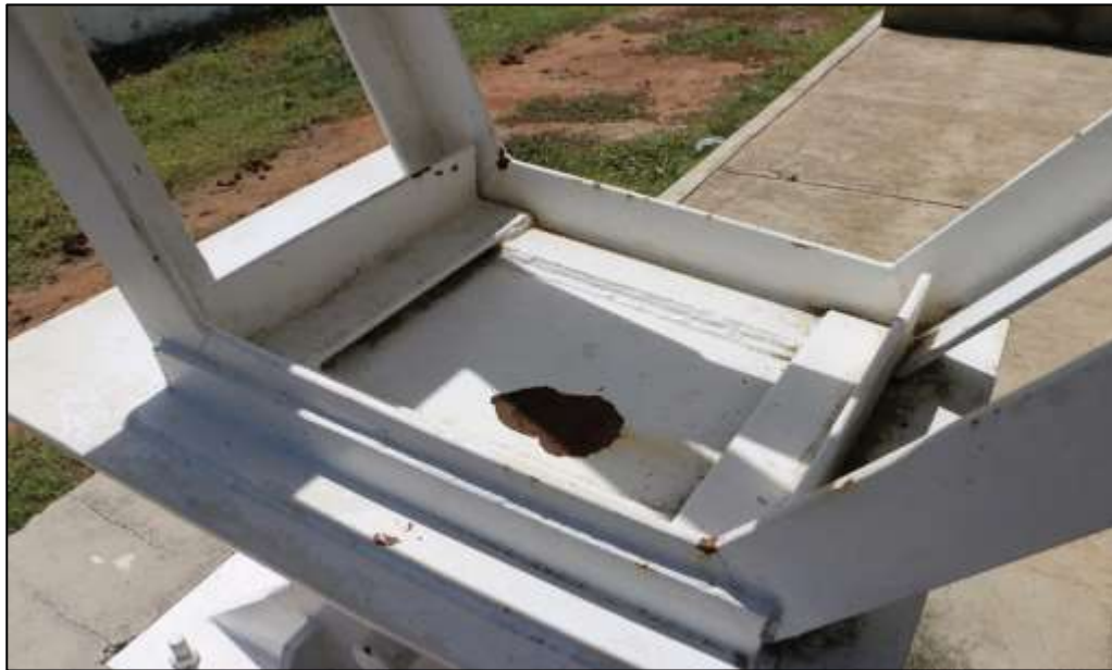
Fotografía 389 Detalle de la conexión placa base de una columna metálica, en la estructura de cubierta construida en el polideportivo. Los elementos metálicos de estas conexiones, se evidenciaron con oxidación y pérdida parcial de la pintura de recubrimiento.
