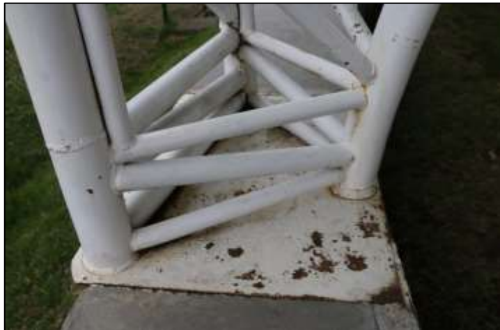
Fotografía 189. Detalle de la conexión de placa base, de una de las columnas metálicas de la estructura de cubierta. Los elementos metálicos de estas conexiones, evidencian pérdida parcial de la pintura de acabado y presencia de óxido disperso.
