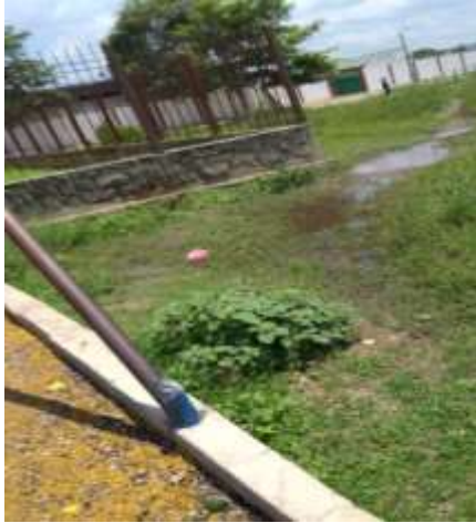
Fotografía 20 Ausencia de malla, lote contiguo anegadizo
