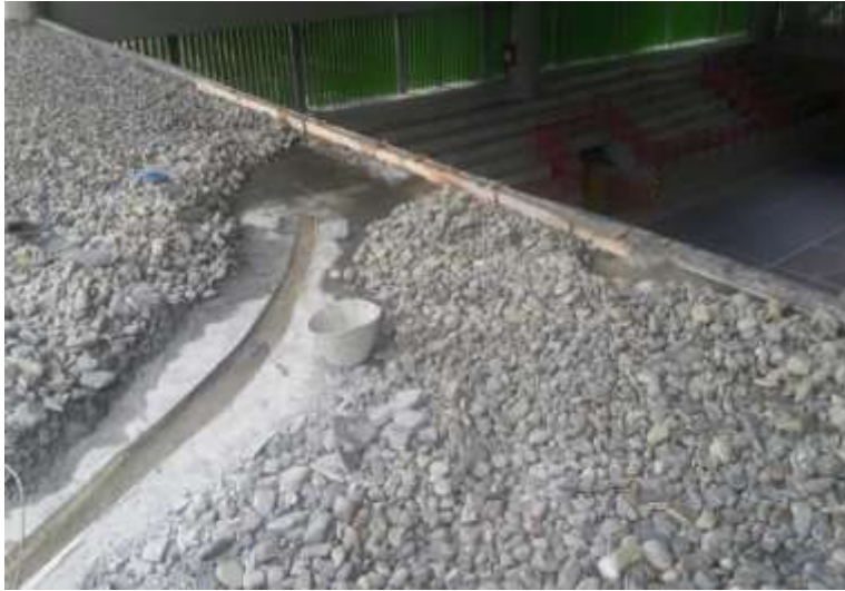
Fotografía N° 559. Reparación realizada por las personas de mantenimiento del Coliseo, esto ocasiona que se dañe la impermeabilización y se produzcan filtraciones al interior de la losa de concreto.
