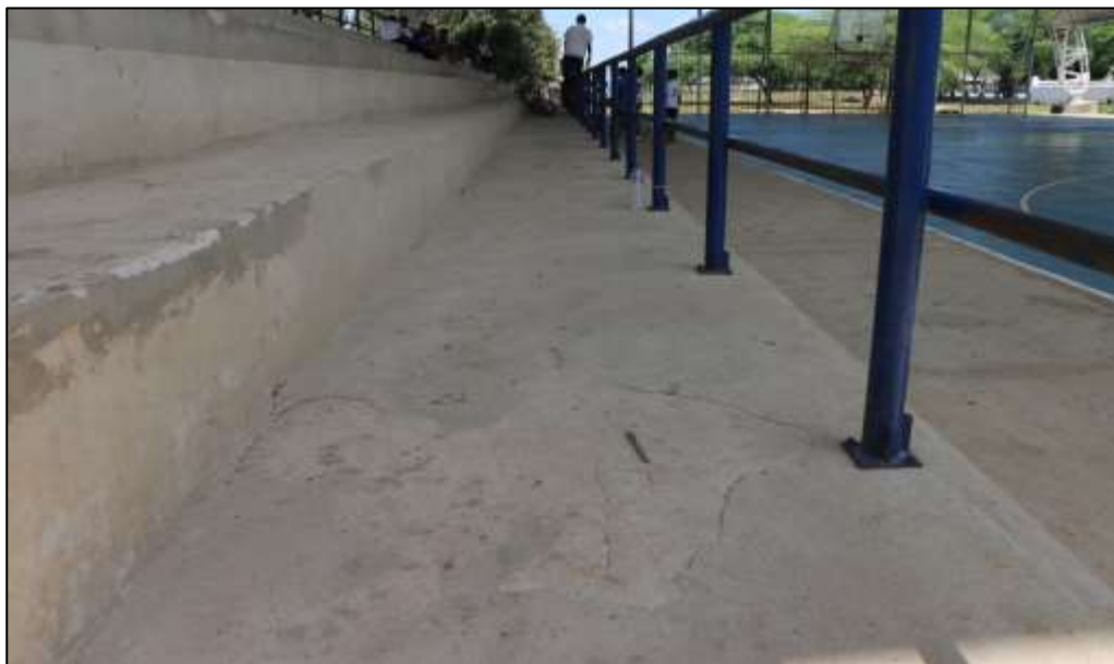
Fotografía 369 Vista general de la grada inferior, en las graderías construidas dentro de este polideportivo. En el concreto de esta obra, se evidenció desprendimiento parcial de material, fisuras transversales y el agregado a la vista.
