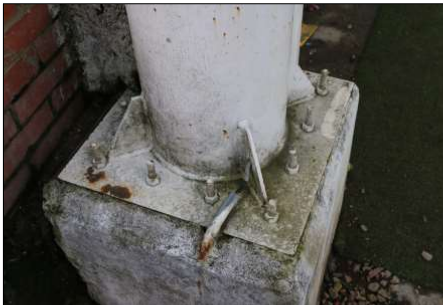
Fotografía 265. Detalle de la conexión metálica de una de las columnas de la estructura de cubierta en su pedestal de concreto. Los elementos metálicos evidencian oxidación y lavado diferencial. Así mismo, el concreto se encuentra desportillado.
