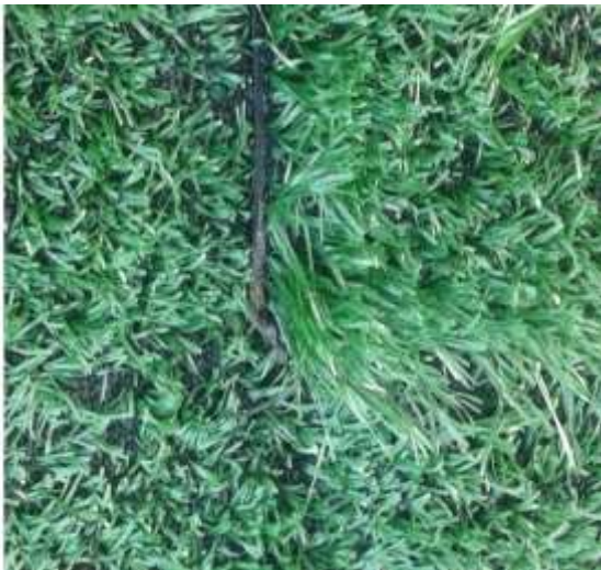
Fotografía N° 474. nstalación irregular Grama sintética
