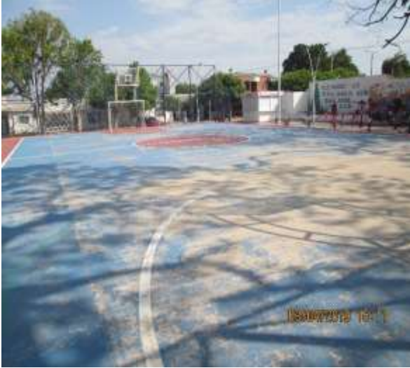
Fotografía 139. Muestra desprendimiento pintura de la cancha multifuncional
