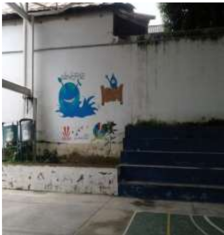
Fotografía N° 488. umedad y falta de pintura Polideportivo
