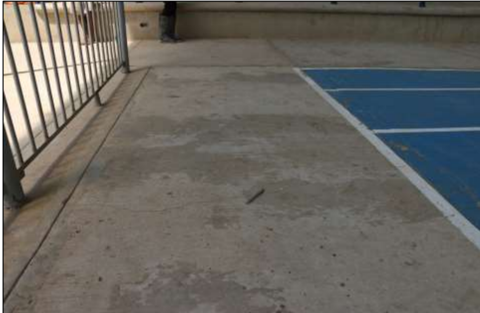
Fotografía 364 Vista general de una sección de concreto perimetral a la zona demarcada como cancha deportiva. Sobre esta zona se evidenciaron fisuras y hormigueo leve.
