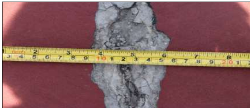
Fotografía 207. Detalle de la lesión identificada en la imagen anterior. La abertura de la grieta en algunos sitios es de 7 cm. En esta fotografía se evidencia que el concreto de la placa bajo el acabado superficial, también está afectado.
