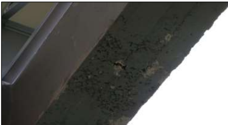
Fotografía 184. Detalle de la cara baja de una viga aérea de concreto. Al igual que en la imagen anterior, en esta fotografía se aprecia el hormigueo excesivo en una de las caras de esta viga de concreto, debido a debilidad en el proceso constructivo, específicamente en el vibrado y homogenización de la mezcla.
