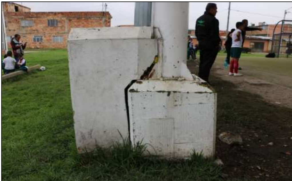
Fotografía 281. Detalle de una de las cajas de mampostería construidas para proteger a las bajantes en cercanía al nivel del terreno. Se evidenció grieta en algunos de estos muros.
