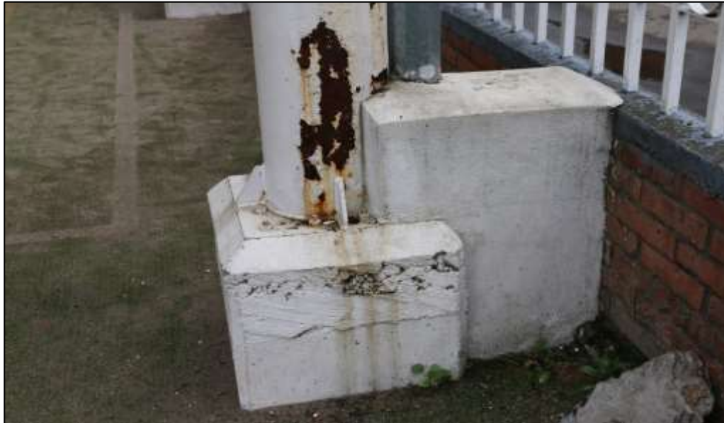
Fotografía 284. Detalle de una sección de una de las columnas metálicas, instaladas en este polideportivo. Se evidenció pérdida parcial y diferencial de pintura de acabado y oxidación de estos elementos.
