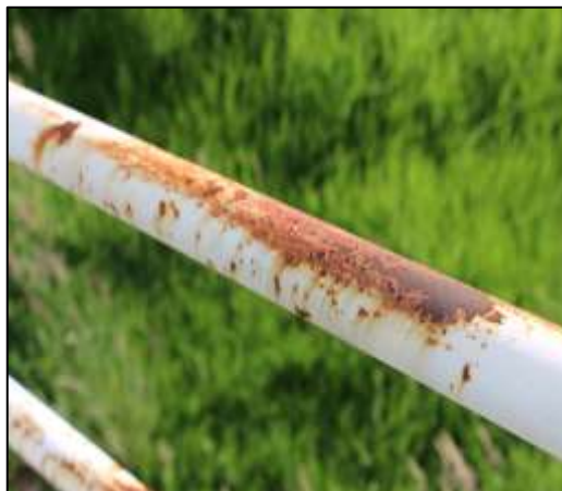
Fotografía 261. Detalle de una sección de baranda, de la escalera registrada en la imagen anterior. En la fotografía quedó registrado el nivel de oxidación de la baranda.
