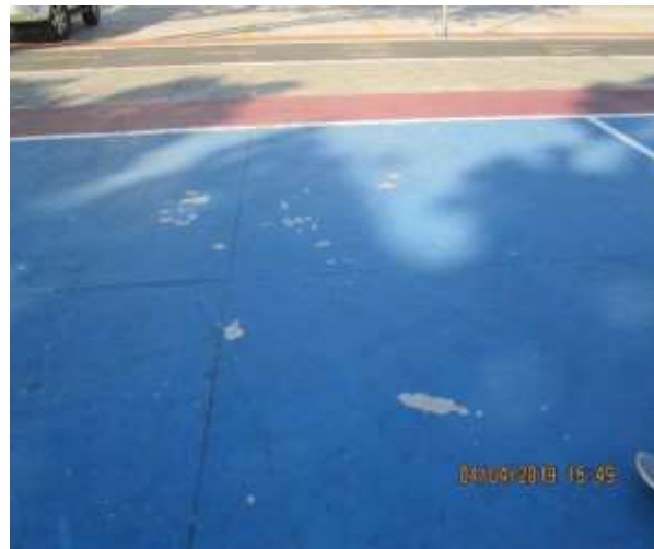
Fotografía 147. Muestra desprendimiento de la pintura en la cancha multifuncional.
