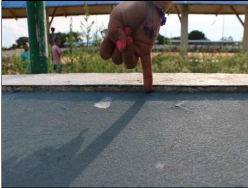
Fotografía 323 Detalle de una sección de la pista de patinaje (patinódromo). En la imagen se aprecia el asentamiento que ha sufrido el pavimento construido, con respecto al muro de contención, ubicado de manera posterior del sitio de la imagen. Según la escala utilizada, se evidencia un asentamiento aproximado de 15 mm.
