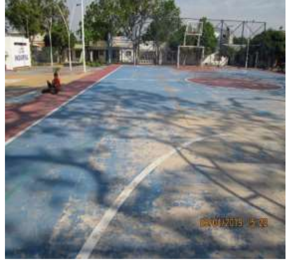
Fotografía 140. Muestra desprendimiento pintura de la cancha multifuncional.
