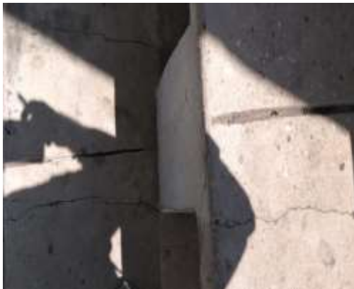
Fotografía 48 Gradas con fisuras en apoyos de ambos lados
