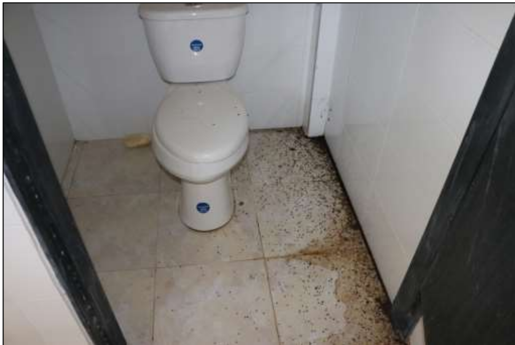
Fotografía 352 Detalle del cubículo para uno de los sanitarios instalados en el edificio administrativo. En varios de estos espacios, se evidenció manchado diferencial del enchape de piso y acumulación de materia orgánica (excremento de animales).
