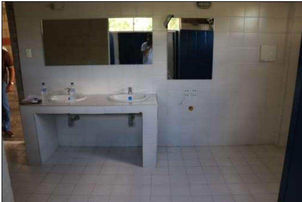
Fotografía 398 Vista general de una batería de lavamanos, en uno de los baños adecuados en el edificio administrativo del polideportivo. Durante el recorrido, se evidenció la ausencia de diferentes aparatos sanitarios, así como de grifería de otros.
