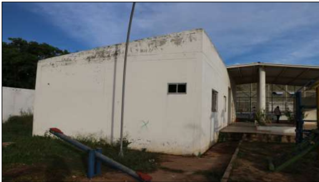
Fotografía 358 Vista general de una de las fachadas laterales, del edificio administrativo. Sobre la superficie de estos muros, al igual que en los bordes de la placa de contra piso externa y los muros de las materas, se evidenció lavado diferencial por escurrimiento de agua lluvia y pérdida parcial de la pintura de acabado.
