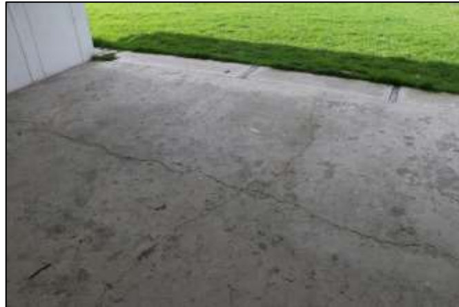
Fotografía 250. Vista general de la placa de contra piso, a lo largo del pasillo principal de este escenario deportivo. Las fisuras se evidenciaron interconectadas.
