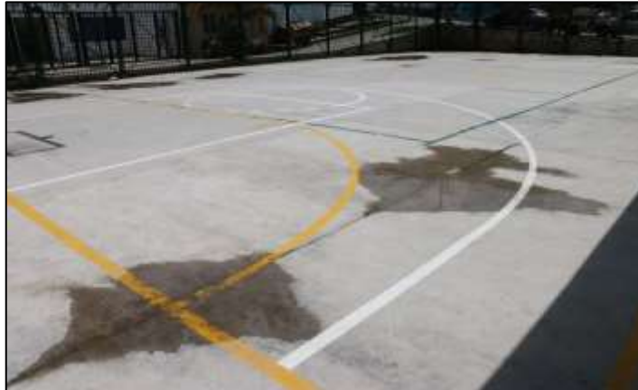
Fotografía 215. Vista general de las placas de concreto construidas en el área de la cancha multideportiva, de este escenario deportivo. Como quedó registrado en la imagen capturada por la CGR durante el recorrido, se evidenció agua encharcada y estancada, sin posibilidad de evacuación. Esta situación vulnera la calidad de la obra entregada.
