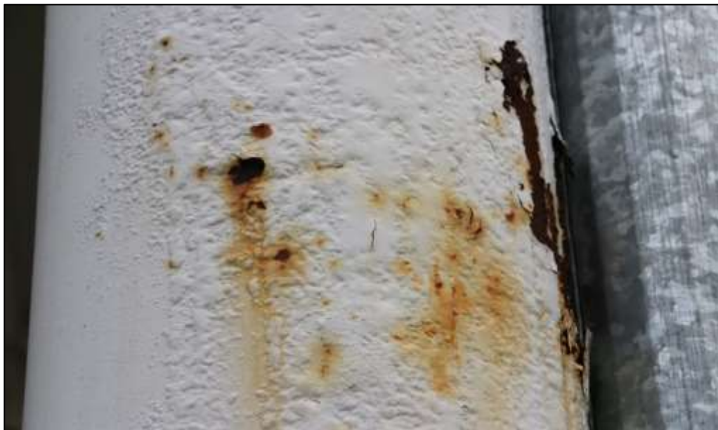
Fotografía 285. Detalle de otra sección de una de las columnas metálicas, instaladas en este polideportivo. Se evidenció pérdida parcial y diferencial de pintura de acabado y oxidación de estos elementos. Así mismo, la pintura de acabado evidencia ampollas e hinchamiento.
