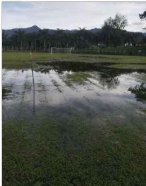
Fotografía 231. Vista general de otra sección de la zona central de la cancha de fútbol (imagen rotada 90° hacia la izquierda). Se evidenció la misma lesión ya descrita, en la obra construida. (Fotografía tomada por funcionario del IMDER del municipio).
