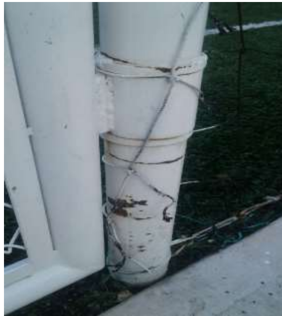
Fotografía N° 477. Pintura en mal estado puerta de entrada
