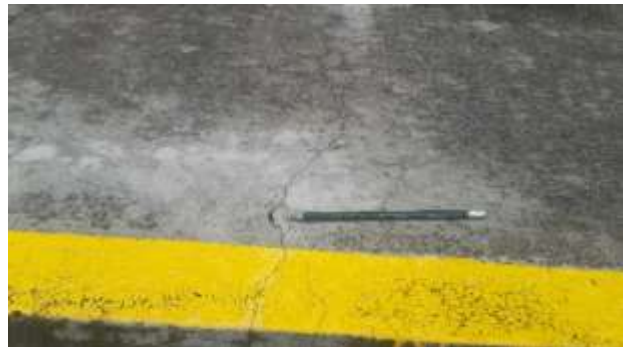
Fotografía N° 567. Fisuras presentadas en las huellas
