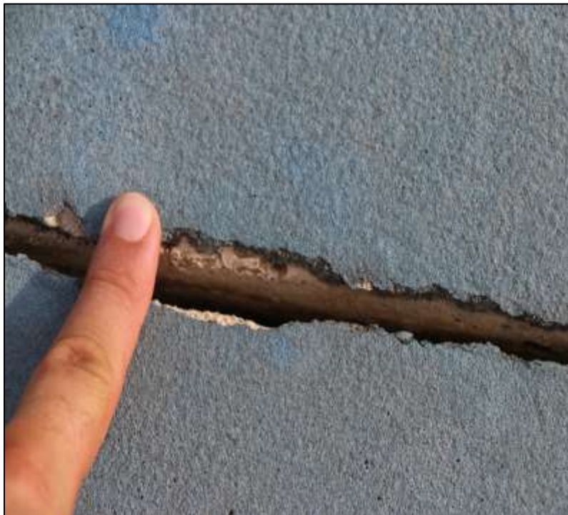
Fotografía 322 Detalle de una sección de la pista de patinaje (patinódromo). Comparación de una grieta con un objeto de dimensión conocida (dedo de ancho 15 mm).
