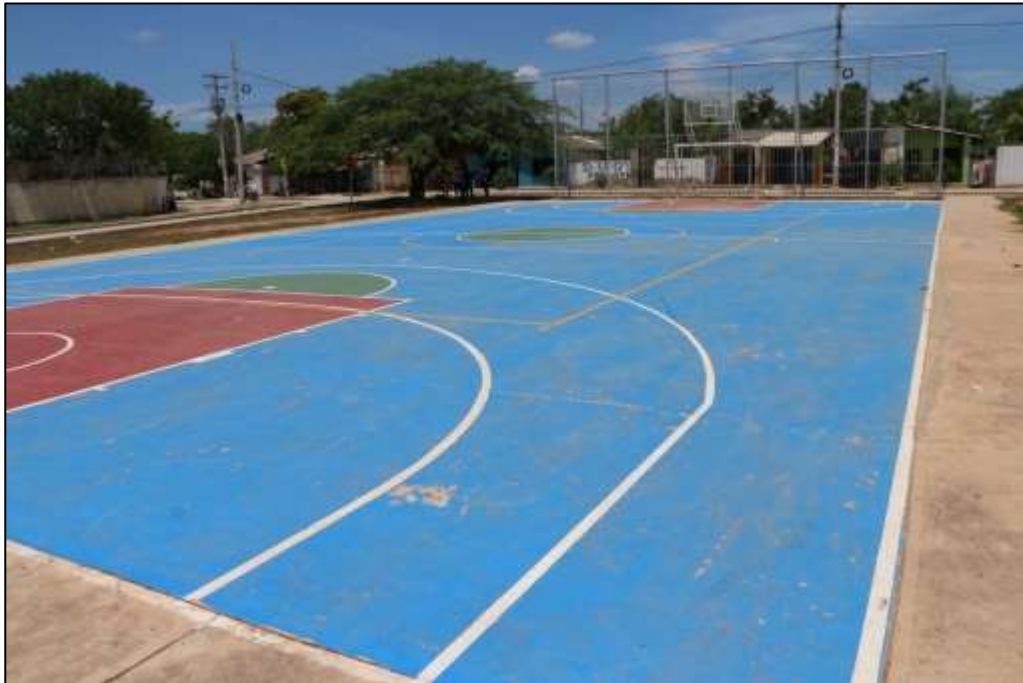
Fotografía 415 Vista general de la cancha construida, en área vecina de la cancha de fútbol. Se evidenció pérdida parcial de la pintura de acabado, de la superficie del pavimento de este escenario deportivo.
