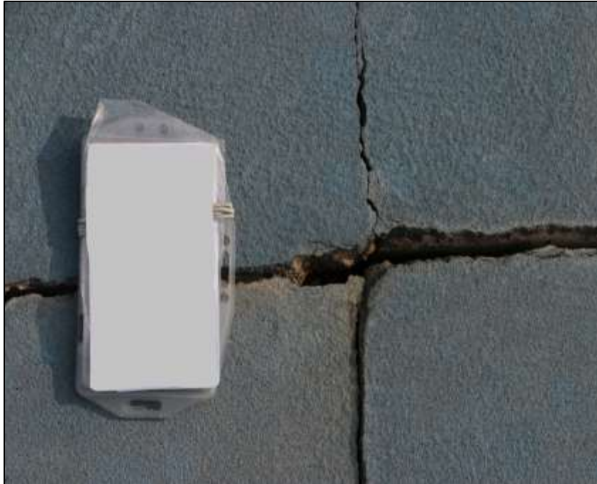
Fotografía 321 Detalle de una sección de la pista de patinaje (patinódromo). Comparación de una grieta con un objeto de dimensión conocida (carné de ancho 58 mm).
