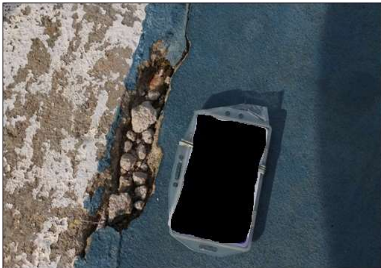
Fotografía 314 Detalle de una sección de la pista de patinaje (patinódromo). En varias secciones se evidenció agrietamiento del concreto, desportillamiento de los bordes y pérdida parcial de sección.
