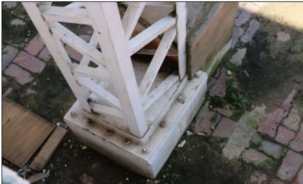
Fotografía 271. Detalle de la conexión metálica de una de las columnas de la estructura de cubierta en su pedestal de concreto. Los elementos metálicos evidencian oxidación y lavado diferencial.
