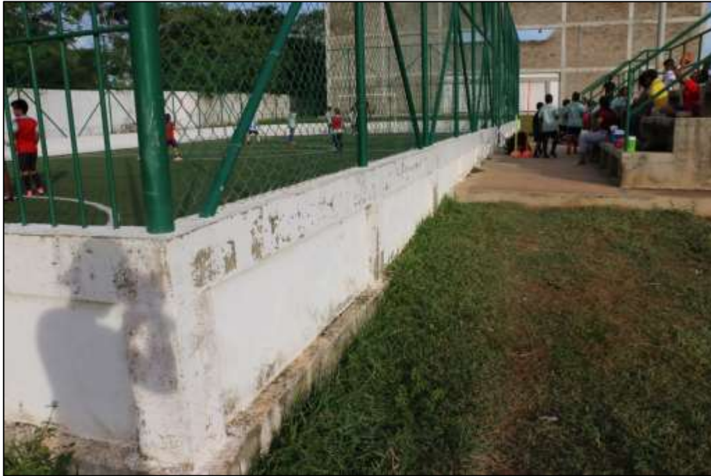
Fotografía 347 Vista general de uno de los antepechos perimetrales longitudinales, en la cancha de fútbol sintético. En estos elementos, se evidenció pérdida parcial de la pintura de acabado.
