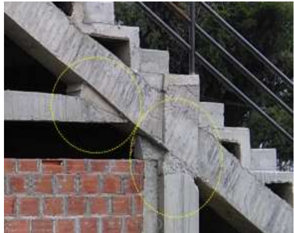
Fotografía 436 Incorrecta conformación del confinamiento en conexiones
