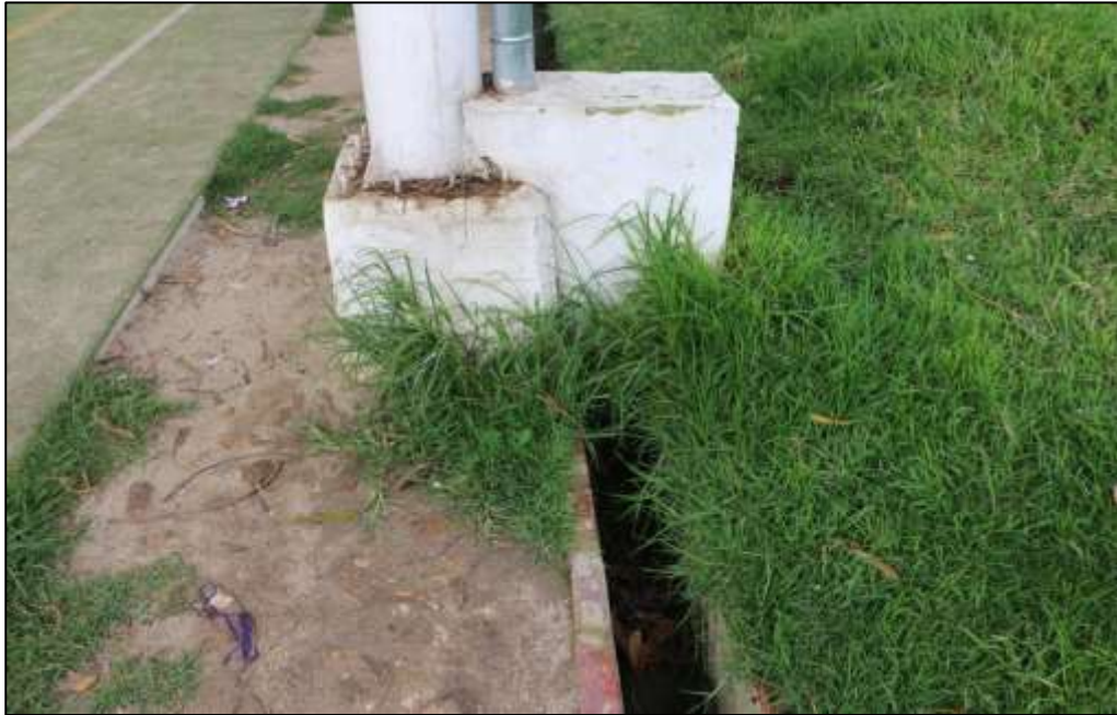
Fotografía 280. Vista general de una sección del cárcamo perimetral. Se evidenció en distintas zonas, como la registrada en la imagen, la ausencia de la rejilla metálica instalada en esta obra. Así mismo, presencia de material de arrastre dentro del cárcamo.
