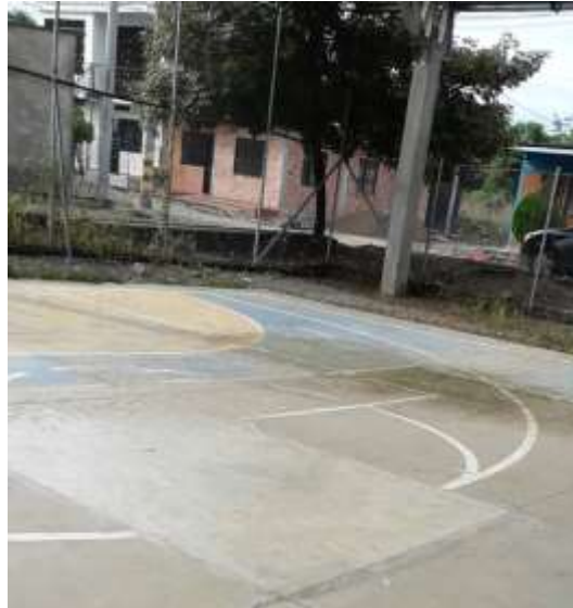
Fotografía N° 525. Huellas del empozamiento de agua
