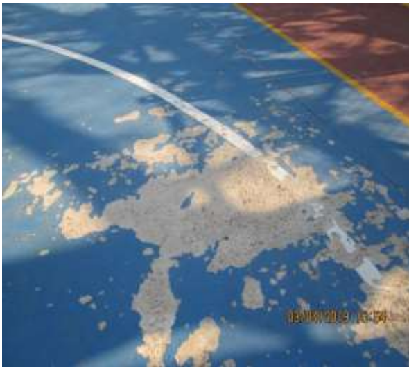
Fotografía 134. Muestra desprendimiento de pintura de la cancha multifuncional.
