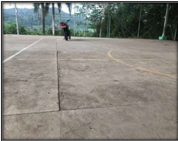
Fotografía N° 536. Evidencia severo aumento tamaño dilataciones
