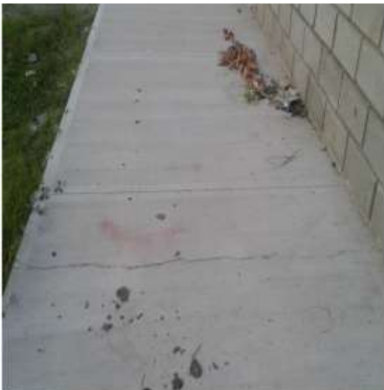
Fotografía N° 480. Agrietamiento anden perimetral
