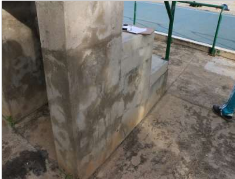
Fotografía 334 Vista general lateral de uno de los muros de soporte, de una de las graderías construidas en este escenario deportivo. El pañete de estos muros, evidencia humedad acumulada y huella de reparaciones antiguas.
