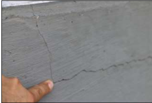
Fotografía 221. Detalle de otra sección de contrahuella en una de las graderías construidas. En la imagen se evidencian fisuras presentes en la obra construida.
