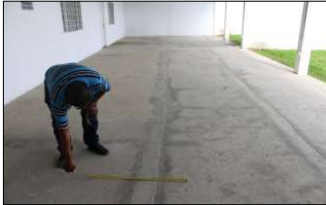
Fotografía 246. Vista general de la placa de contra piso, a lo largo del pasillo principal de este escenario deportivo. Sobre este elemento, se evidenciaron gran cantidad de fisuras y grietas, orientadas de manera longitudinal y transversal. Así mismo, se evidenciaron las huellas de algunas reparaciones realizadas en esta obra. En la imagen se registró la medición de una de las fisuras encontradas durante la visita.
