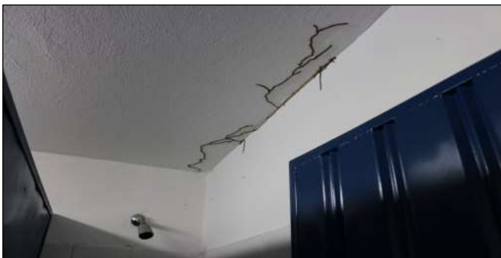
Fotografía 161. Detalle de la cara inferior de la placa de concreto, en la zona de los baños localizados bajo la tarima al aire libre. En este espacio se evidenció presencia de materia orgánica y de animales.
