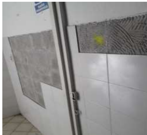
Fotografía N° 489. Desprendimiento de baldosas pared sector baños Polideportivo
