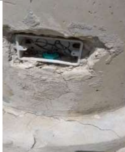
Fotografía 49 Caja de registro eléctrico de 2X4 sin tapa ciega
