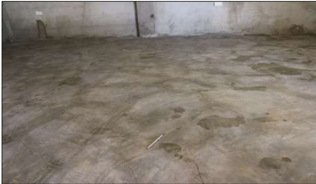
Fotografía 377 Vista general de la placa de contra piso, de uno de los espacios adecuados en este edificio. En esta zona se evidenció gran cantidad de fisuras interconectadas, dispuestas de manera aleatoria, primordialmente en diagonal a los lados perimetrales de la placa.
