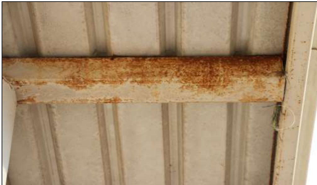
Fotografía 362 Detalle de una sección de correa, a nivel de la cubierta construida, sobre el área libre frente al edificio administrativo. En esta imagen se evidencia el estado del elemento metálico, el cual presenta oxidación diferencial.
