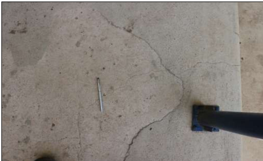
Fotografía 371 Detalle de una sección con fisuras y desprendimiento, en el concreto de las graderías (vista en planta). El desprendimiento evidenciado, responde a desconchamiento, generado seguramente por falta de adherencia de capas de concreto de distintas edades.
