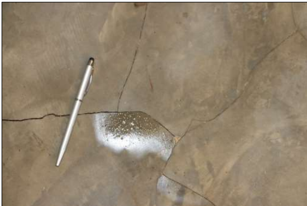
Fotografía 378 Detalle de una sección de la placa de contra piso, del espacio registrado en la imagen anterior. Se evidenció que el concreto presenta varias capas, con problemas de adherencia entre concretos de distintas edades.
