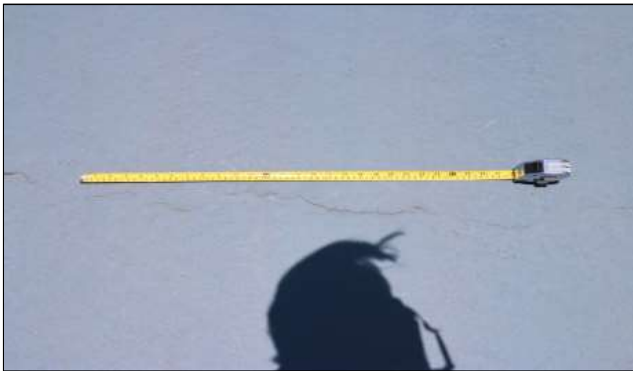
Fotografía 194. Detalle de una sección de la pista de patinaje (patinódromo). En la superficie de la capa de rodadura de esta estructura y en diferentes secciones, se evidenciaron fisuras longitudinales, como la registrada en la imagen.
