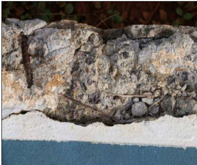
Fotografía 328 Detalle de una sección del bordillo perimetral externo, de la pista de patinaje (patinódromo). En la imagen, se evidencia la lesión ya descrita. En esta zona, a parte del agregado, el acero de refuerzo transversal (estribos), se encuentra a la vista. Así mismo, se evidencia que el acero no fue instalado de manera completa, dado que únicamente se aprecia un estribo en una sección capturada de aproximadamente 20 cm.
