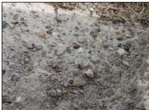
Fotografía 254. Detalle de la sección de concreto registrada en la imagen anterior. En esta zona, el deterioro es mayor en relación a la lesión identificada en imágenes anteriores. Se evidenció pérdida parcial de sección y del agregado de la mezcla, tanto fino como grueso.
