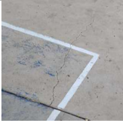
Fotografía 46 Fisura en piso y ausencia de pintura epóxica en cancha múltile
