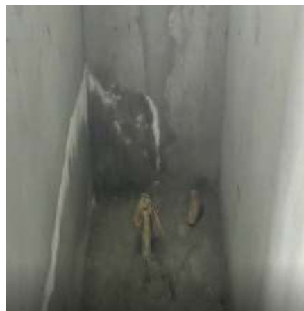
Fotografía N° 533. Humedades paredes baños
