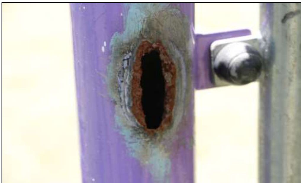
Fotografía 275. Detalle de una conexión interior entre elementos metálicos, en la estructura de uno de los arcos de fútbol. Se evidencia la misma lesión ya descrita en el polideportivo del barrio San Rafael.
