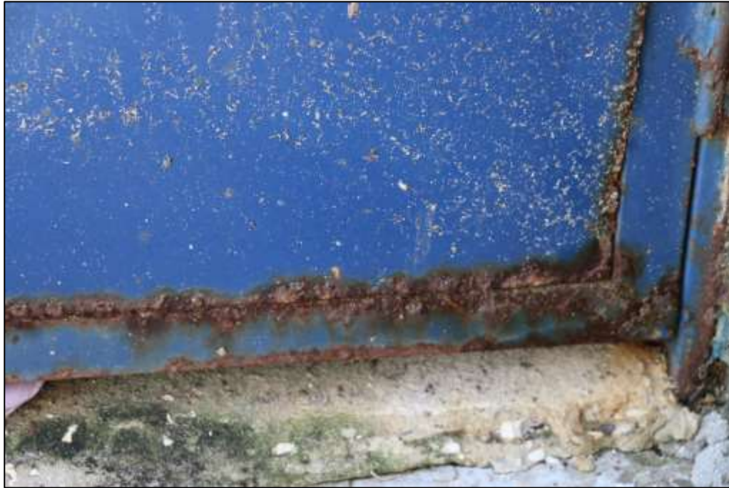
Fotografía 411 Detalle de la sección inferior (esquina) de una de las puertas, localizada sobre la zona posterior de las graderías construidas. En algunas secciones de la carpintería metálica (puertas, ventanas y barandas), se evidenció oxidación, ampolla en la pintura de acabado y pérdida parcial de la misma.
