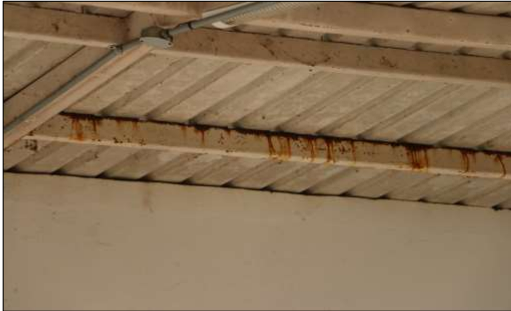
Fotografía 361 Detalle de una sección de la cubierta construida, sobre el área libre frente al edificio administrativo. En esta zona, se evidenció lavado diferencial por flujo de agua con óxido, sobre la superficie de los elementos metálicos de la estructura de cubierta. La cantidad de óxido presente permite concluir que la lesión es antigua.
