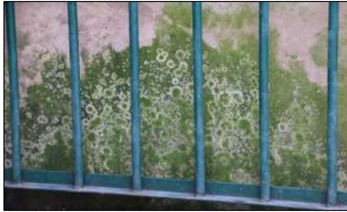
Fotografía 218. Detalle de una sección del muro de contención construido en dos de los costados externos de este polideportivo. En la imagen se aprecia la afectación ya descrita.
