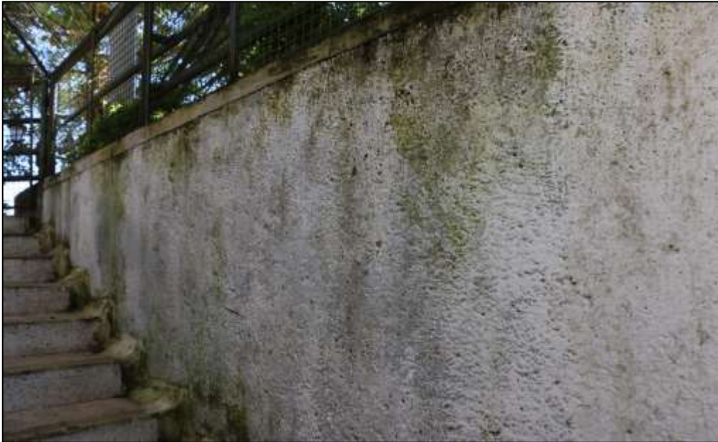
Fotografía 167. Detalle de uno de los muros perimetrales, en el pasillo que conduce al espacio adecuado bajo la tarima al aire libre (junto a la escalera). Sobre este muro se evidenció la misma lesión descrita en la imagen anterior.
