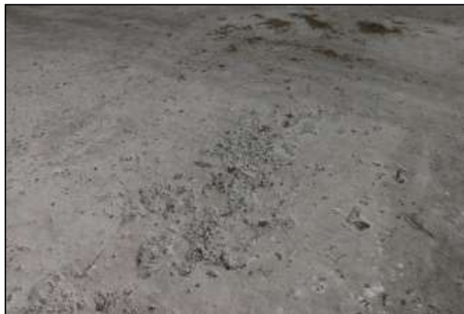
Fotografía 251. Vista general de una sección de la placa de contra piso. Otra de las lesiones evidenciadas en el concreto es la pérdida de la capa de concreto de recubrimiento, dejando el agregado de la mezcla a la vista.
