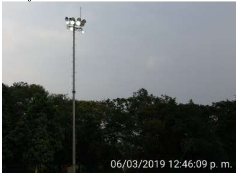
Fotografía 119 Luminarias sin servicio en el mástil # 2 – Son 5
