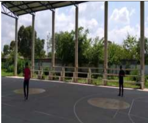
Fotografía 50 Ausencia de pintura epóxica en superficie de piso de cancha múltiple
