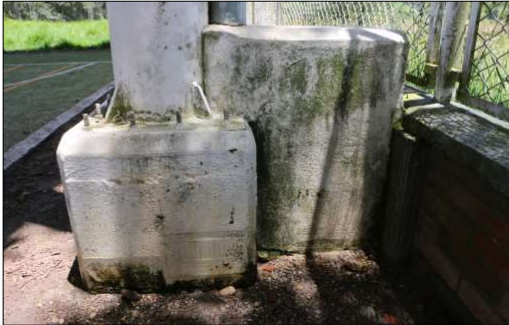
Fotografía 270. Detalle de otro pedestal construido. La superficie de los concretos evidencia lavado diferencial y manchado por acumulación de humedad.
