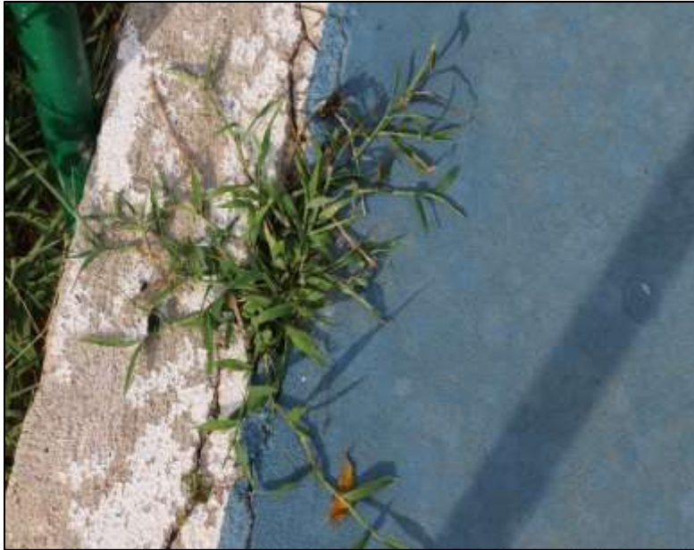
Fotografía 315 Detalle de una sección de la pista de patinaje (patinódromo). En la imagen quedó registrada la presencia de materia vegetal, que ha crecido dentro de una de las grietas del pavimento de concreto.
