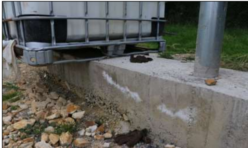
Fotografía 178. Detalle de la cimentación de una de las mallas de contención de balones. El manchado blanco sobre la superficie del concreto de esta obra, evidencia presencia de humedad interna y eflorescencia de sal. Lo anterior, se evidenció en diferentes zonas de este concreto.
