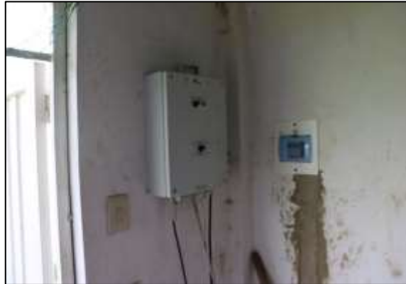
Fotografía 259. Detalle del tablero eléctrico para el control de los equipos para la práctica de polígono. Se evidenció la débil ejecución física en esta zona, específicamente lo relacionado con las regatas realizadas en el muro, para la instalación del cableado.
