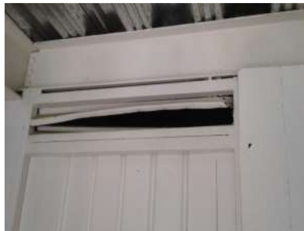
Fotografía N° 493. Daño en puerta baños
