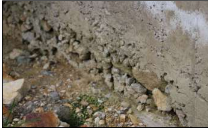
Fotografía 179. Detalle de la cimentación de una de las mallas de contención de balones (parte baja). En la imagen se aprecia el agregado a la vista, segregación de la mezcla y hormigqueo excesivo. Lo anterior, es producto de mala calidad de obra. Este proceso patológico se evidenció en distintas secciones de estos concretos.
