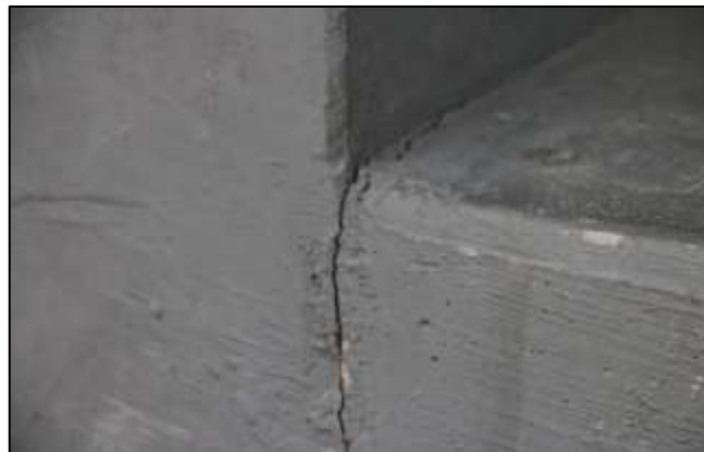
Fotografía 222. Detalle del encuentro entre un dado de concreto de soporte de una de las columnas metálicas de la cubierta y la gradería construida. La imagen registró una dilatación abierta, producto de debilidad constructiva en este tipo de detalles en obra.
