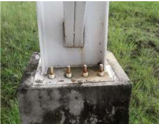
Fotografía N° 502. Columna estructura Polideportivo en estado de oxidación
