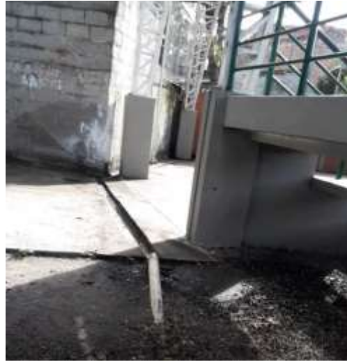
Fotografía N° 547. ubería aguas lluvias expuesta y averiada
