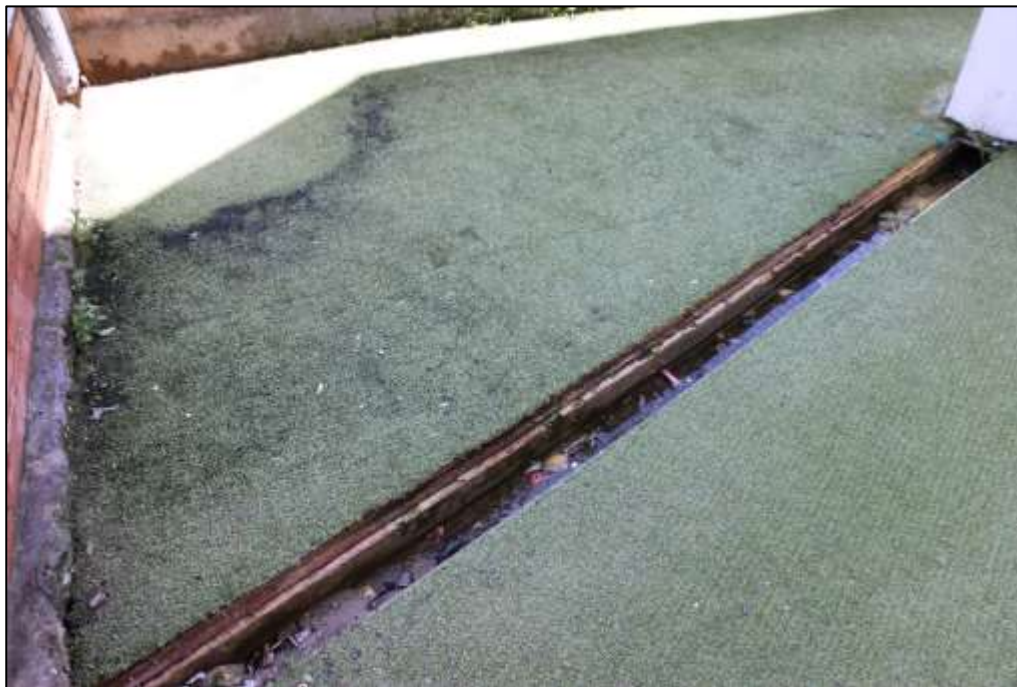
Fotografía 272. Vista general de una sección del cárcamo perimetral. Se evidenció en distintas zonas, como la registrada en la imagen, la ausencia de la rejilla metálica instalada en esta obra. Así mismo, presencia de material de arrastre dentro del cárcamo.
