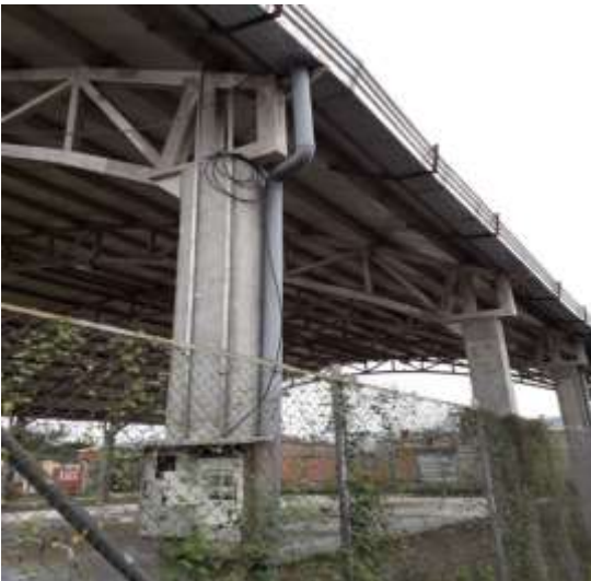
Fotografía N° 518. Maleza en el área perimetral
