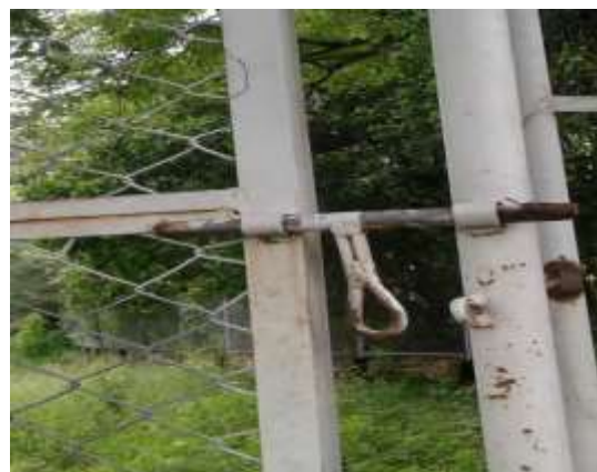
Fotografía N° 503. Portón en estado de oxidación
