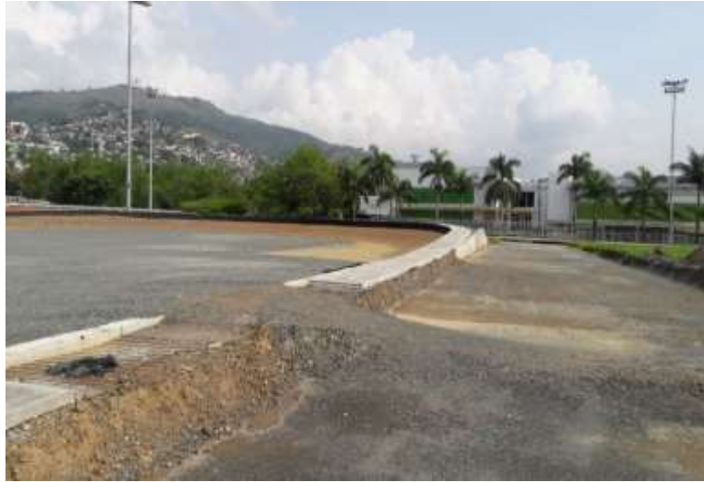
Fotografía N° 553. Patinódromo Mundialista Municipio de Cali, Suspendido desde diciembre por falta de interventoría. Foto tomada por el Auditor. Abril de 2019.
