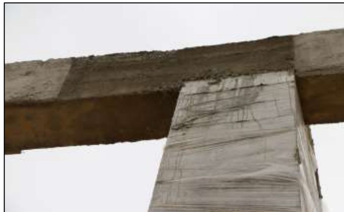
Fotografía 181. Detalle del nudo superior en otro de los pórticos de concreto construidos. En otras secciones se evidenciaron reparaciones realizadas sobre los concretos construidos. Lo anterior, valida la conclusión de la baja calidad de obra desarrollada por el contratista.
