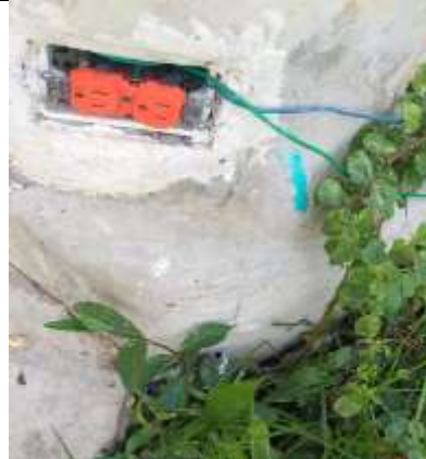
Fotografía 47 Tomacorriente eléctrico sin tapa y cables expuestos
