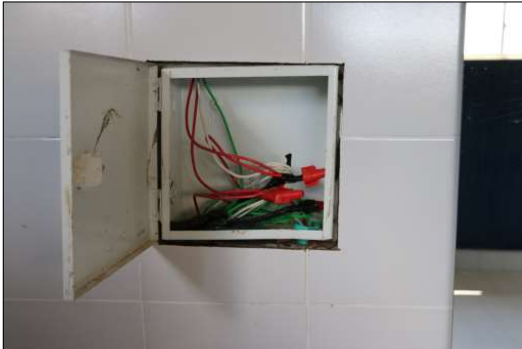
Fotografía 376 Detalle de una caja eléctrica, ubicada en el interior de uno de los baños (edificio administrativo del polideportivo). Se evidenció falta de rigor técnico en la instalación de los cables eléctricos en este sitio, así como de la caja dentro del muro.
