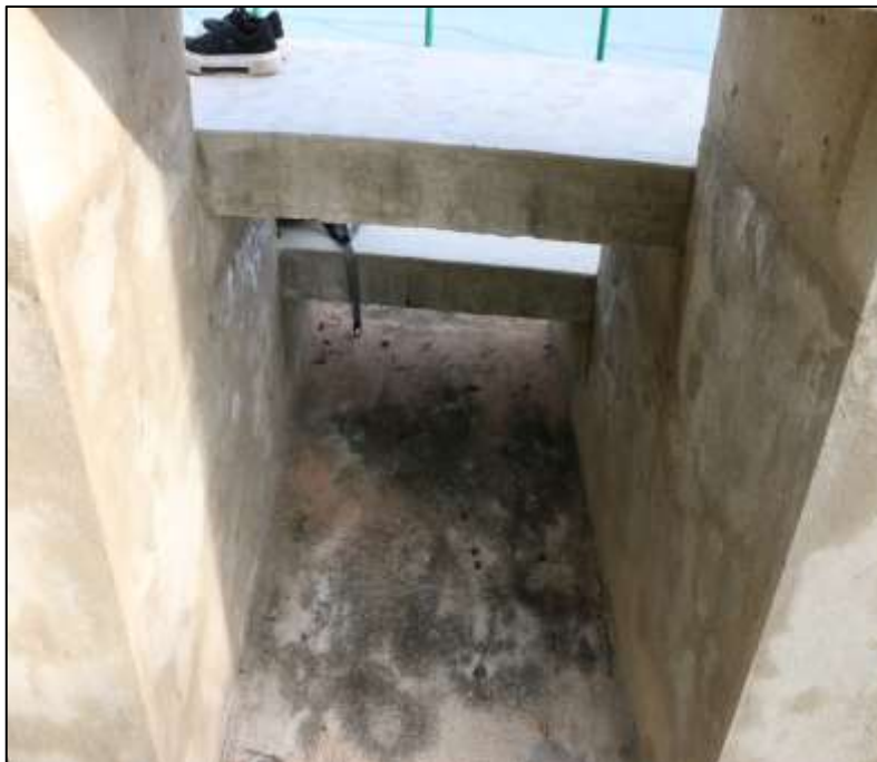
Fotografía 335 Detalle de una sección interna de una de las graderías construidas en este escenario deportivo. En los muros se evidencia eflorescencia de sal y acumulación de humedad en los pañetes, en la cara superior de la placa de contra piso, manchado diferencial por acumulación de humedad. Lo anterior, por baja calidad de los materiales utilizados.
