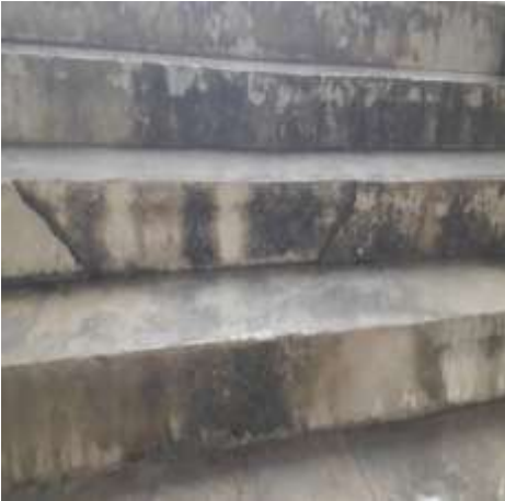
Fotografía N° 494. Grietas graderías polideportivo
