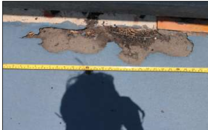
Fotografía 199. Detalle de otra sección de la pista de patinaje (patinódromo). Evidencia de desprendimiento de una sección del recubrimiento sintético, en una longitud aproximada de 55 cm.
