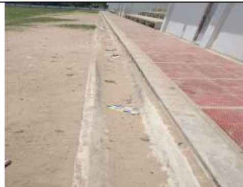
Fotografía 35 Canales de desagües con arena
