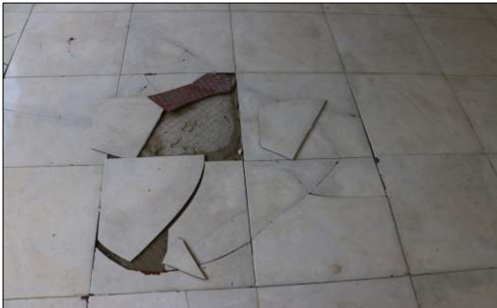
Fotografía 405 Detalle de una sección de enchape de piso, en uno de los espacios adecuados en el edificio administrativo del polideportivo. En algunas zonas internas de esta edificación, se evidenció fractura del enchape de piso, como en la zona registrada en la imagen. El mal uso por parte de la comunidad y administradores del edificio, así como el abandono por parte de la Alcaldía, son la causa.
