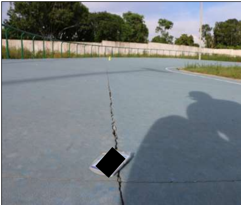
Fotografía 316 Vista general de una sección de la pista de patinaje (patinódromo). Se evidenciaron grietas paralelas al sentido de circulación del pavimento, ubicadas en la zona central del mismo. De esta manera, se denota la abertura de juntas constructivas, por deficiencia constructiva de la misma.
