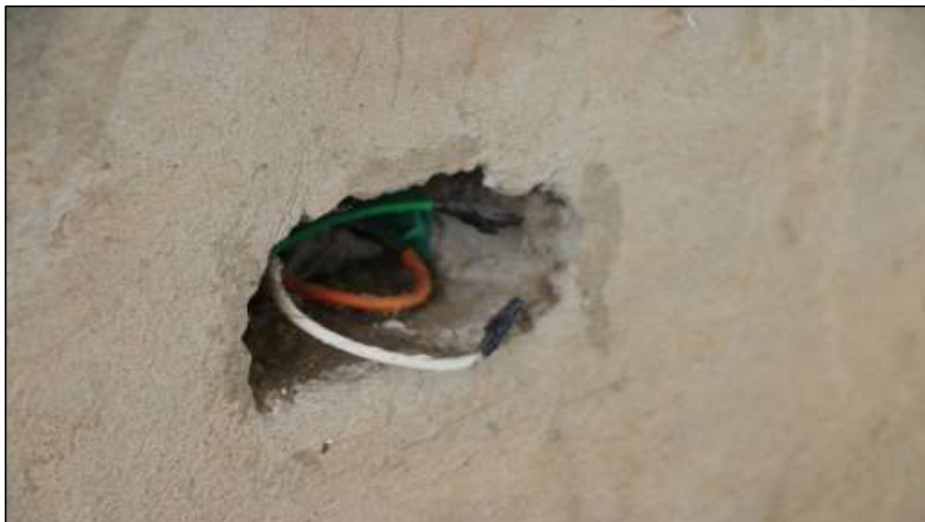
Fotografía 396 Detalle de una salida eléctrica, adecuada sobre el antepecho, ubicado en frente de las graderías construidas (polideportivo). Se evidenció la ausencia del aplique eléctrico de esta salida eléctrica.
