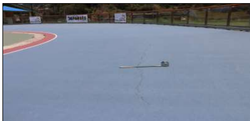
Fotografía 201. Detalle de otra sección de la pista de patinaje (patinódromo). Evidencia de fisura longitudinal, sobre una de las curvas de este escenario deportivo. Esta fisura tiene una longitud que supera los 2 m.
