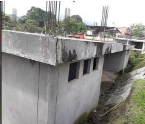
Fotografía N° 531. Obras suspendidas y abandonadas
