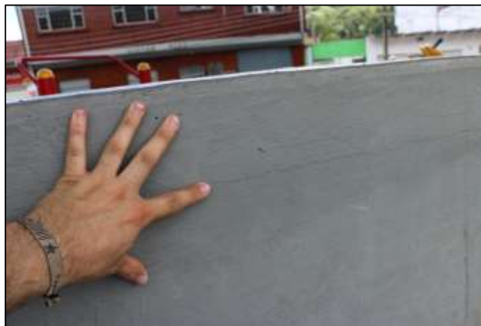
Fotografía 220. Detalle de una sección de contrahuella en una de las graderías construidas. En la imagen se evidencia la fisura longitudinal generada en la junta entre la placa de concreto y el muro de mampostería. La ausencia de una junta constructiva adecuada genera este tipo de fisuras (debilidad constructiva).
