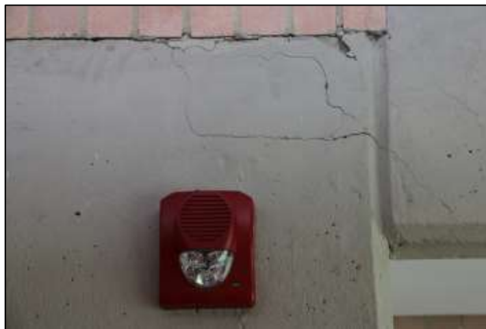
Fotografía 154. Detalle de otro de los dinteles, con evidencia de fisuras y desportillamiento.
