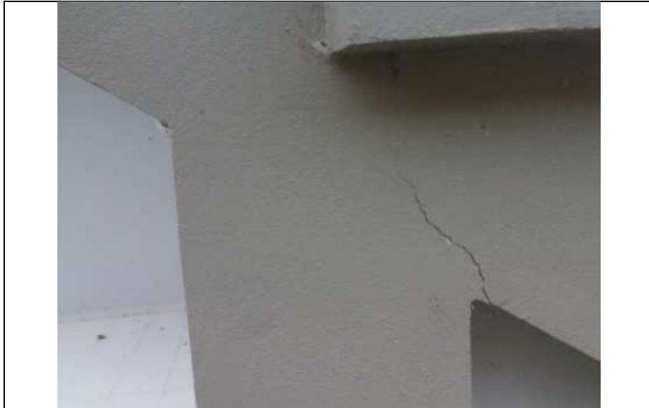
Fotografía 427 Fractura en el nudo entre columna y viga determina un comportamiento anormal de la estructura.
