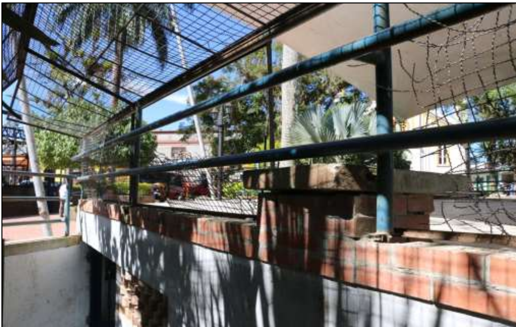
Fotografía 168. Vista general de una sección de la baranda instalada al nivel de la tarima al aire libre, protegiendo del vacío de la escalera a desnivel. En este sitio se evidenció la ausencia de una sección de la malla eslabonada, instalada entre las tuberías horizontales.
