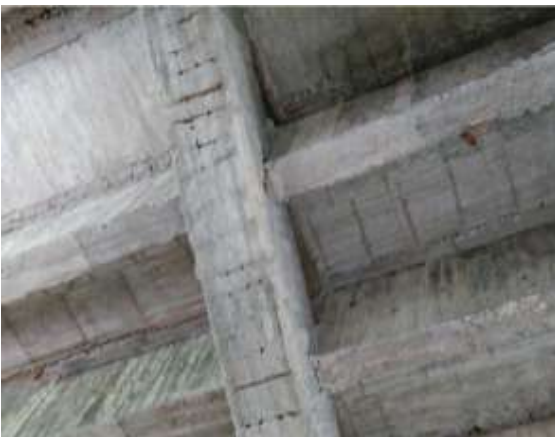
Fotografía 429 Incumplimiento en el Recubrimiento del Acero de Refuerzo
