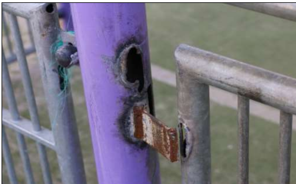
Fotografía 273. Detalle de una conexión interior entre elementos metálicos, en la estructura de uno de los arcos de fútbol. En la imagen quedó registrado el estado en el cual se encontró esta obra, en el sentido de fractura de algunas conexiones y pérdida de secciones metálicas.
