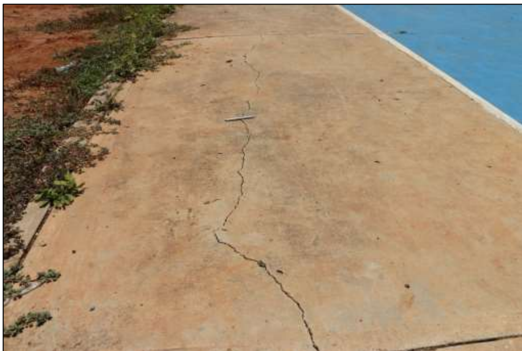
Fotografía 387 Vista general de otra sección del andén perimetral, construido en zonas aledañas a este escenario deportivo. En otras zonas de esta obra, se evidenciaron fisuras longitudinales, paralelas a la dimensión mayor de este pavimento.
