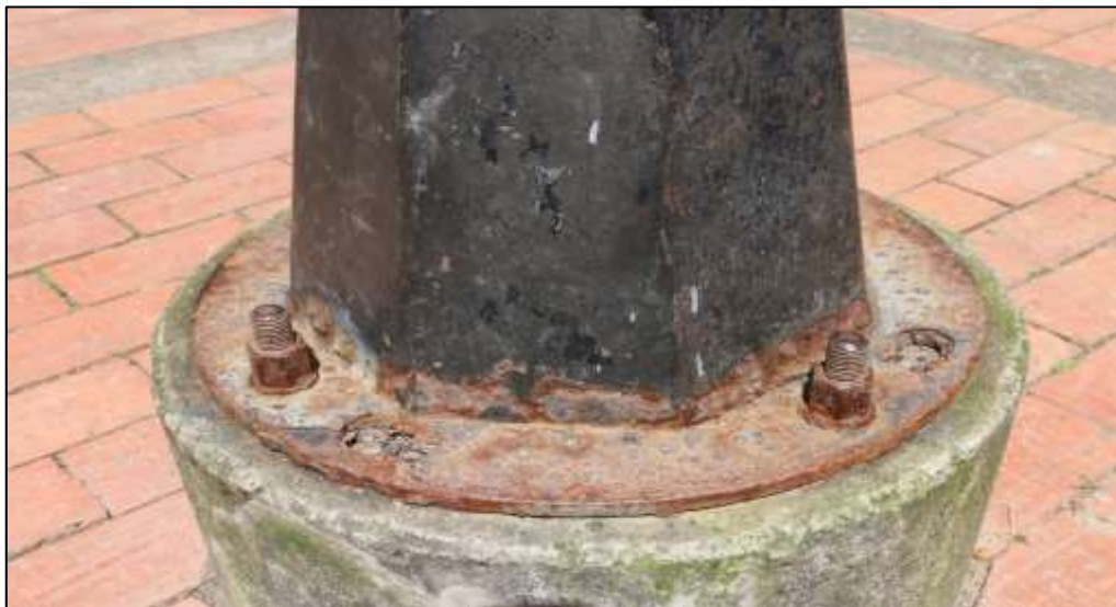
Fotografía 175. Detalle de la base de una de las luminarias instaladas en las zonas abiertas del parque intervenido. Los elementos metálicos de esta conexión, evidencian oxidación profunda, ondulaciones y distorsiones de la platina, así como aberturas en la platina sin ningún uso. Estas situaciones se evidenciaron en la mayoría de las luminarias.
