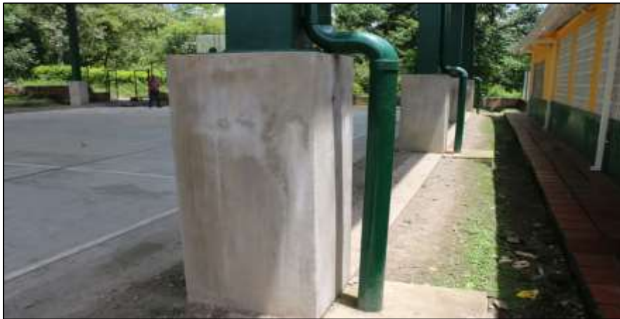
Fotografía 210. Detalle de uno de los dados de concreto, construidos como parte de la cimentación de los pórticos metálicos de la cubierta. Se evidenció como lesión genérica, el manchado blanco sobre la superficie del concreto, relacionado con eflorescencia de sal producto de concentración de humedad en el material.
