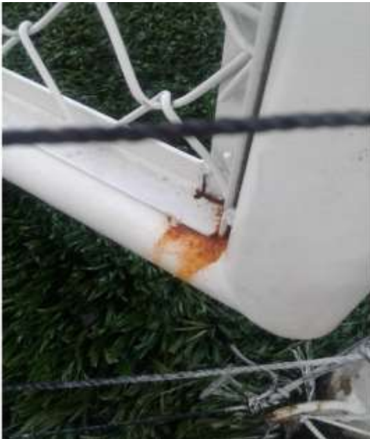
Fotografía N° 476. Oxido en la puerta de entrada
