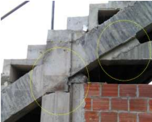
Fotografía 435 Incorrecta conformación del confinamiento en conexiones
