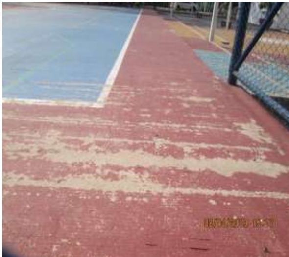
Fotografía 141. Muestra desgaste de pintura de la cancha multifuncional.
