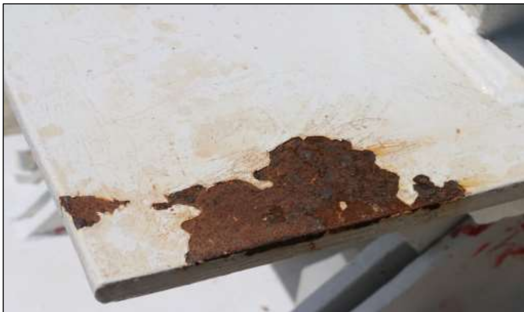
Fotografía 390 Detalle de una platina metálica, en una de las conexiones metálicas de la estructura de cubierta del polideportivo construido. En la imagen se observa la lesión ya descrita en estos elementos.
