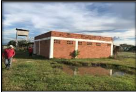
Fotografía N° 551. El pozo séptico no fue instalado correctamente, por este motivo no es funcional
