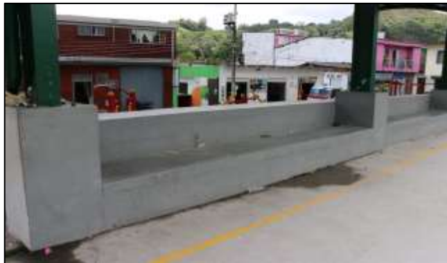
Fotografía 219. Vista general de las graderías construidas en zona intermedia del polideportivo intervenido. Esta estructura está conformada por placas de concreto apoyadas en muros de mampostería. En las placas de concreto, se evidenciaron fisuras transversales.
