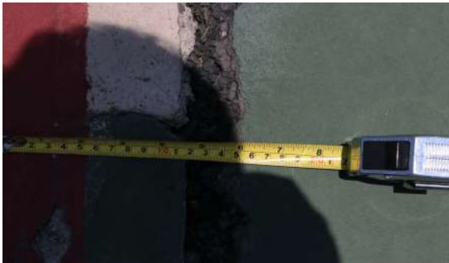
Fotografía 209. Detalle de la lesión identificada en la imagen anterior. La abertura de la grieta en algunos sitios es de 5 cm.
