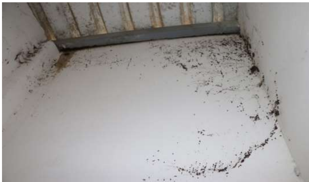
Fotografía 354 Detalle de la esquina superior de uno de los espacios adecuados, dentro del edificio administrativo. Se evidenció en esos sitios, acumulación de materia orgánica, por presencia y permanencia de animales dentro de estas instalaciones.
