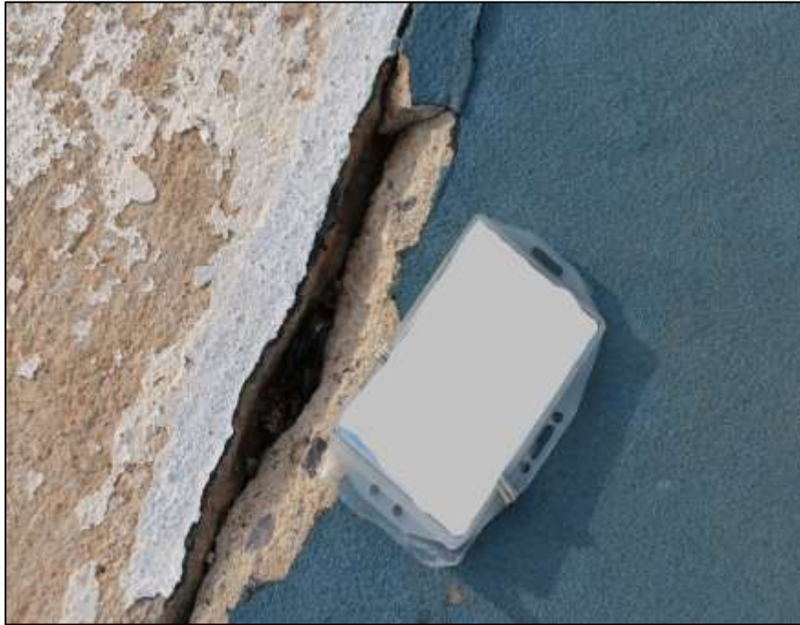
Fotografía 325 Detalle de una sección de la pista de patinaje (patinódromo). La grieta de la imagen evidencia desportillamiento y pérdida de sección parcial.
