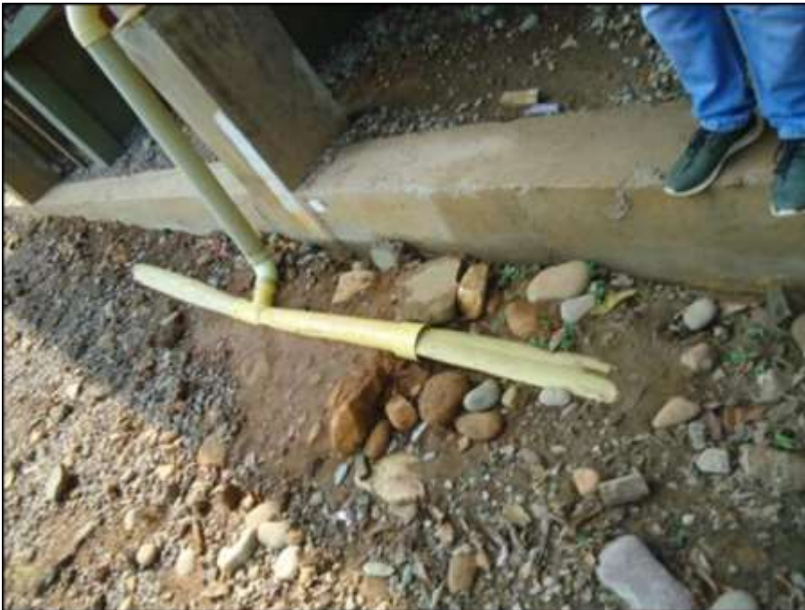
Fotografía 237. Vista general del sitio de conexión entre bajante y tubería horizontal de desagüe. En esta imagen quedó registrado el estado en el cual se encontró este sitio de la obra. La tubería de desagüe se evidenció aplastada y fuera de servicio.
