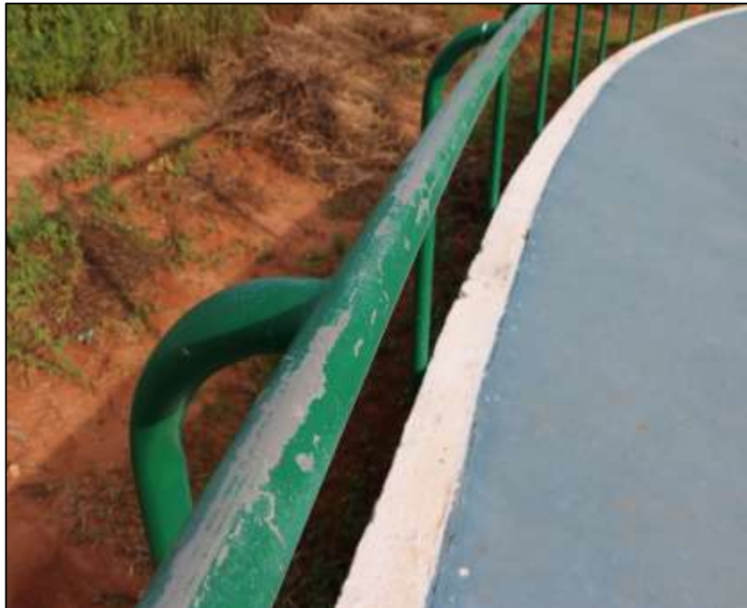
Fotografía 344 Detalle de una sección de baranda, en la parte perimetral de la pista de patinaje. En estos elementos metálicos, se evidencia pérdida parcial de la pintura de recubrimiento.
