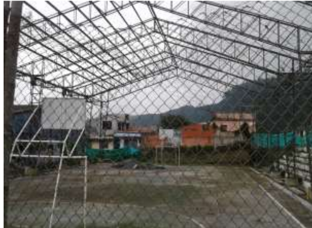
Fotografía N° 466. Estructura Polideportivo Barrio Jaramillo a la intemperie.
