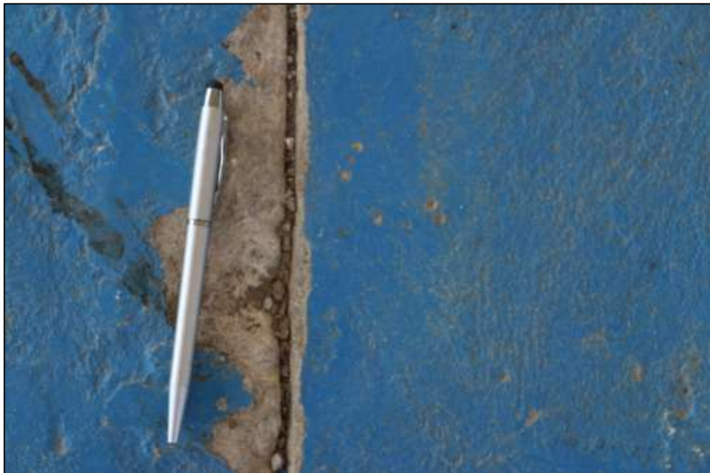
Fotografía 367 Detalle del estado de una sección de junta, en el pavimento de concreto de la cancha multideportiva (vista en planta). Las juntas constructivas, como la de la imagen, se evidenciaron abiertas, llenas de material contaminante, desportilladas y el concreto cercano, con pérdida parcial de sección.
