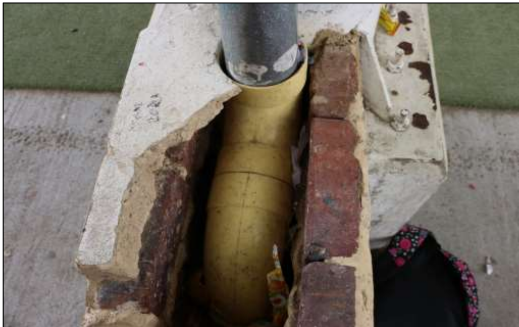
Fotografía 267. Detalle de la conexión plástica de una de las bajantes instaladas en esta estructura. Se evidencia la ejecución de una caja de mampostería, desportillada y con elementos desprendidos.
