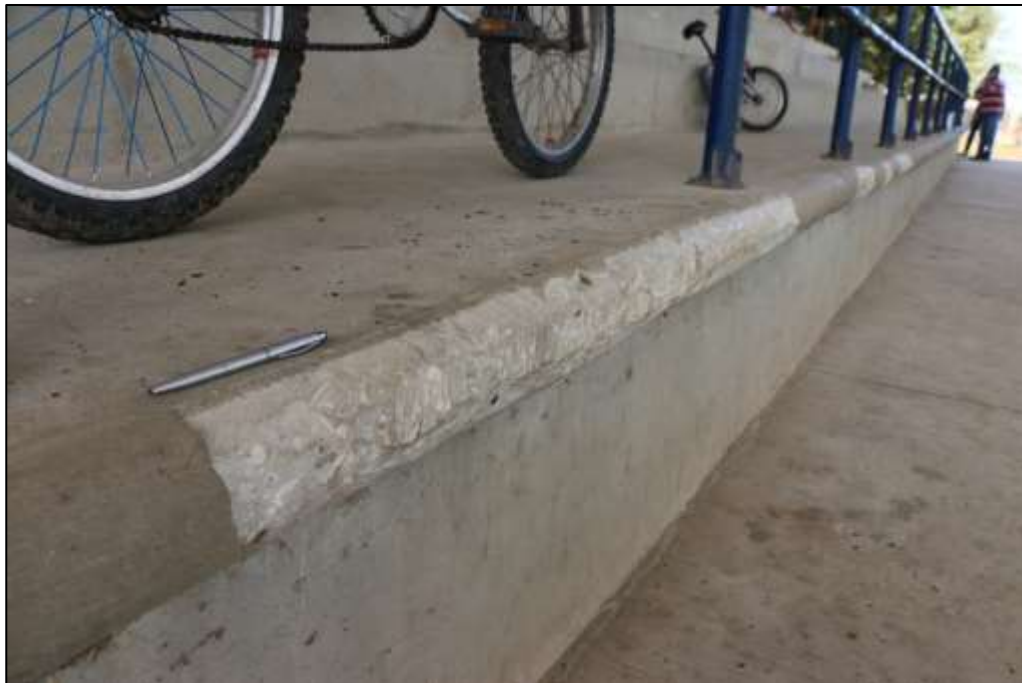
Fotografía 370 Detalle de una sección de grada (polideportivo, vista frontal). Se evidenció, en varias secciones de esta obra, el borde de las placas de concreto desportilladas y fracturadas.
