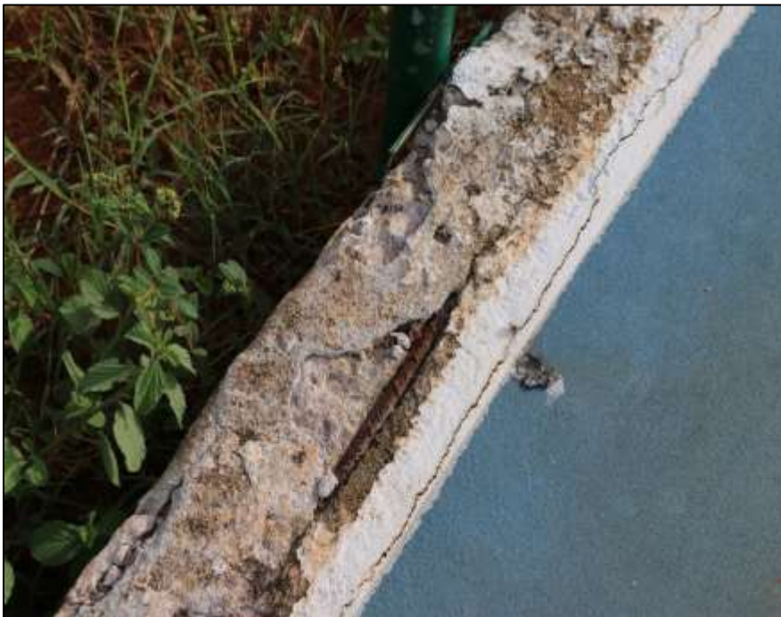
Fotografía 326 Detalle de una sección del bordillo perimetral externo, de la pista de patinaje (patinódromo). En varias secciones de esta obra, se evidenció pérdida parcial del concreto de recubrimiento, así como agregado y acero de refuerzo longitudinal a la vista. Este último ya evidencia oxidación profunda.
