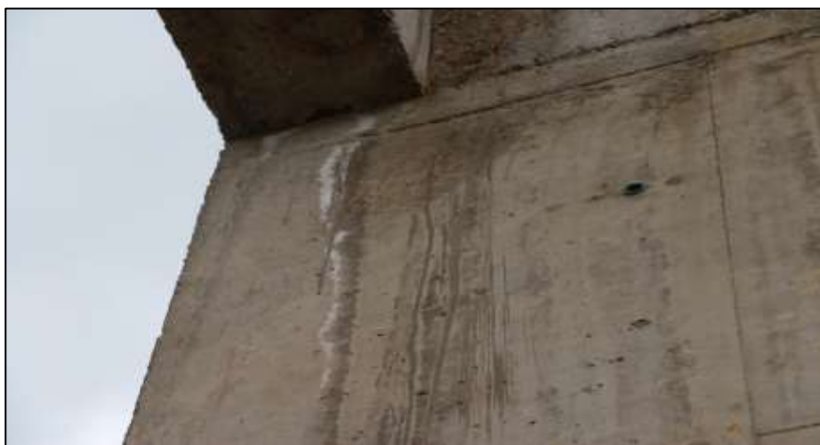
Fotografía 187. Detalle de la superficie de otra de las columnas de concreto construidas en este polideportivo. Otra de las lesiones evidenciadas es la registrada en la imagen: humedad acumulada y eflorescencia de sal.
