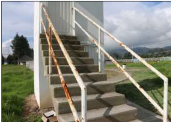
Fotografía 260. Vista general de la escalera para el ingreso a una de las casetas construidas en este escenario (costado sur). La escalera registrada en la imagen evidenció las siguientes lesiones: oxidación excesiva y pérdida parcial de pintura de recubrimiento, de la baranda metálica; discontinuidad de la placa de la escalera en el sitio de apoyo intermedio; humedad y eflorescencia de sal, bajo la placa de la escalera.
