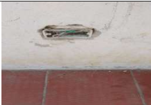
Fotografía 34 Robo de tomacorrientes
