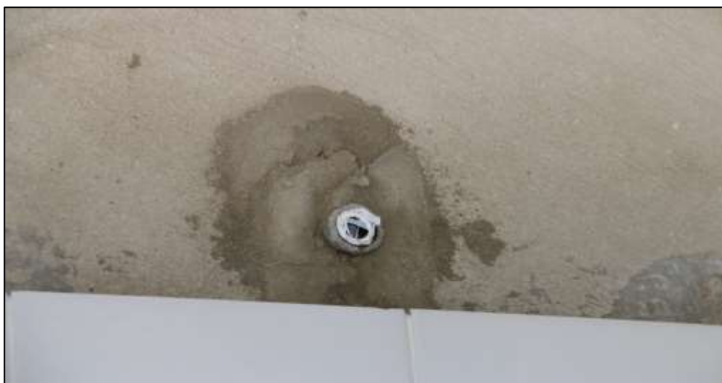
Fotografía 397 Detalle de una salida hidráulica, en una de las duchas adecuadas en este edificio. Se evidenció la ausencia del aplique (grifería) de esta salida hidráulica.
