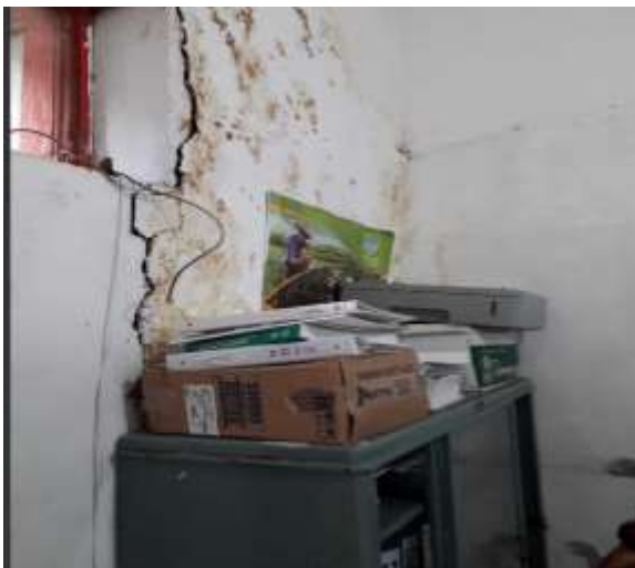
Fotografía N° 463. Espacio para disposición del archivo, pared agrietada y con humedad.
