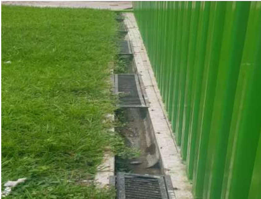
Fotografía N° 555. Concreto con capacidad insuficiente que cuando llueve rebosa su capacidad y el agua lluvia se introduce a la parte interna del Coliseo, inundando la zona de los baños. Foto tomada por El Auditor Abril de 2019.
