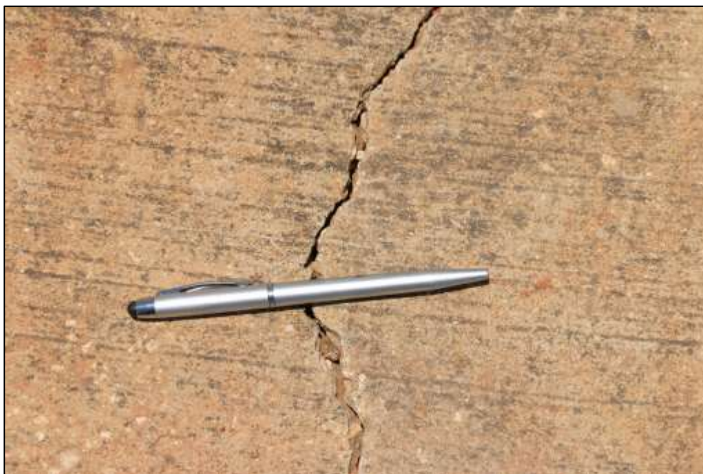
Fotografía 388 Detalle de una fisura, registrada en una sección de andén. Según la escala utilizada en la imagen (esfero de ancho 10 mm), la abertura de la lesión es aproximadamente de 5 mm.
