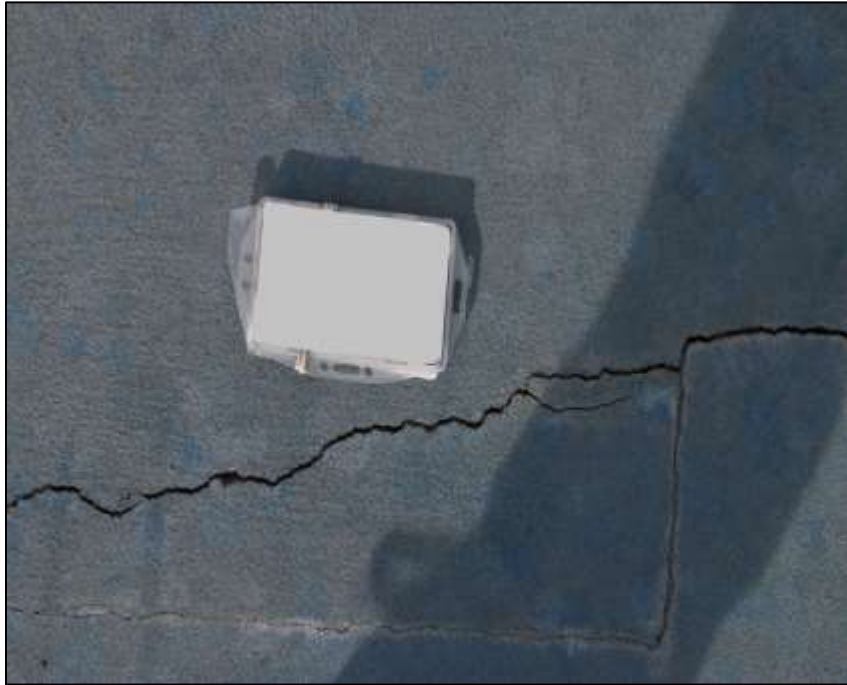
Fotografía 319 Detalle de una sección de la pista de patinaje (patinódromo). En la imagen, se registró una fisura transversal al sentido principal de circulación del escenario deportivo.
