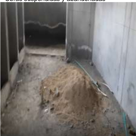
Fotografía N° 532. Humedades paredes y materiales
