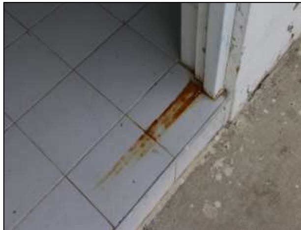
Fotografía 241. Detalle del enchape de piso en la boca puerta de uno de los baños construidos. Se evidencia el rastro del óxido escurrido de la carpintería metálica de la puerta.
