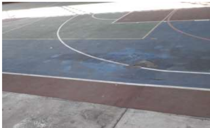
Fotografía N° 541. Recubrimiento sintético reparado (parches en azul claro) y averiado. Ubicado al lado derecho de la cancha
