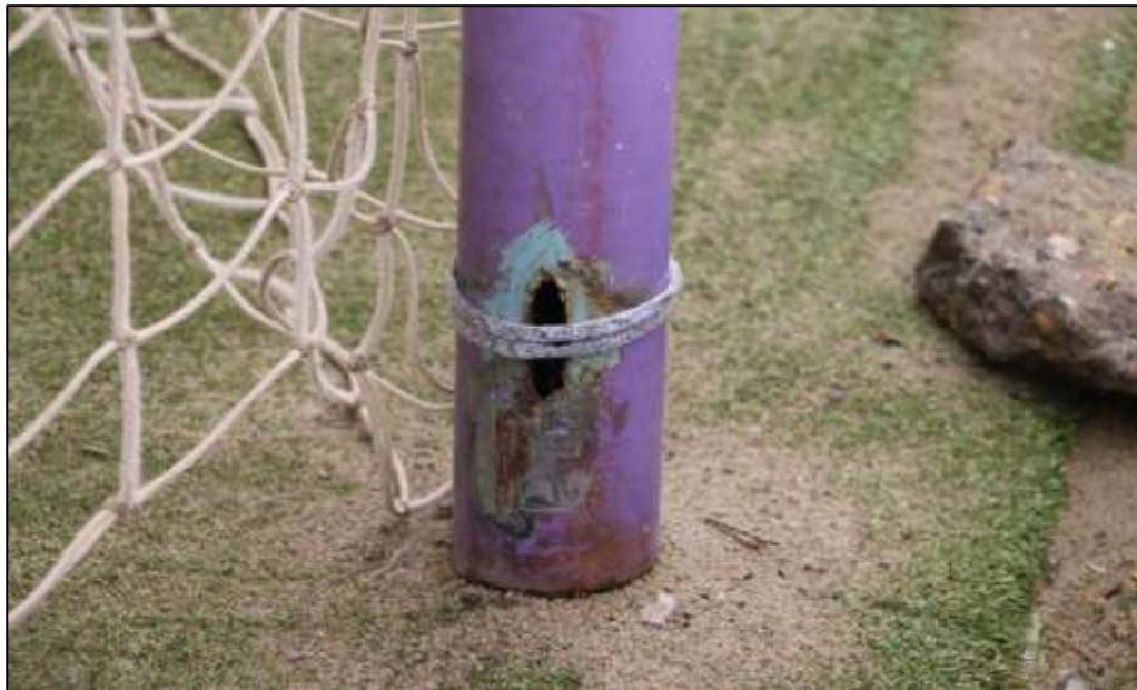
Fotografía 291. Detalle de una conexión interior entre elementos metálicos, en la estructura de uno de los arcos de fútbol. Se evidencia la misma lesión ya descrita en el polideportivo del barrio San Rafael.
