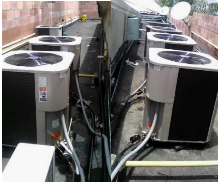
EQUIPOS NUEVOS YA INSTALADOS Y FUNCIONANDO
