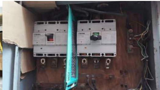
TOTALIZADOR DE 500 AMP DAÑADO
